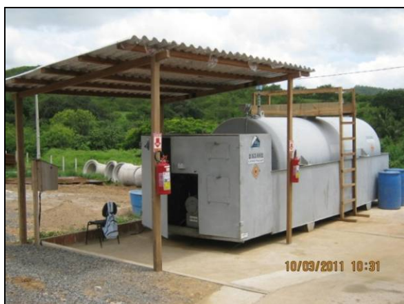
Foto 4.2.818. Posto com cobertura na área da bomba, extintores de incêndio e sinalização (mar/11).
