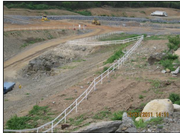
Foto 4.2.834. Guarda corpo de madeira instalado ao redor da área de escavação do desemboque do túnel Cuncas I (jan/11).
