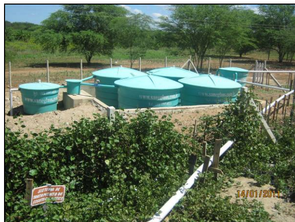
Foto 4.2.604. Manutenção do sistema de tratamento de esgoto doméstico do canteiro de obras (jan/10).
