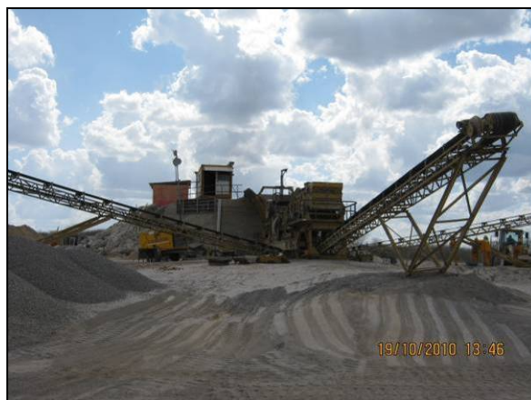
Foto 4.2.695. Central de britagem em condições apropriadas ao funcionamento no WBS 2225 (out/10).
