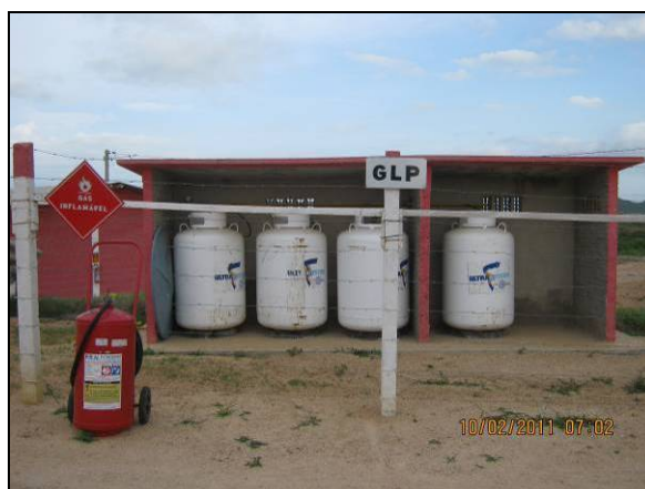
Foto 4.2.168. Extintor de incêndio na central de GLP (fev/11).
