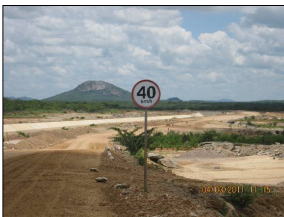
Foto 4.2.85. Sinalização em via de acesso no WBS 1209 (mar/11).
