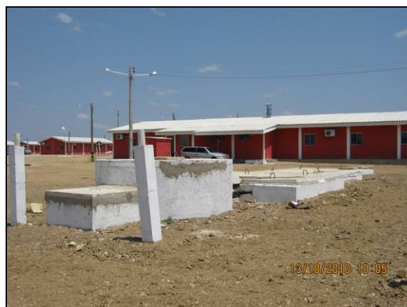
Foto 4.2.758. Sistema de tratamento de esgoto do canteiro de obras de Sertânia - PE (out/10).
