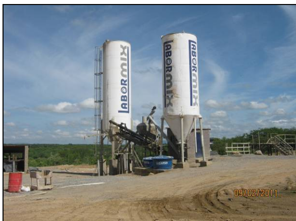
Foto 4.2.628. Central de concreto no segmento de canal WBS 2220 (fev/11).
