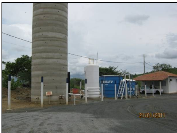
Foto 4.2.374.ETA composta de floculação e
