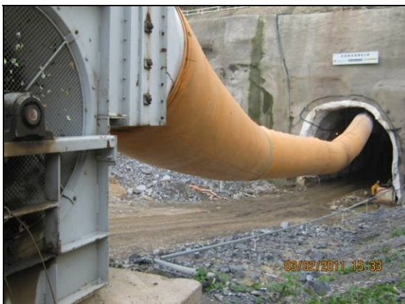
Foto 4.2.837. Equipamento de ventilação exaustora instalado no desemboque do túnel Cuncas I (fev/11).
