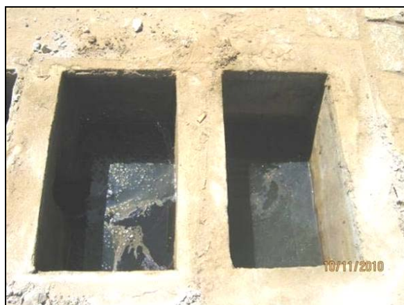
Foto 4.2.38. Sistema separador de água e óleo da oficina mecânica (nov/10).
