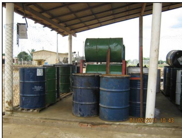
Foto 4.2.44. Área de armazenamento de óleo lubrificante com piso impermeabilizado, canaletas e direcionamento do efluente ao SAO (fev/11).
