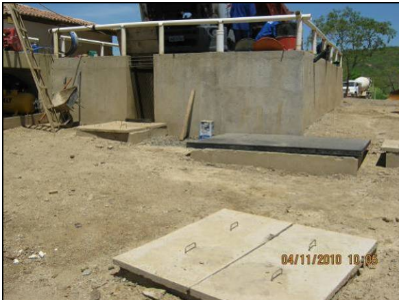
Foto 4.2.409. Vista do sistema de tratamento de efluentes do lavajato (nov/10).
