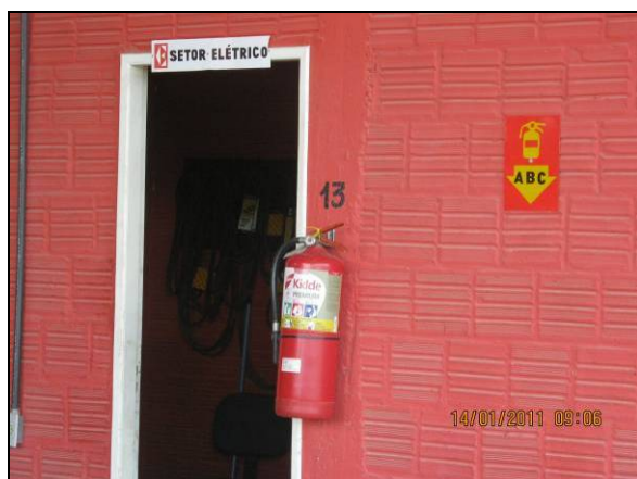
Foto 4.2.167. Extintor de incêndio disponibilizado no setor elétrico da oficina mecânica do canteiro de obras (jan/11).
