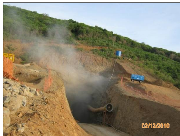
Foto 4.2.845. Material particulado proveniente da detonação na janela do túnel Cuncas I (dez/10).
