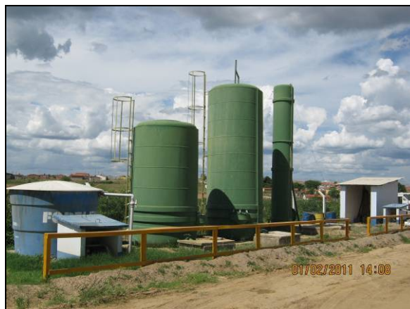
Foto 4.2.91. Estação de tratamento de efluentes em operação no canteiro de obras (fev/11).
