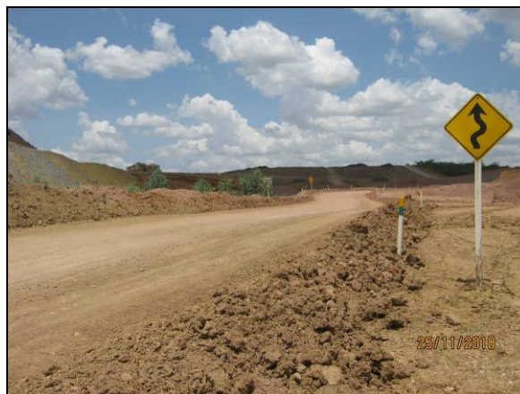
Foto 4.2.489. Sinalização de advertência instalada em local adequado no WBS 2209 (nov/10).
