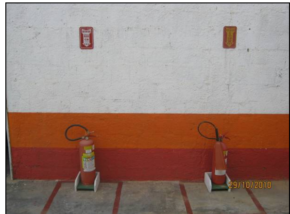
Foto 4.2.486. Extintores disponibilizados na área da oficina mecânica (out/10).
