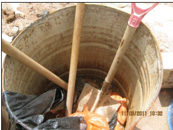
Foto 4.2.877. Pás e sacos plásticos para recolhimento de resíduo contaminado na área do emboque do túnel Cuncas I (mar/11).
