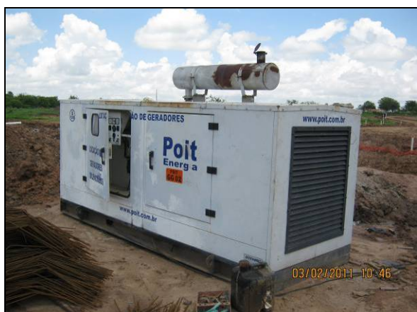
Foto 4.2.267. Gerador com bandeja interna para contenção de vazamentos no WBS 1222 (fev/11).
