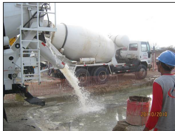
Foto 4.2.505. Lançamento de efluentes em sistema de tratamento na central de concreto no WBS 2205 (out/10).
