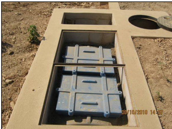
Foto 4.2.411. Sistema separador de água e óleo do posto de abastecimento (out/10).
