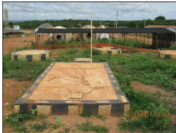
Foto 4.2.323. Sistema de tratamento de efluentes do refeitório (jan/11).
