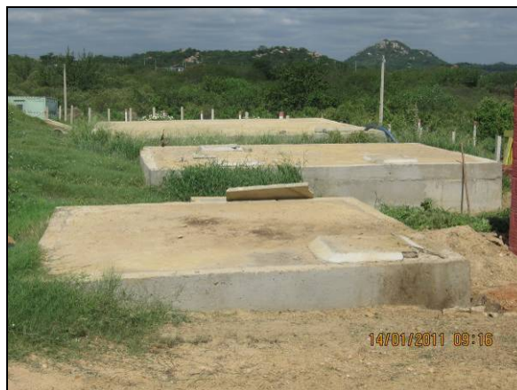
Foto 4.2.199. Vista do sistema de tratamento dos efluentes domésticos (jan/11).
