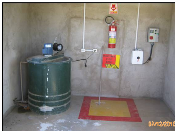
Foto 4.2.408. Dosador de cloro e sistema de operação da ETE (dez/10).
