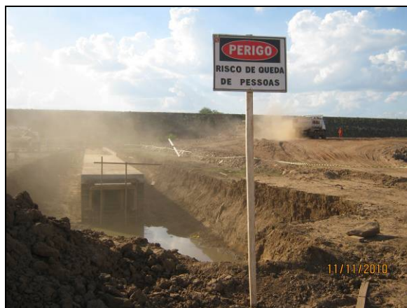
Foto 4.2.253. Placas de advertência nas proximidades do bueiro B 01, WBS 1223 (nov/10).
