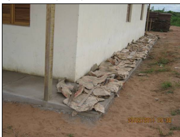
Foto 4.2.957. Aproveitamento de sacos de cimento para proteção de concreto recém aplicado (fev/11).
