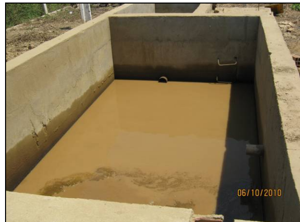
Foto 4.2.94. Caixa de retenção de areia (out/10).
