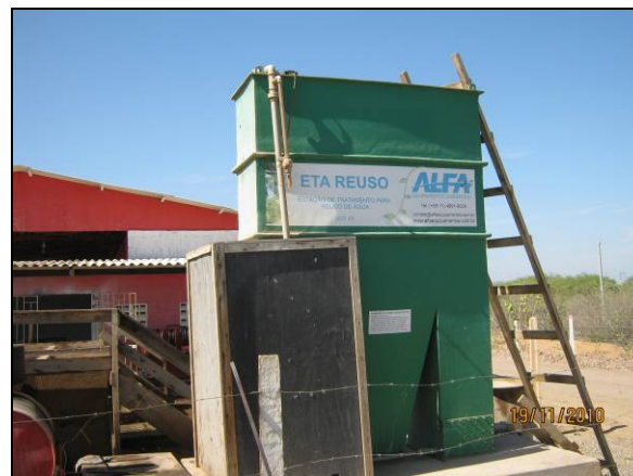
Foto 4.2.770. Estação de tratamento de água para reuso na lavagem de máquinas e veículos, no lavajato de Floresta - PE (nov/10)
