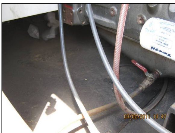
Foto 4.2.268. Bandeja interna para contenção de vazamentos em gerador no WBS 1222 (fev/11).
