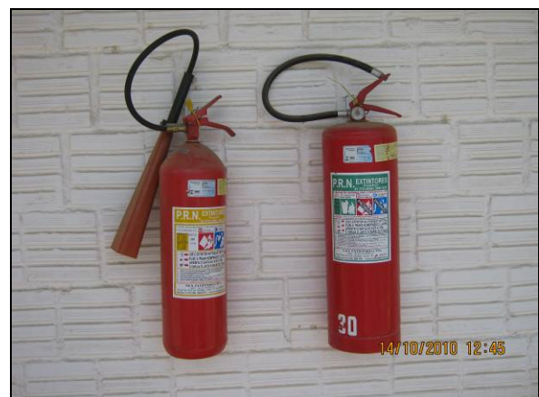
Foto 4.2.588. Extintores disponibilizados na área do canteiro de obras (out/10).
