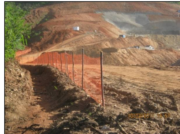
Foto 4.2.836. Tela sinalizadora em via de acesso ao espelho do desemboque do túnel Cuncas II (mar/11).
