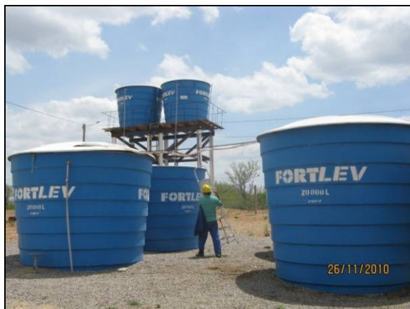
Foto 4.2.118. Reservatórios de armazenamento de água do canteiro (nov/10).
