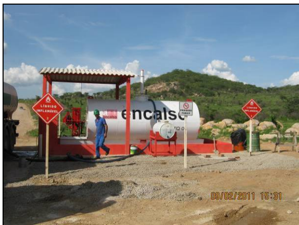
Foto 4.2.202. Posto de abastecimento com cobertura da bomba e sinalizado no WBS 1218 (fev/11).
