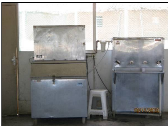
Foto 4.2.10. Disponibilização de bebedouros com água potável no refeitório (nov/10).
