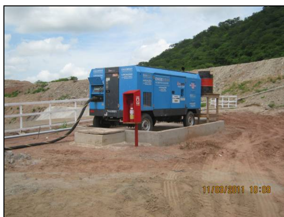
Foto 4.2.876. Grupo gerador com bandeja interna e sobre bacia de contenção com caixa coletora no emboque do túnel Cuncas I (mar/11).
