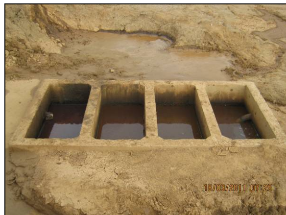
Foto 4.2.263. Sistema separador de água e óleo do lavajato (mar/11).
