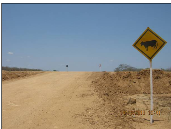
Foto 4.2.597. Sinalização de advertência sobre presença de animais na via de acesso no WBS 2222 (out/10).
