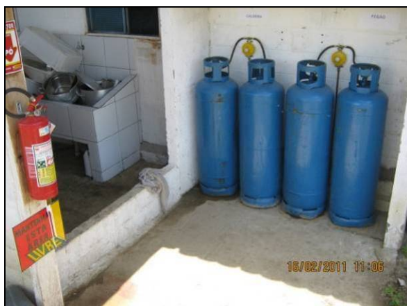
Foto 4.2.384. Extintor próximo às instalações de GLP do refeitório do canteiro (fev/11).
