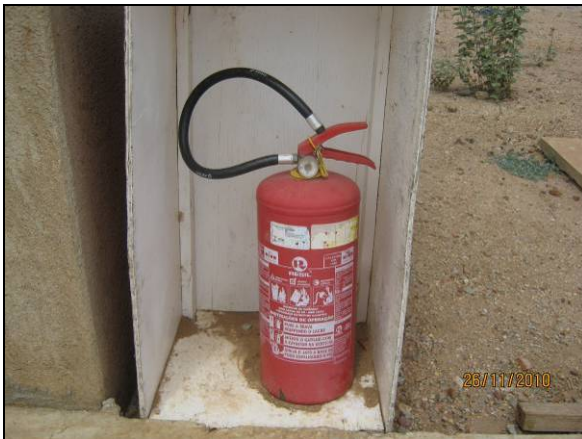
Foto 4.2.123. Extintores de incêndio no posto de abastecimento no WBS 1214 (nov/10).
