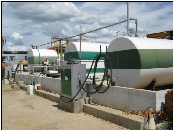
Foto 4.2.67. Tanques com bacia de contenção (fev/11).
