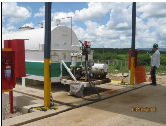
Foto 4.2.675. Canaletas de direcionamento ao SAO em torno do tanque e da pista de abastecimento (fev/11).
