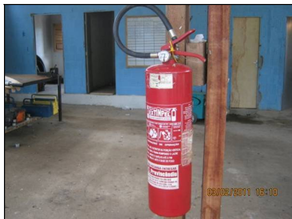
Foto 4.2.842. Extintor de incêndio na estrutura de apoio do desemboque do túnel Cuncas I (fev/11).
