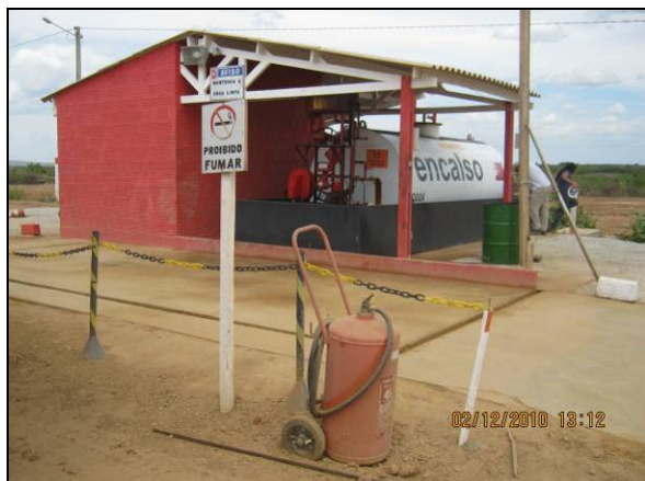
Foto 4.2.237. Posto de abastecimento coberto, com bacia de contenção de vazamentos, extintor de incêndio e sinalizado (dez/10).
