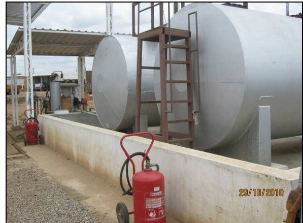
Foto 4.2.468. Tanques de combustíveis instalados em bacia de contenção (out/10).
