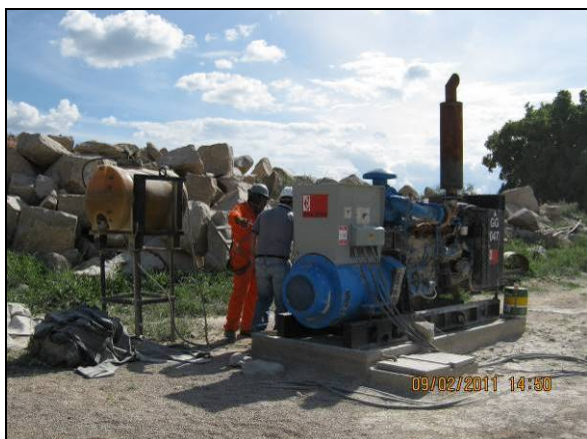
Foto 4.2.200. Grupo gerador sobre a bacia de contenção (fev/11).
