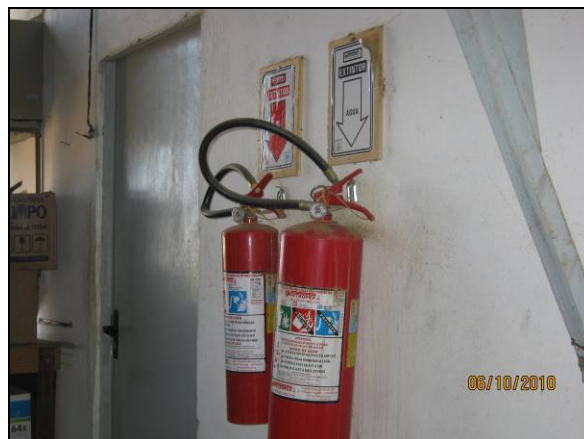
Foto 4.2.75. Extintores de incêndio na oficina do canteiro (out/10).
