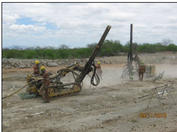
Foto 4.2.539. Perfuração para colocação de explosivos com o uso da perfuratriz no WBS 2213 (nov/10).
