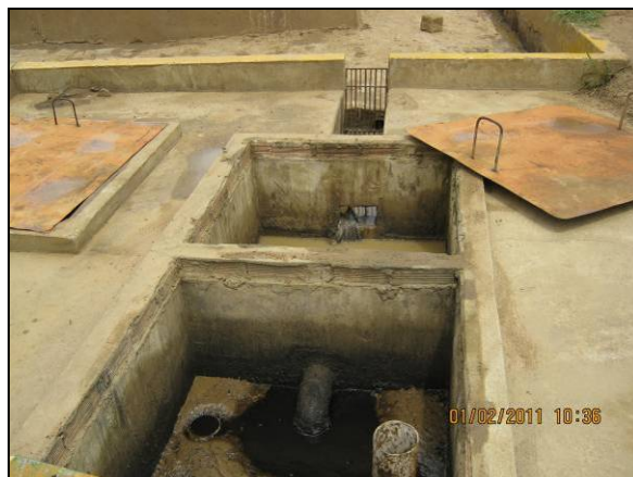
Foto 4.2.36. Sistema de separação água e óleo do lavajato (fev/11).
