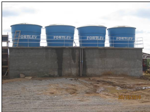
Foto 4.2.230. Reservatório de água do canteiro de obras (out/10).
