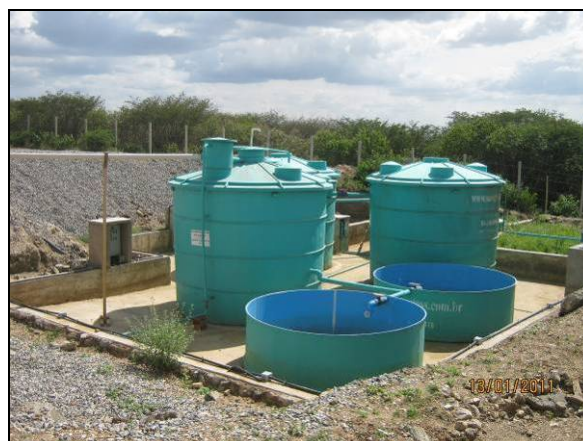
Foto 4.2.672. Estação de tratamento de esgoto doméstico (jan/11).
