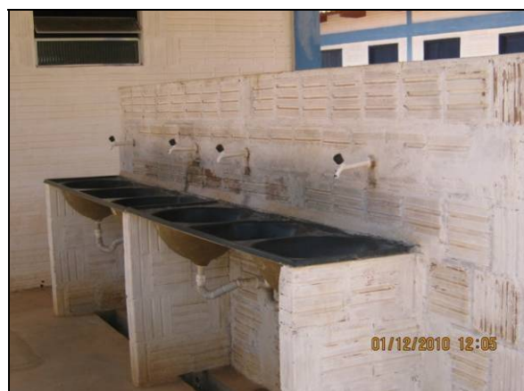
Foto 4.2.289. Lavanderia do alojamento (dez/10).
