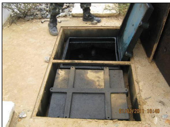
Foto 4.2.37. Separador de água e óleo do posto de combustível (fev/11).
