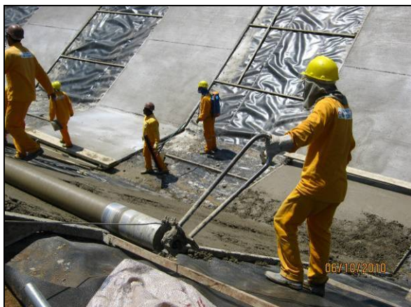
Foto 4.2.589. Colaboradores utilizando EPI em atividade de concretagem de canal no WBS 2218 (out/10).
