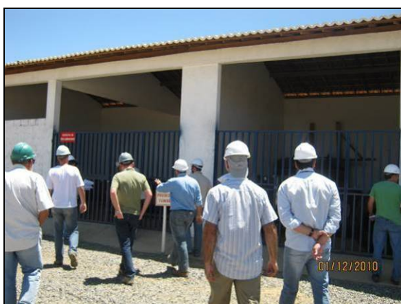
Foto 4.1.9. Equipes do IBAMA, MI e CMT em vistoria no canteiro do Lote 07 (dez/10).
