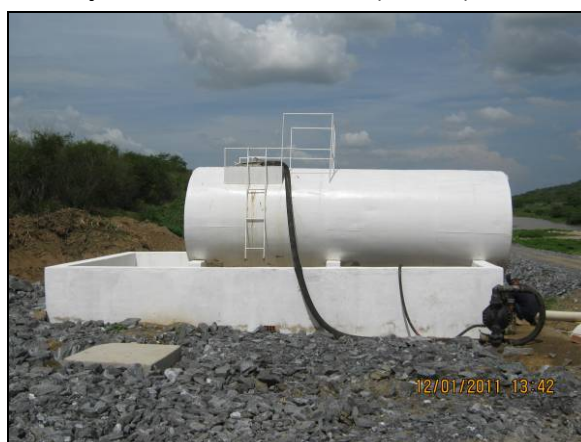
Foto 4.2.849. Tanque de armazenamento de nitrato e nitrito com bacia de contenção (jan/11).
