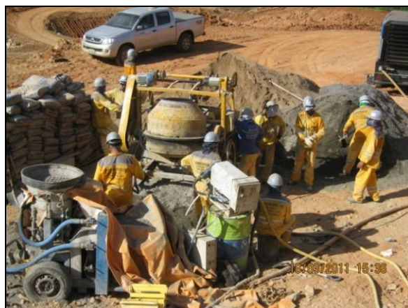
Foto 4.2.832. Colaboradores com os EPI adequados em atividade no desemboque do túnel Cuncas II (mar/11).
