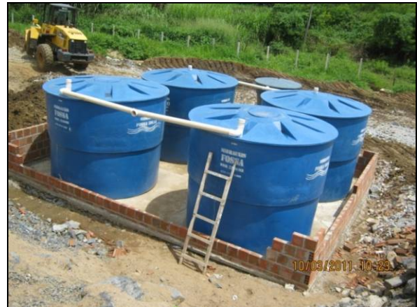
Foto 4.2.861. Equipamentos que compõem a ETE (mar/11).
