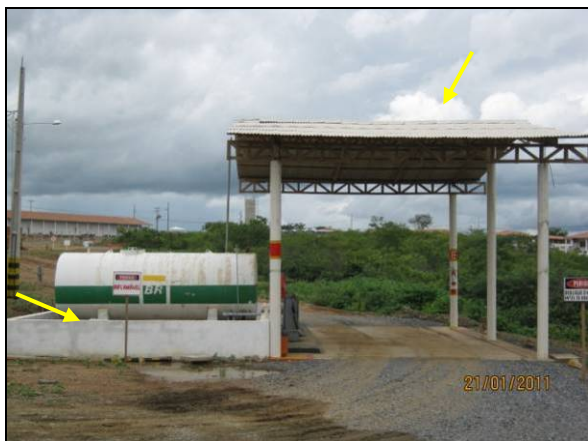
Foto 4.2.366. Posto de combustível com bacia de contenção e pista de abastecimento coberta (jan/11).
