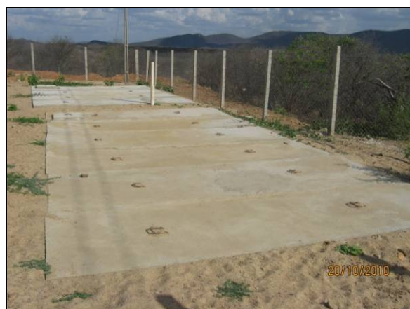
Foto 4.2.132. Sistema de tratamento de efluentes do canteiro de apoio (nov/10).
