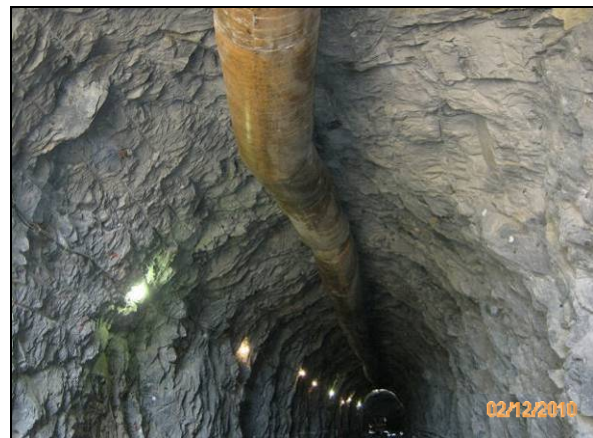
Foto 4.2.838. Tubulação para o direcionamento de ar dentro da janela do túnel Cuncas I (dez/10).
