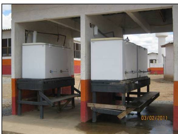
Foto 4.2.479. Bebedouros disponibilizados aos colaboradores na área do canteiro de obras (fev/11).
