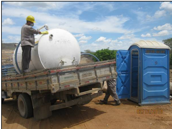
Foto 4.2.673. Empresa realizando coleta de efluentes de banheiro químico no WBS 2226 (dez/10).
