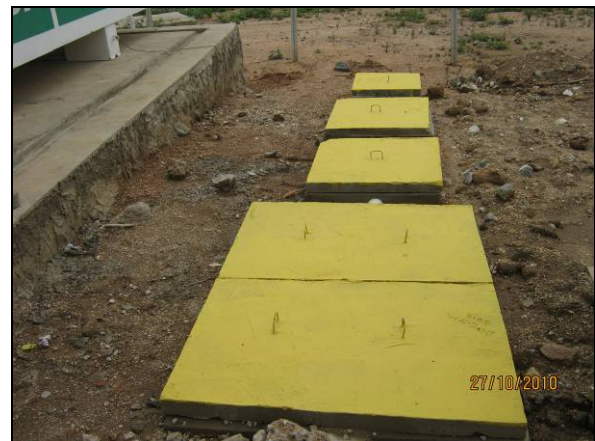
Foto 4.2.676. Sistema separador de água e óleo do posto de abastecimento (out/10).
