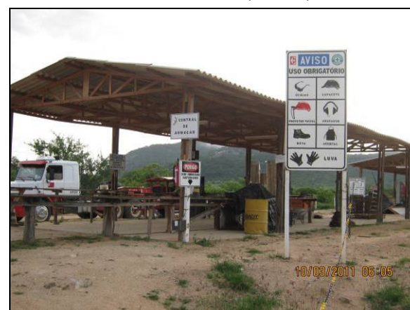
Foto 4.2.180. Placa de sinalização quanto ao uso de EPI no canteiro de obras (mar/11).
