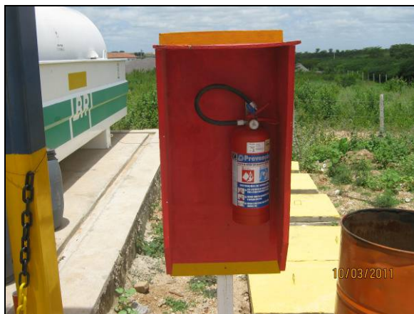
Foto 4.2.654. Extintor disponibilizado na área do posto de abastecimento (mar/10).
