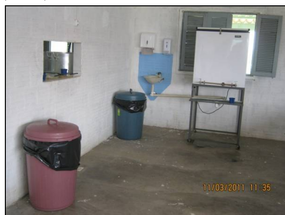
Foto 4.2.884. Bebedouro limpo, lavatório e coletores de resíduos no refeitório (mar/11).
