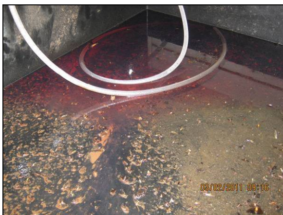
Foto 4.2.270. Bandeja interna de contenção de vazamentos no WBS 1223 (fev/11).
