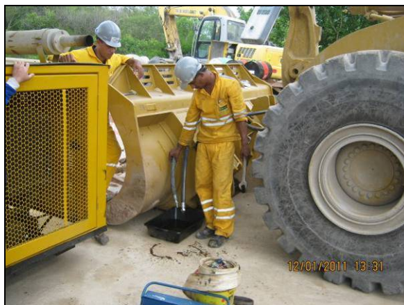
Foto 4.2.878. Bandeja de contenção utilizada na manutenção de máquinas no desemboque do túnel Cuncas I (jan/11).
