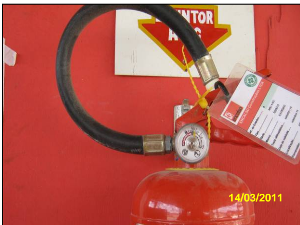
Foto 4.2.743. Extintor de incêndio instalado na oficina do canteiro de obras de Floresta - PE (mar/11).
