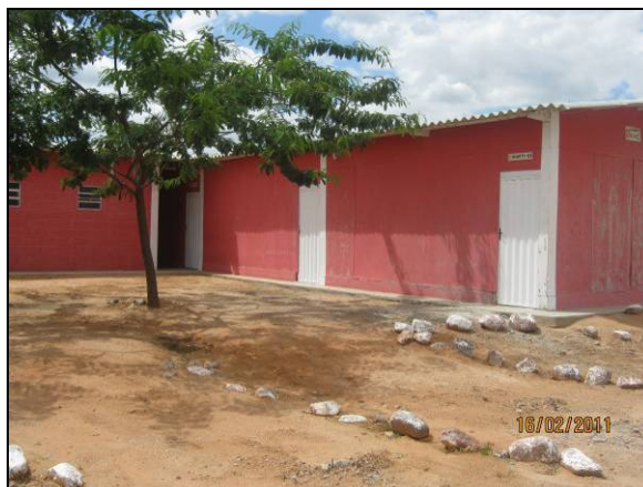
Foto 4.2.710. Vista parcial dos alojamentos no canteiro de obras de Sertânia - PE (fev/11).
