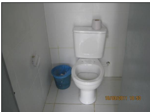
Foto 4.2.814. Banheiro para uso dos colaboradores do refeitório (mar/11).
