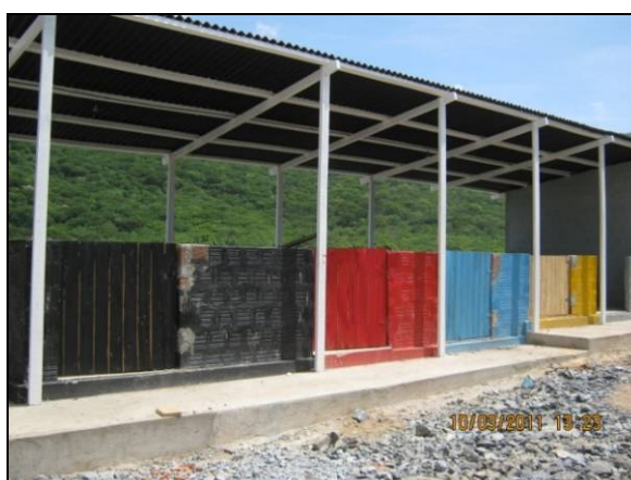
Foto 4.2.870.Baia de resíduos no desemboque do túnel Cuncas I (mar/11).
