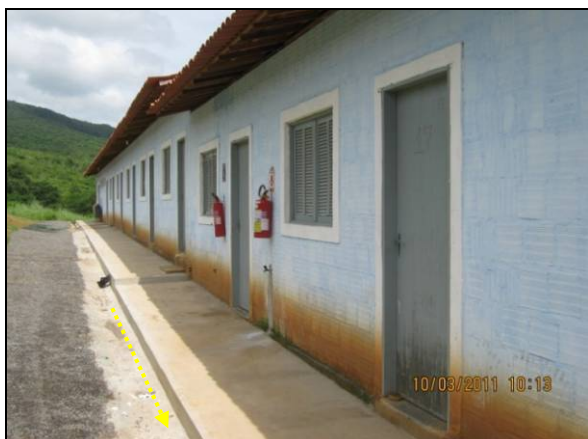
Foto 4.2.810. Área externa do alojamento, com dispositivo de drenagem e itens de segurança (mar/11).
