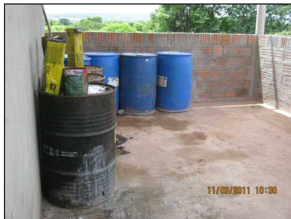
Foto 4.2.872. Construção de baia específica para resíduos perigosos na área do desmatamento do túnel Cuncas I (mar/11).
