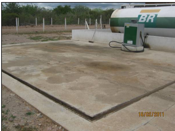
Foto 4.2.763. Canaletas de direcionamento e efluentes ao SAO do posto de abastecimento em Floresta - PE (fev/11).
