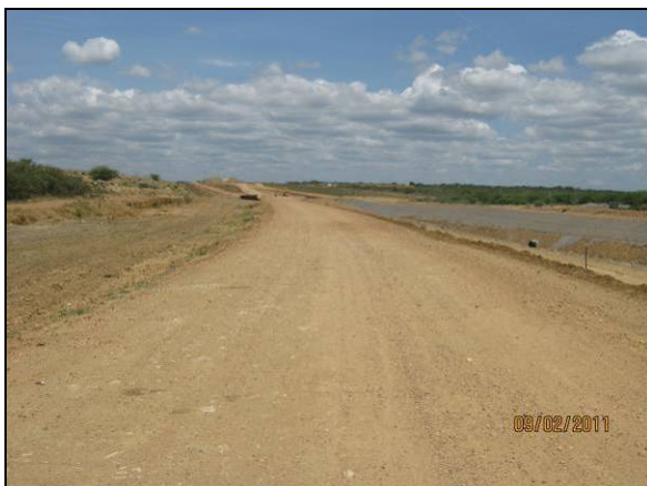
Foto 4.2.1. Via de acesso do Canal de Aproximação bem dimensionada e conservada (fev/11).
