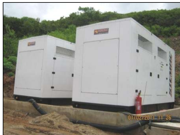
Foto 4.2.875. Grupos geradores com bacia de contenção e caixa coletora na janela do túnel Cuncas I (fev/11).
