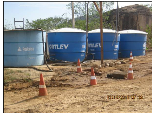
Foto 4.2.155. Reservatórios para armazenamento de água (dez/10).
