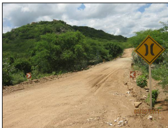
Foto 4.2.662. Sinalização de advertência no WBS 2114 (fev/11).
