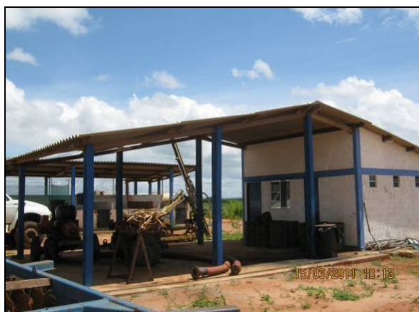
Foto 4.2.338. Área para armazenamento de óleo usado coberta, com canaletas de drenagem e piso impermeabilizado (mar/11).
