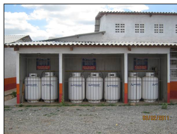
Foto 4.2.480. Botijões de gás GLP armazenados em local adequado (fev/11).
