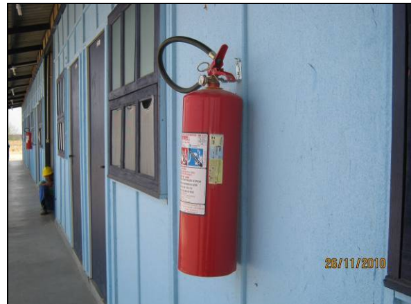
Foto 4.2.124. Extintores de incêndio na área do alojamento do canteiro (nov/10).
