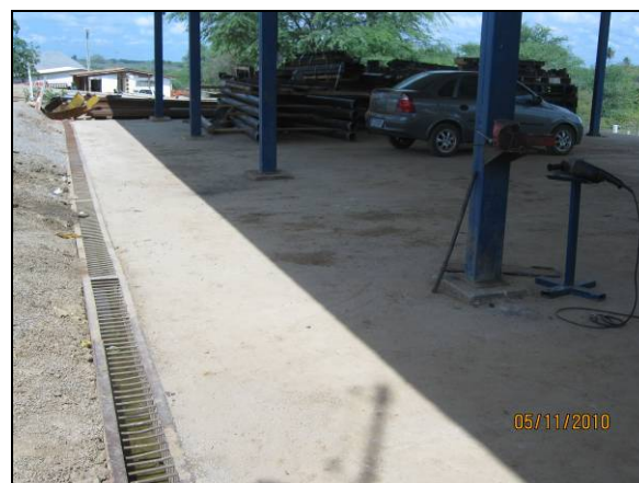
Foto 4.2.608. Canaletas de direcionamento de efluentes ao SAO da oficina mecânica (nov/10).
