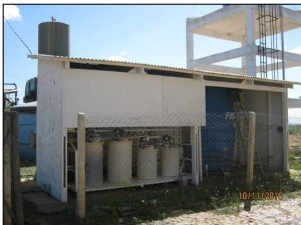
Foto 4.2.12. ETA com vista dos dosadores de cloro (nov/10)
