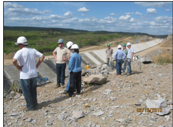
Foto 4.1.20. Vistoria no segmento de canal WBS 2224, Lote 12 (dez/10).
