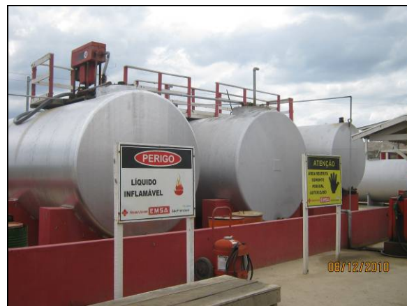
Foto 4.2.529. Tanques no interior de bacia de contenção, extintor de incêndio e sinalização adequada (dez/10).
