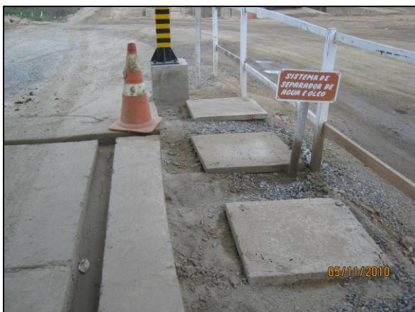
Foto 4.2.605. Canaletas de direcionamento e SAO do posto de abastecimento (nov/10).
