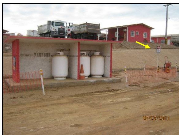
Foto 4.2.247. Central de GLP (fev/11).
