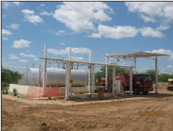
Foto 4.2.467. Vista parcial do posto de abastecimento (fev/10).
