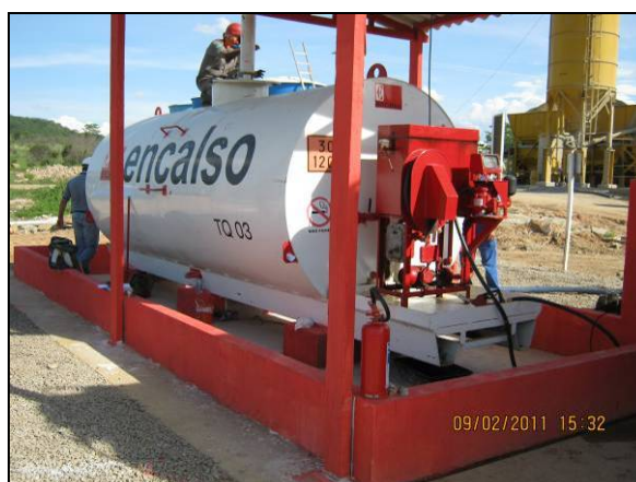
Foto 4.2.204. Bacia de contenção e extintor no posto de abastecimento, WBS 1218 (fev/11).
