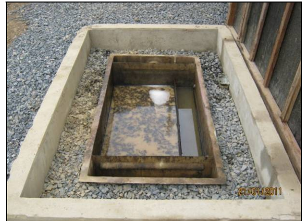
Foto 4.2.410. Separador de água e óleo do lavajato (jan/11).
