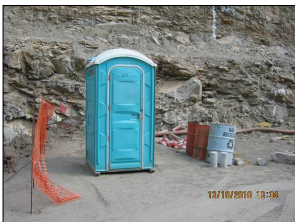
Foto 4.2.791. Banheiro químico disponibilizado na EBV-6 (out/10).
