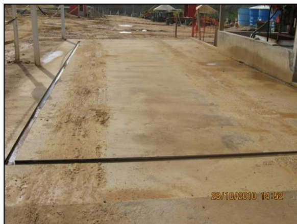
Foto 4.2.159. Pista de abastecimento impermeabilizada e com canaletas (out/10).
