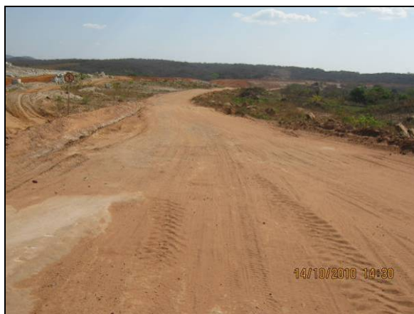
Foto 4.2.282. Via de acesso em condições de trafegabilidade no segmento de canal WBS 1229 (out/10).
