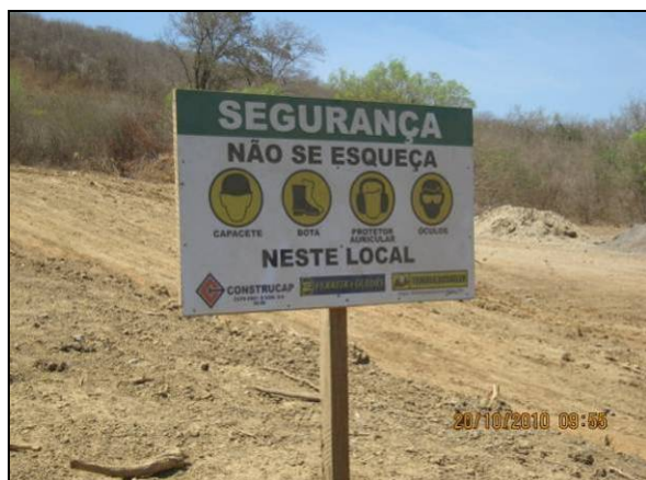
Foto 4.2.856. Placa orientando sobre o uso de EPI na janela do túnel Cuncas I (out/10)
