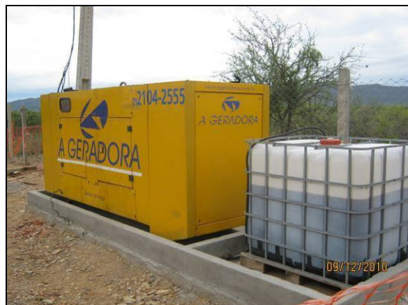
Foto 4.2.139. Grupo gerador e tanque de óleo diesel sobre a bacia de contenção (dez/10).
