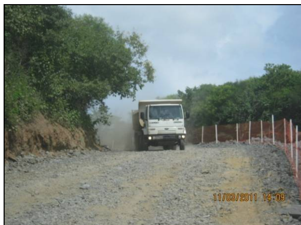
Foto 4.2.859. Veículo transitando com faróis ligados em via de acesso à janela do túnel Cuncas I (mar/11).
