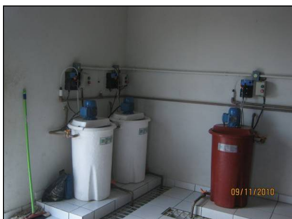
Foto 4.2.526. Equipamentos da ETA para floculação e desinfecção (nov/10).
