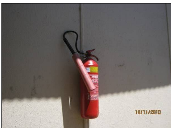
Foto 4.2.21. Disponibilização de extintor de incêndio no alojamento do canteiro de obras (nov/10).
