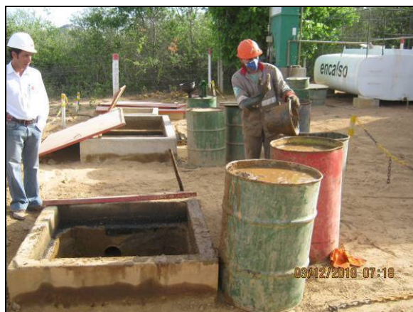
Foto 4.2.194. Manutenção adequada do SAO da rampa de lavagem (dez/10).
