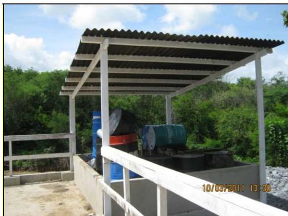
Foto 4.2.871. Local de armazenamento de óleo coberto e ligado a SAO na área do desmatamento do túnel Cuncas I (mar/11).
