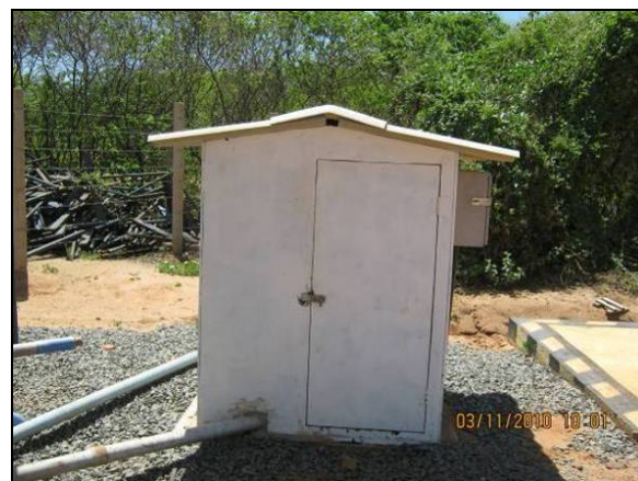
Foto 4.2.294. Casa de bomba de sucção e dosador de cloro devidamente protegidas (nov/10).
