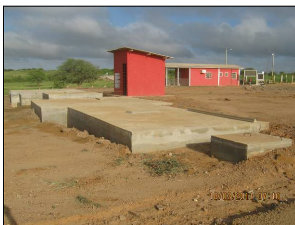
Foto 4.2.264. Sistema anaeróbio de tratamento de efluentes (mar/11).
