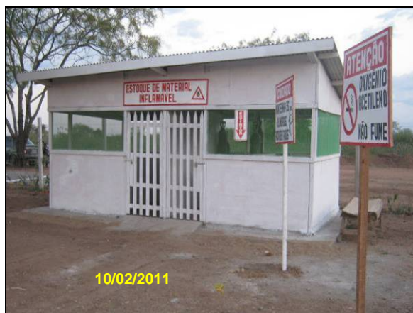
Foto 4.2.646. Instalações para acondicionamento de material inflamável (fev/11).
