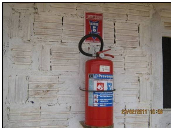
Foto 4.2.934. Extintor de pó químico com manutenção adequada usado para incêndios de classe B e C (fev/11).
