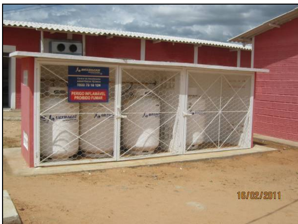
Foto 4.2.727.Acondicionamento adequado de botijões de gás (GLP) no canteiro de Floresta - PE (fev/11).
