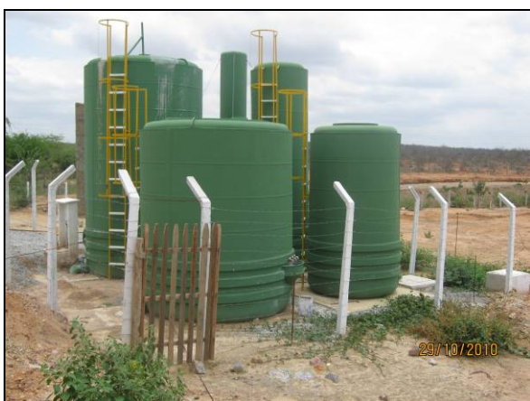
Foto 4.2.494. Estação de tratamento de esgoto do canteiro de obras (out/10).
