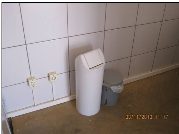
Foto 4.2.336. Coletores diferenciados para resíduos comuns e de serviço de saúde em condições adequadas (nov/10).
