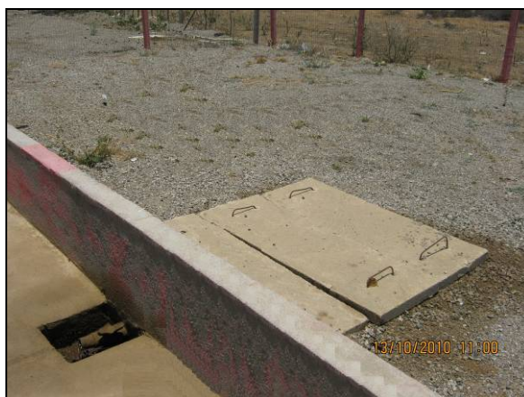
Foto 4.2.766. SAO do posto de abastecimento de Sertânia - PE (out/10).
