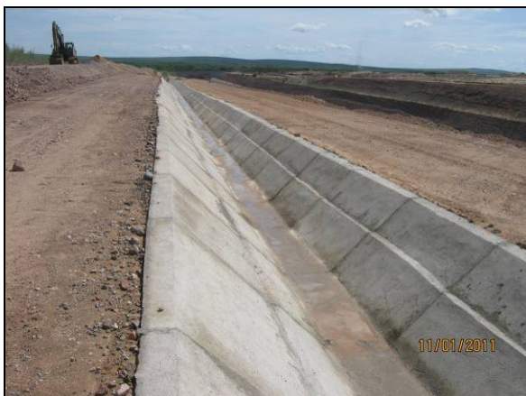
Foto 4.2.460. Construção de canaleta para o escoamento de águas pluviais no WBS 2204 (jan/11).
