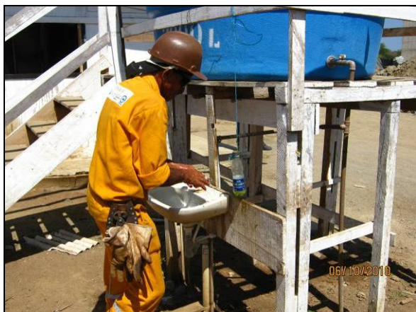
Foto 4.2.620. Colaborador utilizando lavabo no ponto de apoio do Aqueduto Branco, WBS 2307 (out/10).
