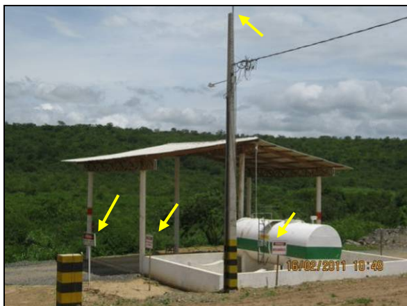
Foto 4.2.367. Pára-raios e placas de sinalização (fev/11).
