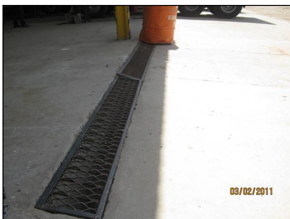
Foto 4.2.498. Canaletas de direcionamento de efluentes ao SAO da oficina mecânica (fev/11).
