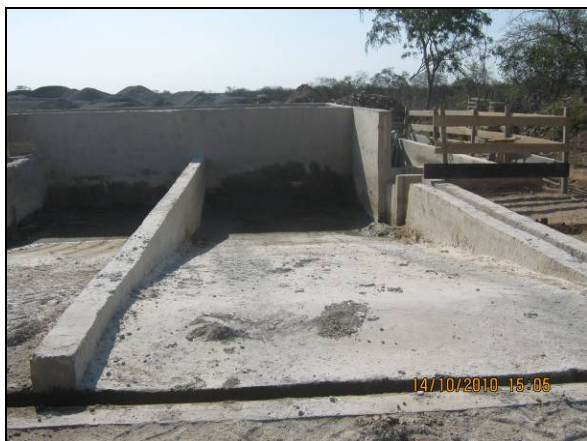
Foto 4.2.137. Sistema de tratamento de efluentes da central de concreto (out/10).
