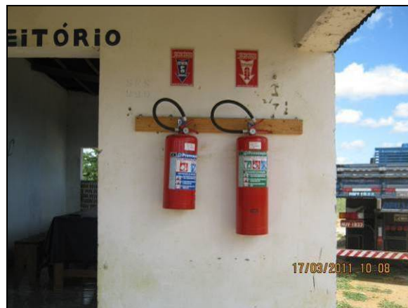
Foto 4.2.900. Extintores de incêndio com manutenção adequada (mar/11).
