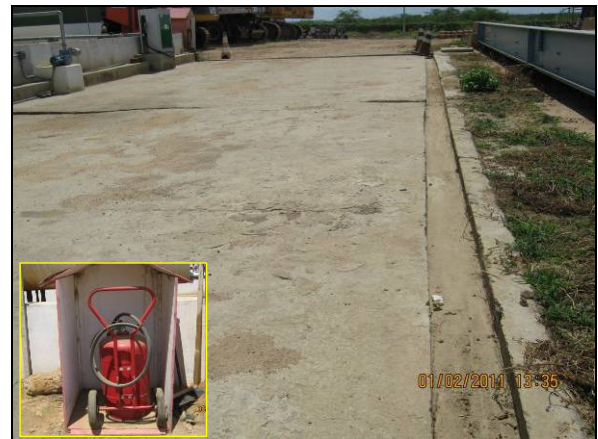
Foto 4.2.68. Canaletas, piso impermeabilizado e extintor de incêndio (fev/11).
