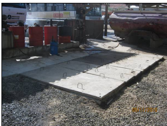
Foto 4.2.553. SAO do lavajato em boas condições (nov/10).
