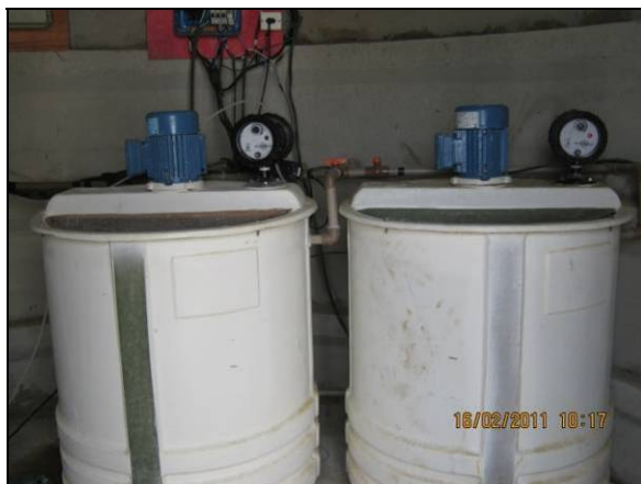
Foto 4.2.375.Equipamentos dosadores de sulfato de alumínio e cloro (fev/11).
