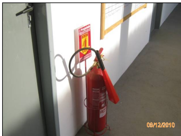
Foto 4.2.840. Extintor de incêndio na parte interna do escritório do consórcio construtor (dez/10).
