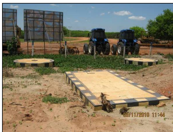
Foto 4.2.322. Fossa séptica e sumidouros que recebem os efluentes provenientes dos alojamentos (nov/10).
