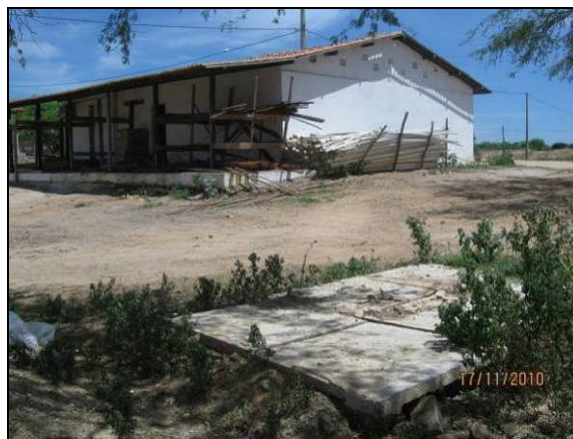
Foto 4.2.971. Vista da fossa séptica receptora dos efluentes sanitários do escritório da CRO-7 (nov/10).
