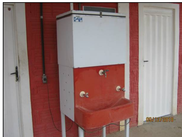
Foto 4.2.716. Bebedouro com água potável refrigerada no canteiro de obras de Floresta - PE (dez/10).
