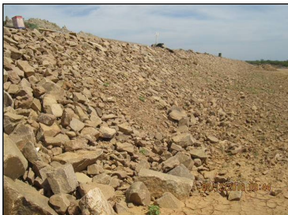
Foto 4.2.220. Implantação de enrocamento como medida de proteção do talude no WBS 1219 (dez/10).
