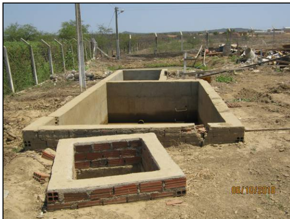
Foto 4.2.93. Sistema de tratamento dos efluentes oleosos (out/10).
