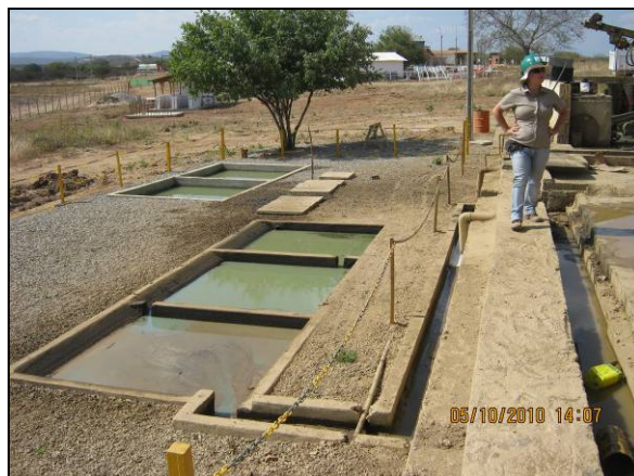
Foto 4.2.677. Sistema de tratamento de efluentes provenientes do lavajato (out/10).
