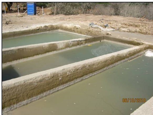
Foto 4.2.619. Tanques de sedimentação do sistema de tratamento na central de concreto no WBS 2205 (out/10).
