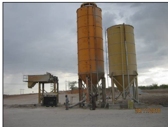
Foto 4.2.513. Central de concreto localizada no WBS 2205 (nov/10).
