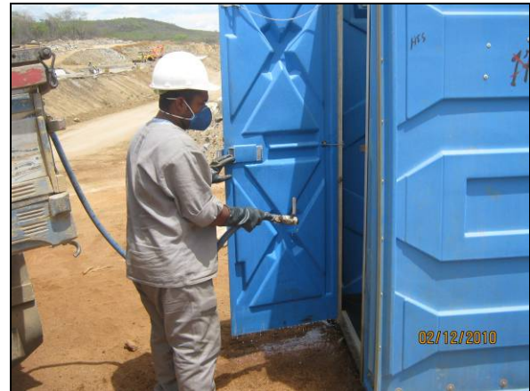
Foto 4.2.674. Técnico realizando a limpeza de banheiro químico no WBS 2226, após a coleta dos efluentes (dez/10).
