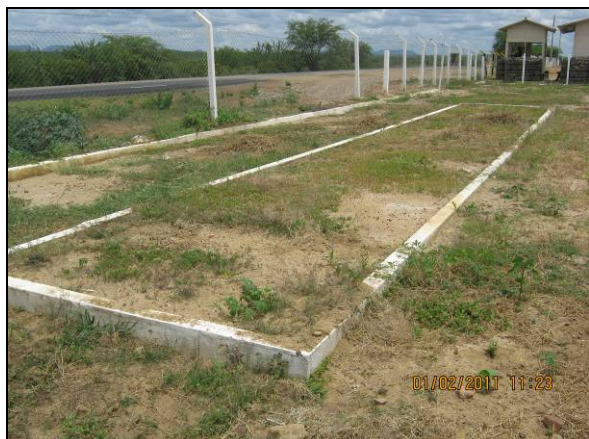
Foto 4.2.35. Sistema de tratamento composto por fossas sépticas e filtros anaeróbios (fev/11).
