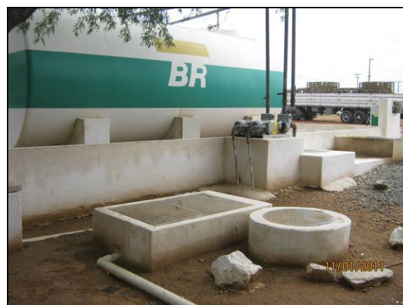
Foto 4.2.455. SAO do posto de abastecimento em boas condições de manutenção (jan/11).
