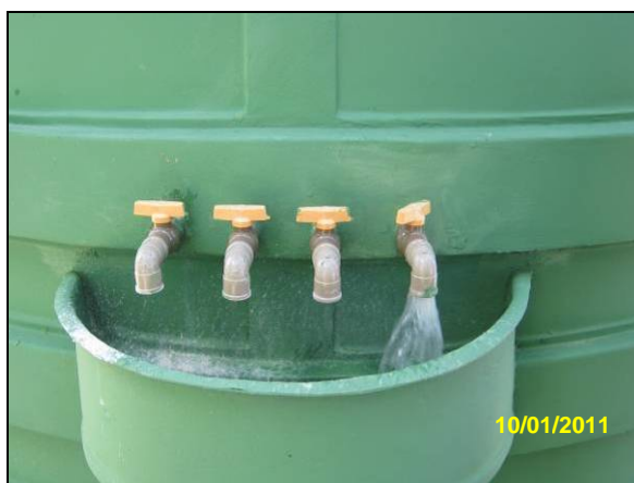
Foto 4.2.495. Local da ETE para monitoramento da qualidade dos efluentes (jan/11).
