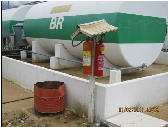
Foto 4.2.16. Bacia de contenção, coletor de resíduos e extintores de incêndio (fev/11).
