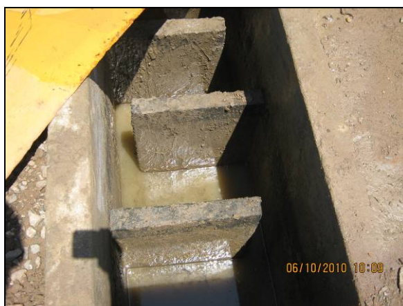
Foto 4.2.452. Sistema separador de água e óleo do lavajato em bom estado de manutenção (out/10).
