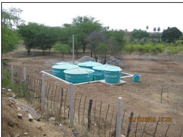
Foto 4.2.603. Instalação da estação de tratamento de esgoto do canteiro de obras (out/10).
