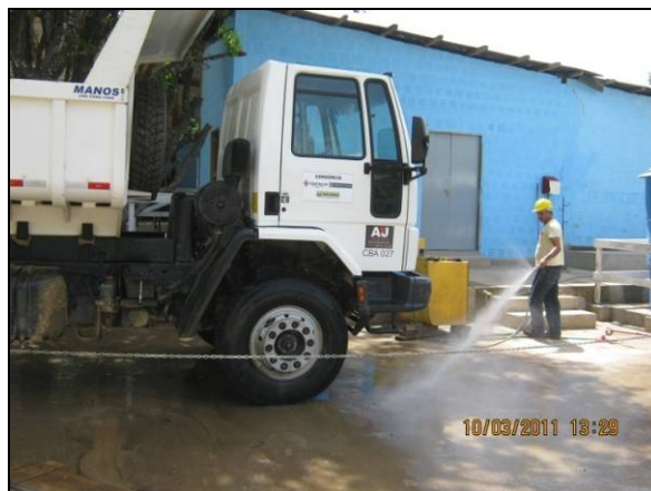
Foto 4.2.863. Lavajato em operação no desemboque do túnel Cuncas I, com área impermeabilizada, mureta de contenção e canaletas (mar/11).
