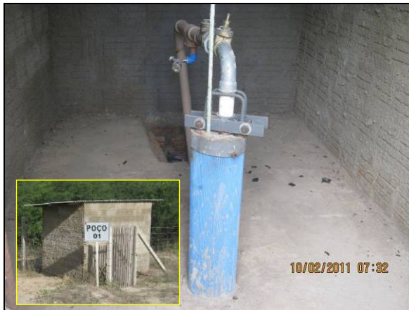
Foto 4.2.154. Poço tubular profundo em estrutura de proteção, com piso impermeabilizado e vedado (fev/11).
