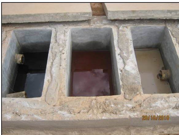
Foto 4.2.262. Sistema separador de água e óleo do posto de combustível (out/10).
