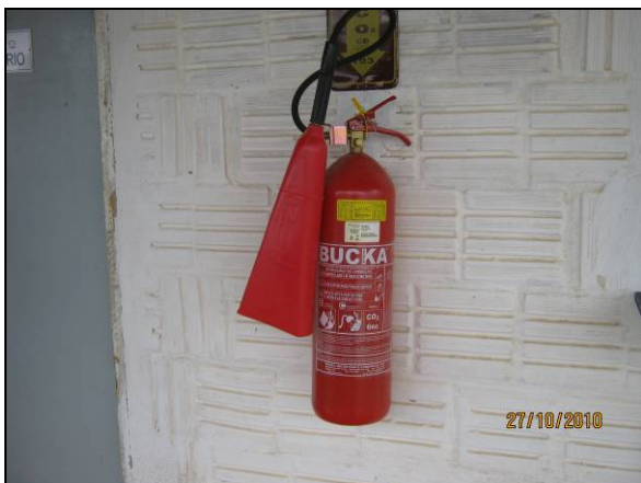
Foto 4.2.653. Extintor disponibilizado na área do ambulatório (out/10).
