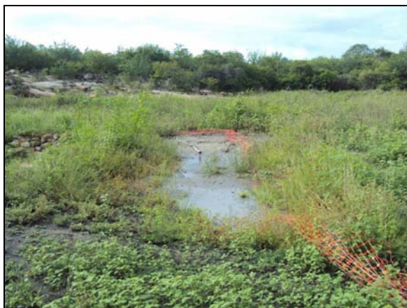
Foto 4.6.13. Local da escavação alagado. Fevereiro de 2011. Sítio Lagoa Uri de Cima – Lote 03.
