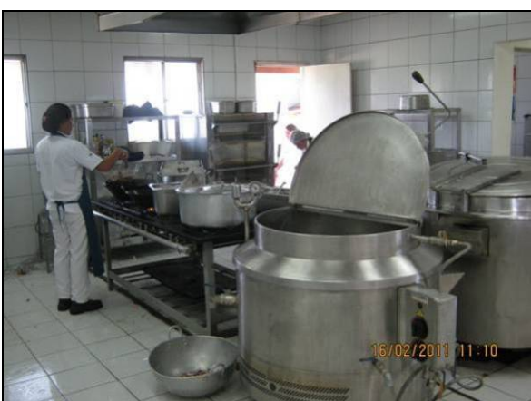
Foto 4.2.362. Cozinha industrial (fev/11).
