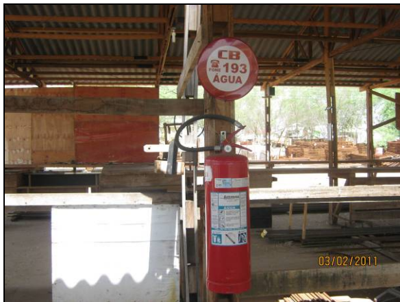
Foto 4.2.485. Extintor de incêndio instalado na área da carpintaria (fev/11).
