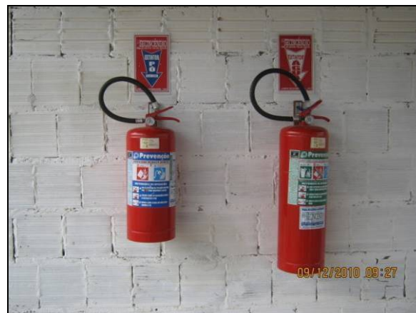
Foto 4.2.951.Extintores de incêndio instalados na estrutura de apoio (dez/10).
