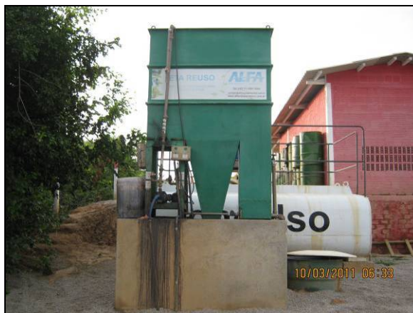
Foto 4.2.195. Estação de tratamento dos efluentes do SAO (mar/11).
