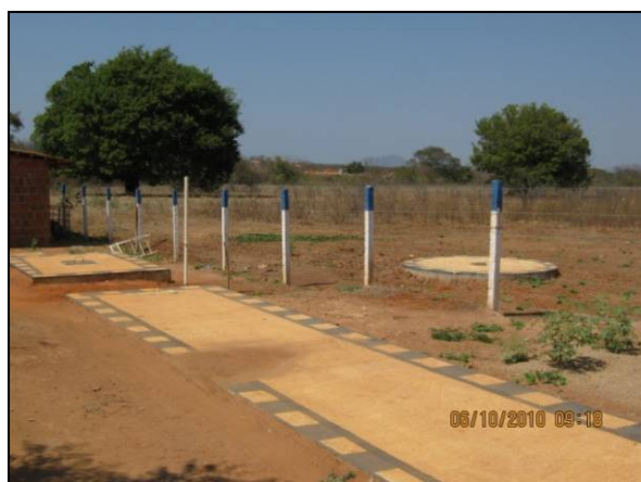
Foto 4.2.321. Sistema de tratamento de efluentes dos escritórios (out/10).
