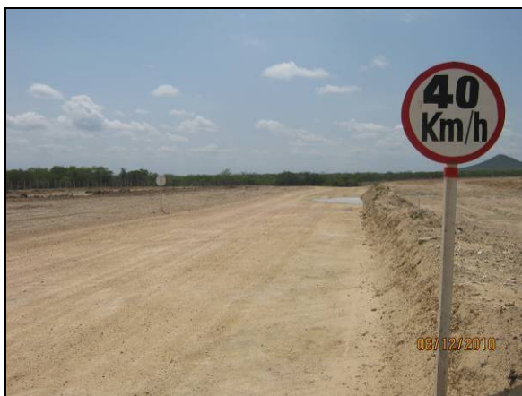
Foto 4.2.545. Sinalização de controle de velocidade em via de acesso no WBS 2216 (dez/10).
