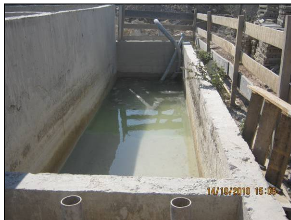
Foto 4.2.138. Tanque de decantação dos resíduos instalado na central de concreto (out/10).
