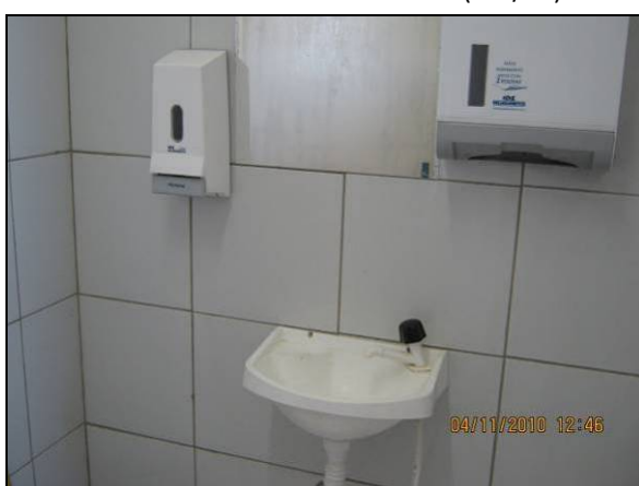
Foto 4.2.360. Lavatório do refeitório administrativo (nov/10).
