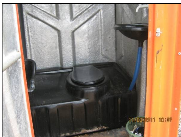
Foto 4.2.890. Banheiro químico limpo na janela do túnel Cuncas I (mar/11).
