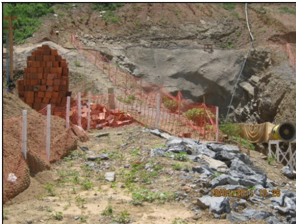
Foto 4.2.835. Tela sinalizadora instalada na borda do talude da janela do túnel Cuncas I (jan/11).
