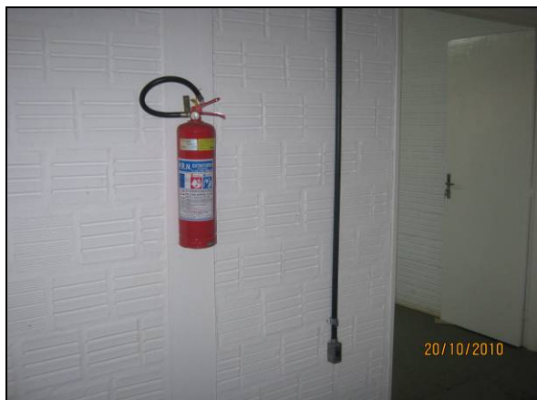
Foto 4.2.245. Extintor de incêndio no refeitório (out/10).
