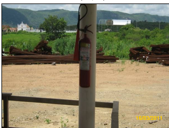
Foto 4.2.386. Extintor disponível na carpintaria do canteiro (mar/11).
