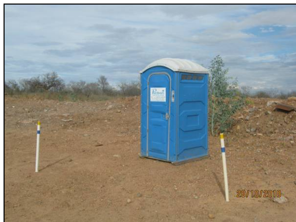
Foto 4.2.509. Banheiro químico instalado no Aqueduto da BR-316, WBS 2304 (out/10).
