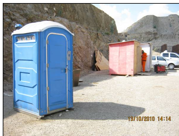
Foto 4.2.790. Banheiro químico disponibilizado na área da EBV-5 (out/11).
