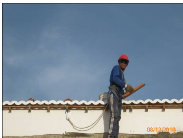
Foto 4.2.827. Colaborador usando EPI corretamente na realização de trabalho em altura no canteiro de obras (dez/11).
