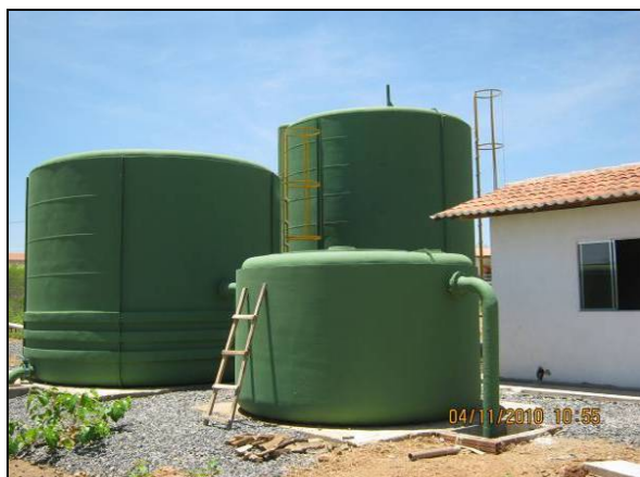
Foto 4.2.407. ETE compacta modulada (nov/10).
