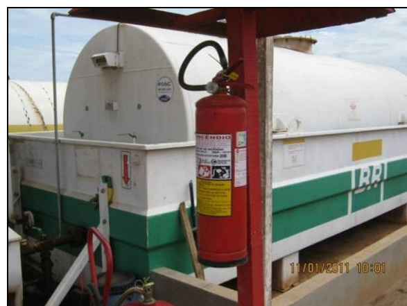
Foto 4.2.310. Extintor de incêndio instalado no posto de combustível (jan/11).
