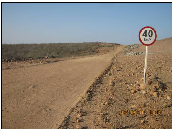
Foto 4.2.488. Sinalização para controle de velocidade instalada no WBS 2205 (out/10).
