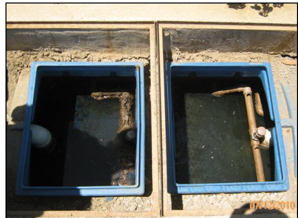
Foto 4.2.412. Separador de Água e Óleo do posto de abastecimento (dez/10).
