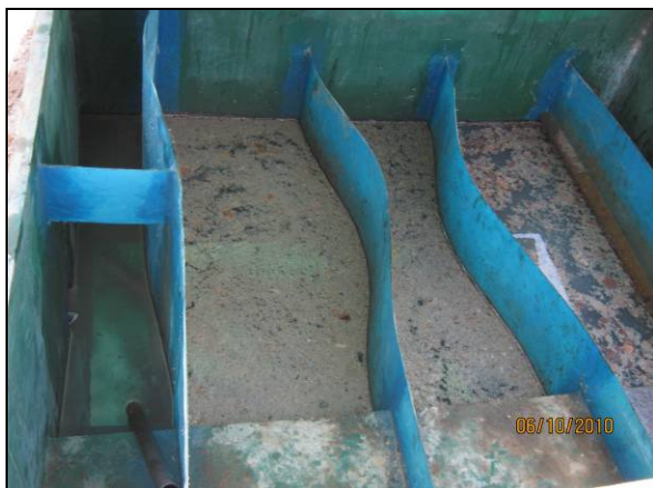
Foto 4.2.90. Caixa de gordura do canteiro em funcionamento (nov/10).
