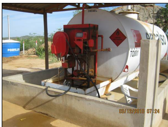
Foto 4.2.160. Bacia de contenção de vazamento (dez/10).
