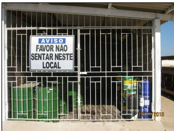
Foto 4.2.779. Baía para armazenamento de produtos perigosos, na área do canteiro de obras de Floresta - PE (nov/10).
