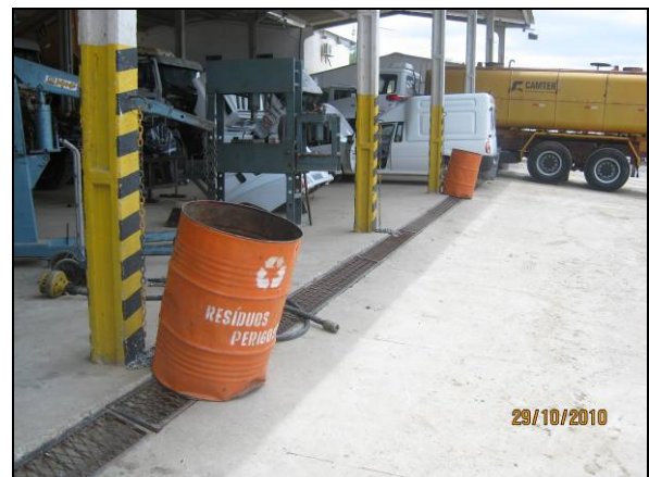
Foto 4.2.470. Canaleta de direcionamento de efluentes ao SAO em boas condições de manutenção (out/10).
