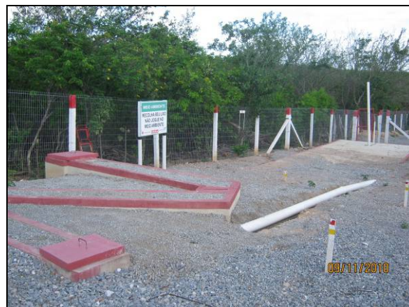
Foto 4.2.552. Sistema de tratamento em "zig-zag" da lavanderia dos alojamentos (nov/10).
