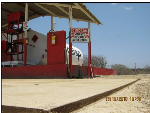
Foto 4.2.765. Canaletas de direcionamento de efluentes ao SAO do posto de abastecimento de Sertânia - PE (out/10).
