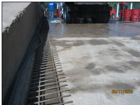
Foto 4.2.556. Canaleta de direcionamento de efluentes ao SAO do lavajato (nov/10).
