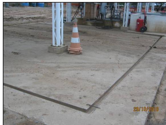
Foto 4.2.497. Canaletas de direcionamento de efluentes ao SAO do posto de abastecimento (out/10).
