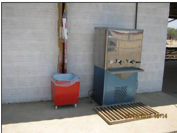
Foto 4.2.715. Bebedouro com água potável refrigerada no canteiro de obras de Sertânia - PE (out/10).
