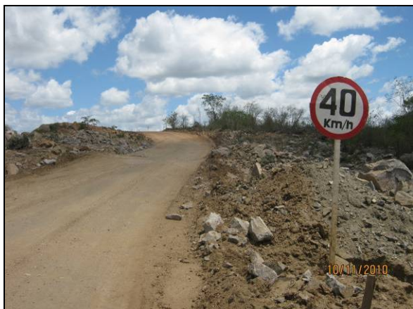
Foto 4.2.659. Placa para controle de velocidade instalada ao longo da via de acesso no WBS 2225 (nov/10).
