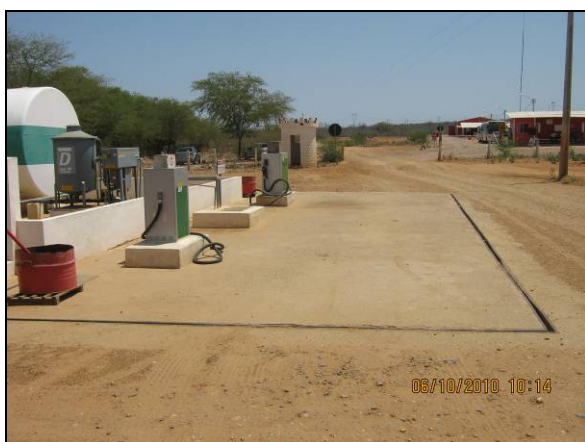
Foto 4.2.454. Piso impermeabilizado e canaletas de direcionamento de efluentes ao SAO (out/10).
