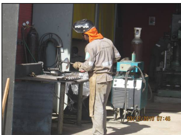
Foto 4.2.163. Uso correto dos EPI pelo colaborador na oficina mecânica do canteiro de obras (dez/10).
