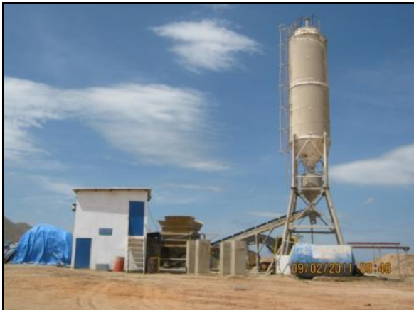
Foto 4.2.340. Central de concreto em operação (fev/11).
