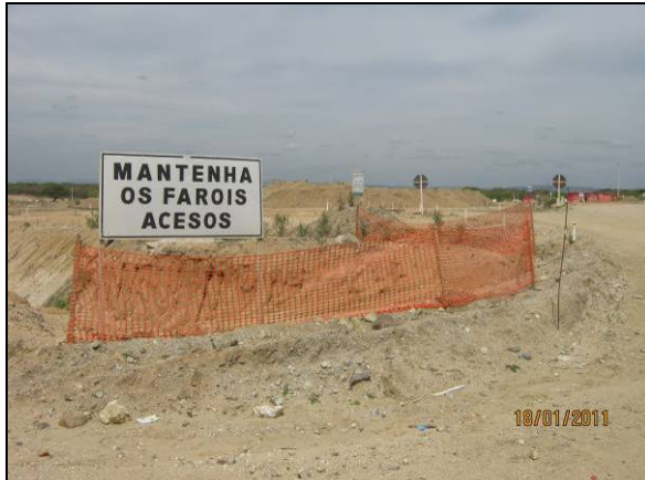
Foto 4.2.753. Divulgação do código de conduta por meio de sinalização instalada em área da EBV-1 (jan/11).
