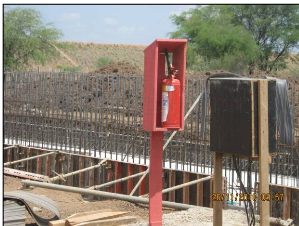
Foto 4.2.246. Extintor de incêndio próximo ao bueiro B 02, WBS 1223 (nov/10).
