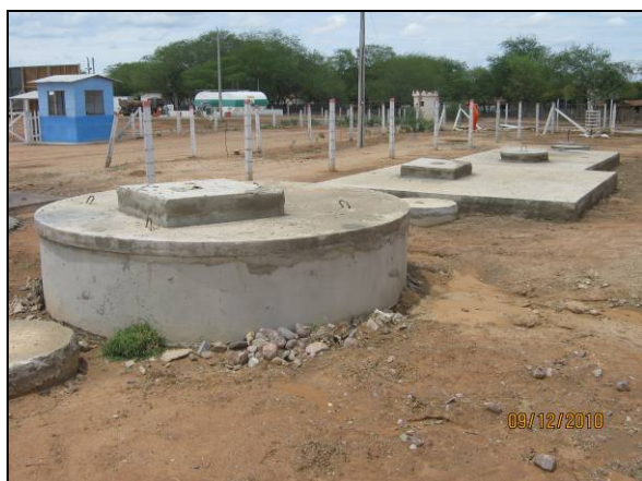
Foto 4.2.757. Sistema de tratamento de esgoto do canteiro de obras de Floresta - PE (dez/10).
