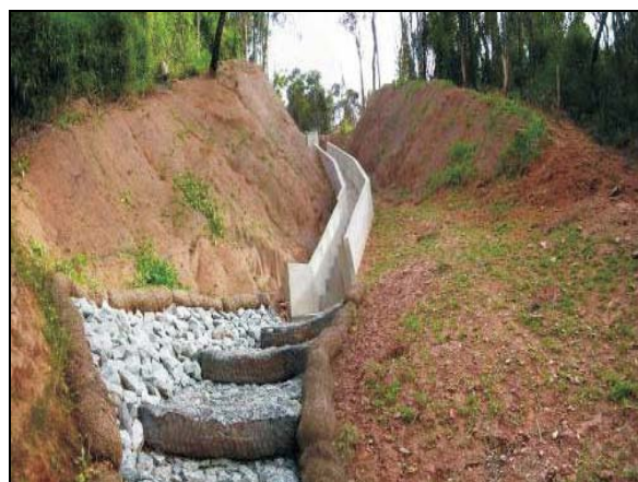
Foto 06: Escada hidráulica – Sistema de drenagem artificial.
