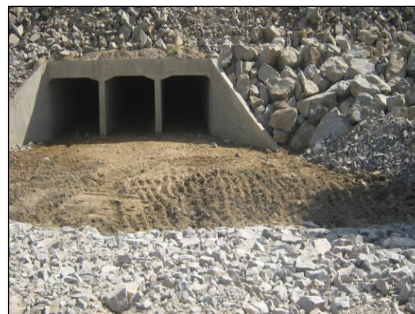
Foto 08: Bueiro – Sistema de drenagem subterrânea.
