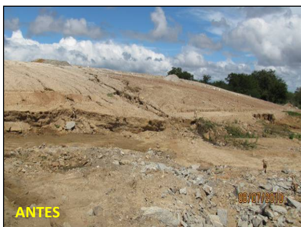
Foto 25. Visita in loco identificando processo erosivo.
