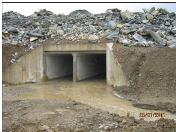
Foto 07: Bueiro – Sistema de drenagem subterrânea.
