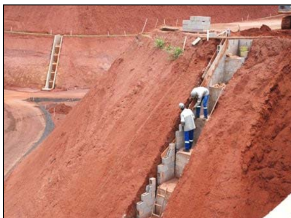
Foto 05: Escada hidráulica – Sistema de drenagem artificial.
