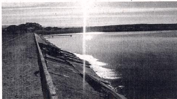
Foto 2: Taludes quebrados na lagoa de estabilização da sede de Barbalha
