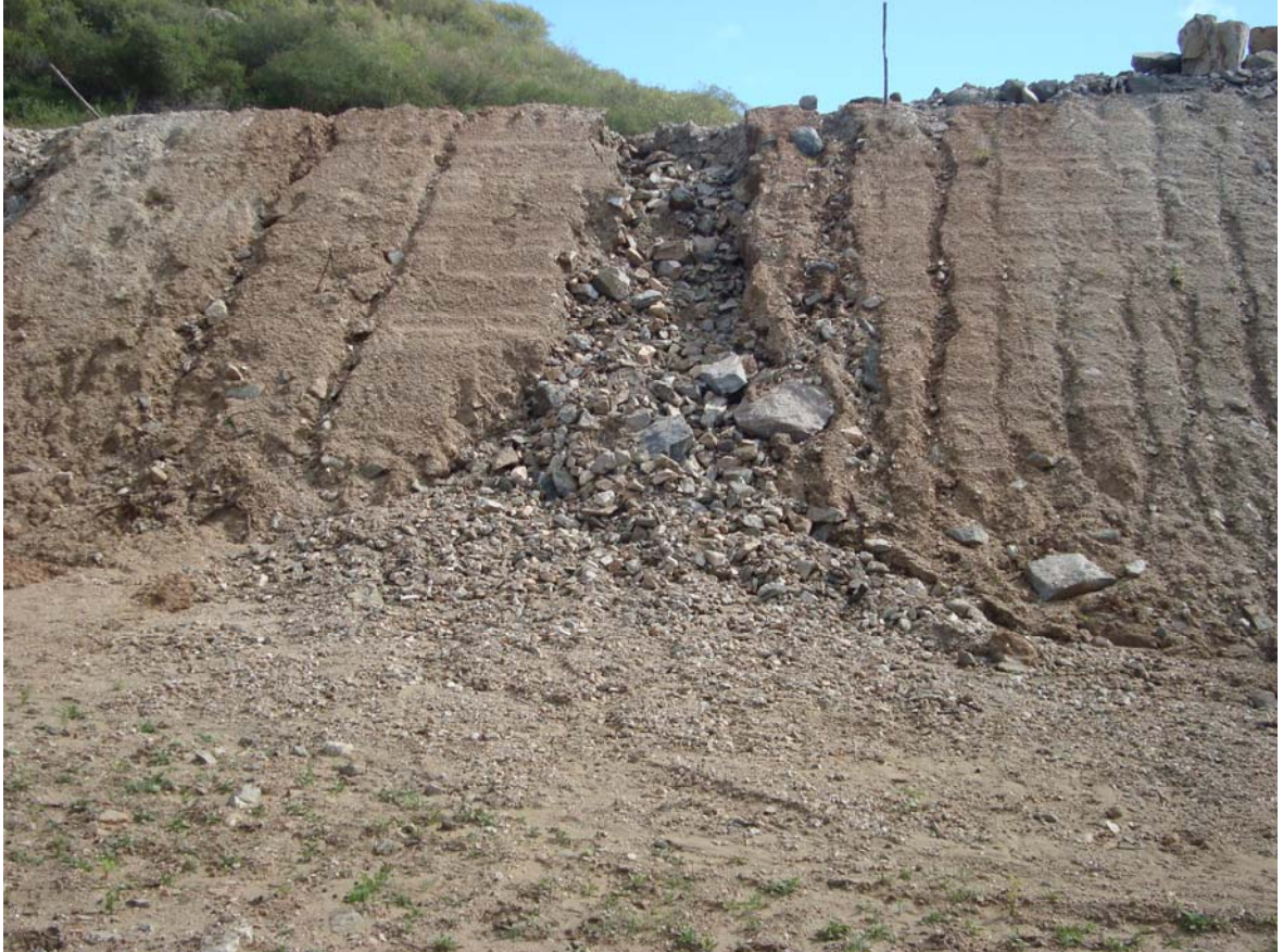
Figura 4: Erosão linear a partir do topo do talude em aterro (Canal 2224), observando-se a remoção em sulco das partículas finas do enrocamento.
