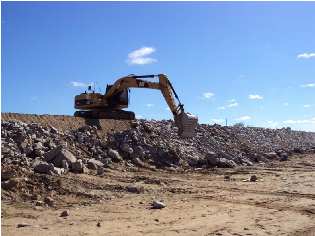
Figura 3: Canal em aterro compactado de material de 2ª categoria em processo de proteção com enrocamento sem finos e sem transição granular. Observa-se a esquerda a superfície remanescente do talude após a remoção do material solto da borda (“bigode”).
