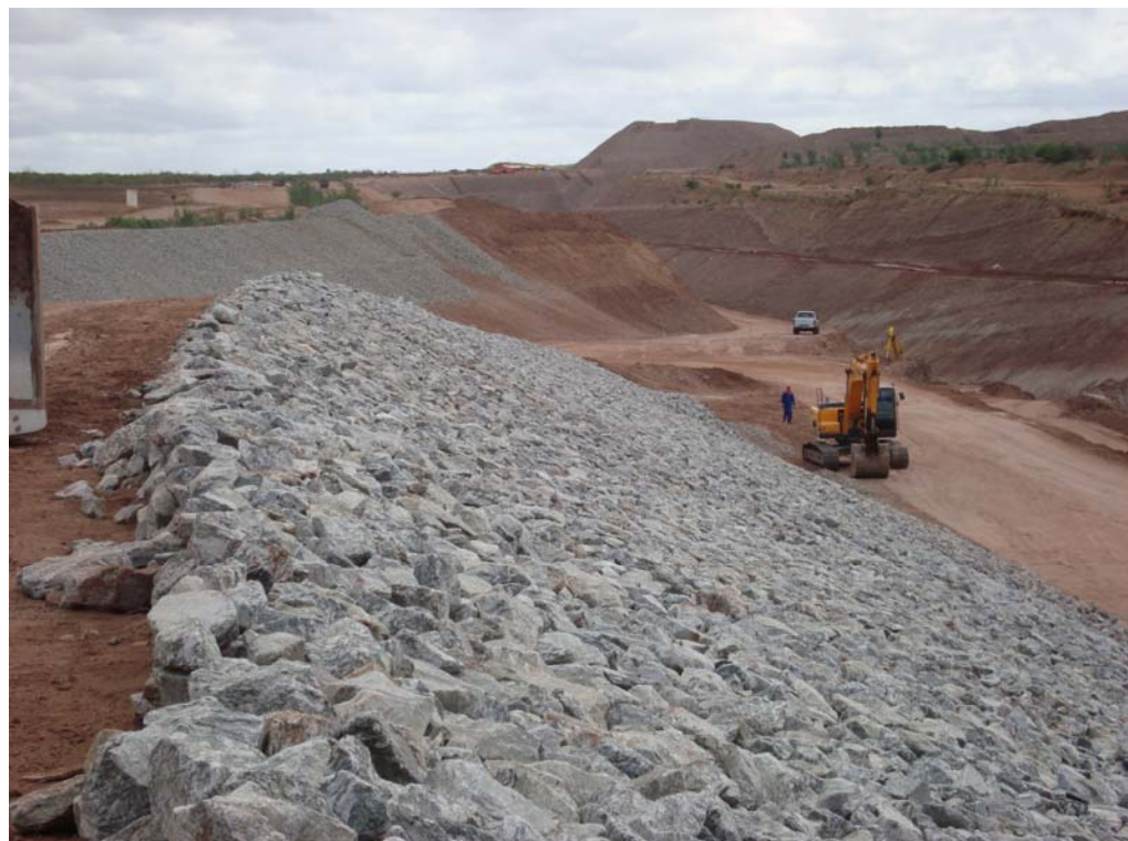
Figura 6: Proteção de talude de corte com enrocamento sem finos e sem transição granular talude x enrocamento, não observando-se erosão linear a partir do topo do talude.
