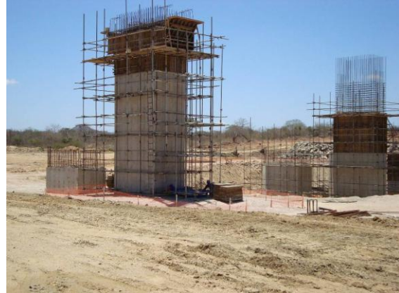
Foto 08 – Aqueduto Saco da Serra – Vista dos pilares P05 e P06 no apoio AP-03 – Lote 1.
