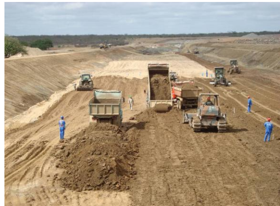
Foto 10 – Barragem Tucutu - Serviços de lançamento de material sobre o filtro horizontal (areia) no corpo da barragem.
