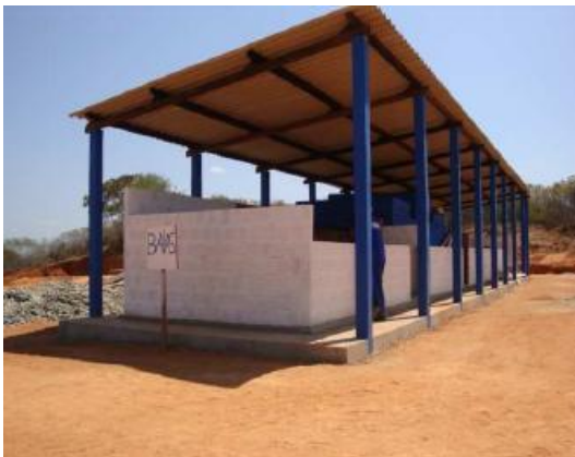
Foto 13 – Baias para acondicionamento dos resíduos sólidos – Lote 6.
