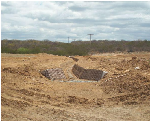
Foto 5 – Execução de drenagem e reconformação do terreno para início das atividades de recuperação – próxima ao 3º BEC de aproximação – 3º BEC
