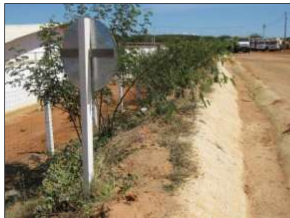
Foto 4.27 59. Canaleta de escoamento pluvial na crista do talude para prevenção de erosão (ago/2014).
