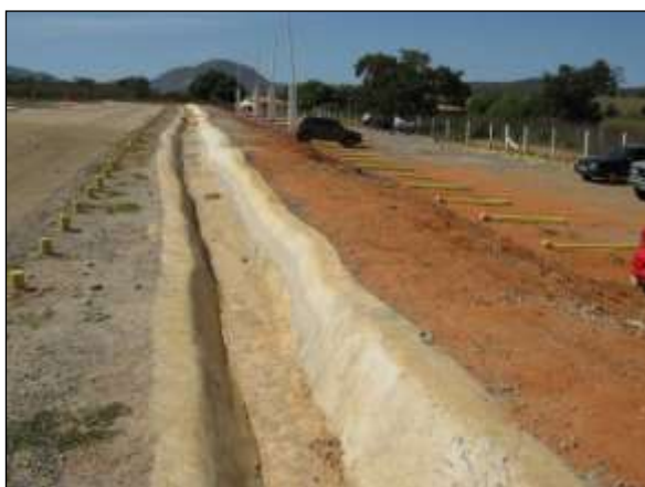
Foto 4.27 60. Canaleta de escoamento pluvial na crista do talude para prevenção de erosão (ago/2014).
