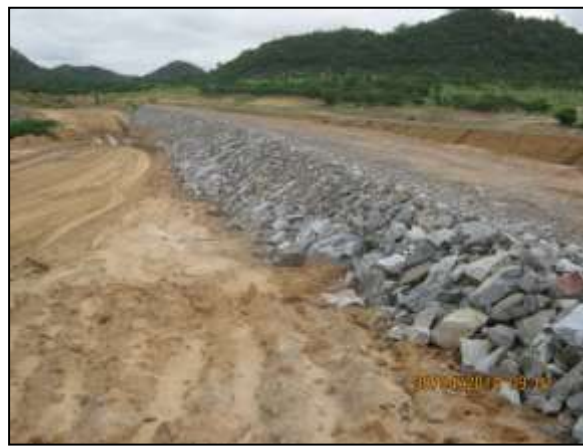
Foto 4.27 47. Enrocamento de talude de canal para dissipação das águas drenadas superficialmente (abr/2014).
