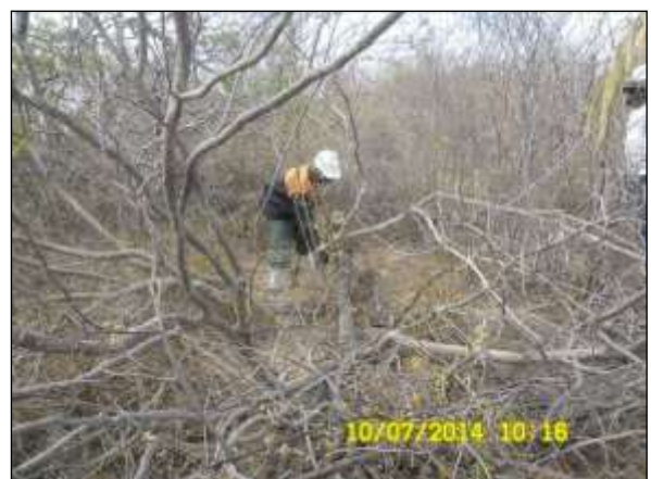
Foto 4.10 78. Supressão semimecanizada acompanhada pela equipe especializada do CEMAFAUNA para possíveis resgates (jul/2014).
