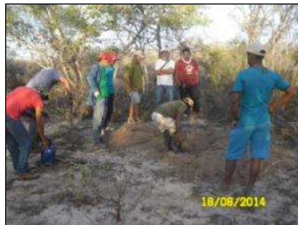
Foto 4.16. 16. Abertura de trincheira para seleção de área para implantação do projeto de irrigação no Assentamento Poço do Angico, Cabrobó - PE (ago/2014).
