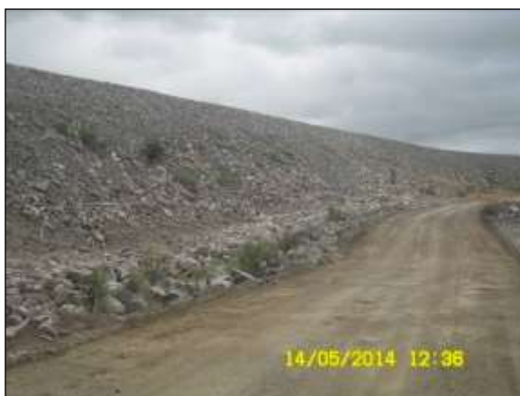
Foto 4.27 74. Enroncamento de talude como medida preventiva ao surgimento de processo erosivos no WBS 2207 (maio/2014).
