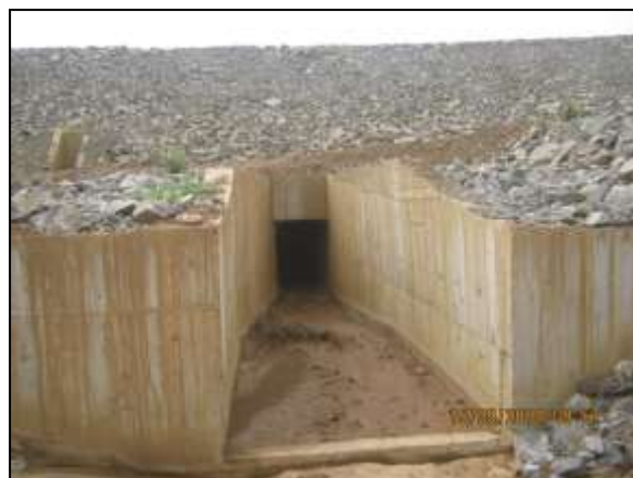
Foto 4.27 43. Enrocamento de talude implantado adjacente a sistema drenagem como medida preventiva e de controle (maio/2014).
