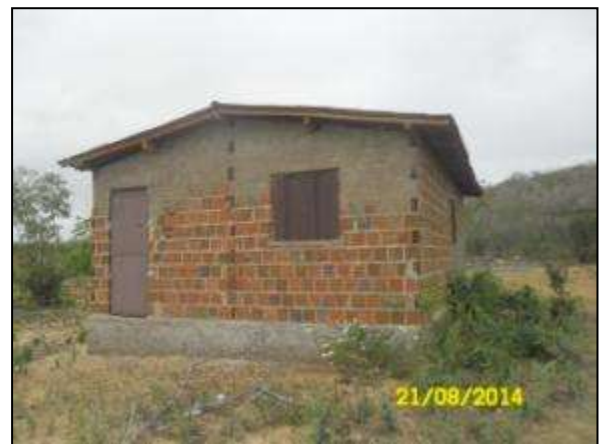
Foto 4.12 7. Casa de 02 quartos do Sr. João Manoel dos Santos com obras paralisadas, aldeia Faveleira, Etnia Pipipã, localizado no município de Floresta – PE (ago/2014).
