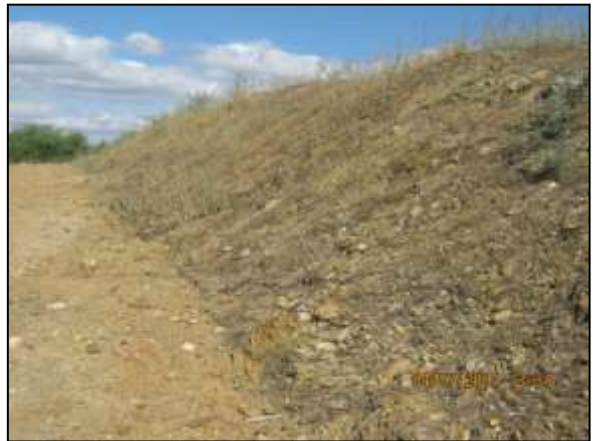
Foto 4.9.10. Talude revestido com biomanta para a prevenção de processos erosivos, apresentando desenvolvimento de espécies herbáceas que auxiliam na estabilização, Britador (jul/2014).
