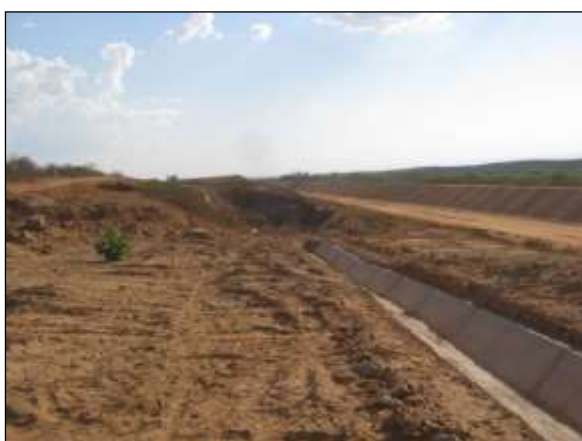
Foto 4.27 64. Canaleta de escoamento pluvial implantada na faixa de domínio do canal para direcionamento de águas pluviais (set/2014).
