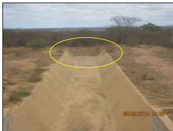
Foto 4.27 51. Sistema de drenagem com canal de restituição concretado e com dissipadores de energia, em destaque (set/2014).
