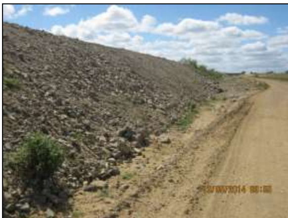
Foto 4.27 16. Talude estabilizado por enrocamento para dissipação de energia de águas drenadas superficialmente (maio/2014).
