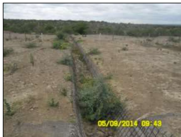
Foto 4.27.4. Ecocalhas com dissipadores de energia advindos da bacia de contenção de águas pluviais na área BF-04-CL (set/2014).
