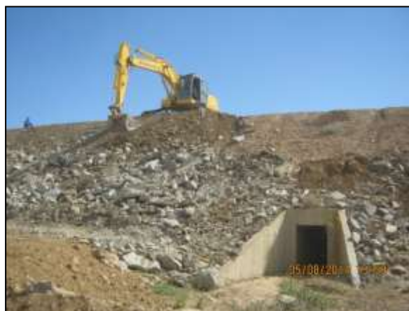
Foto 4.27 14. Enrocamento de talude de canal para estabilização e a dissipação de energia de águas pluviais (ago/2014).
