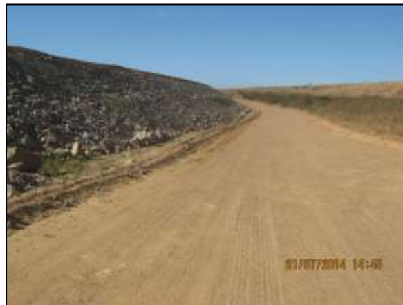
Foto 4.27 49. Medida de proteção contra processos erosivos com enrocamento do talude de canal margeando estrada de serviço (jul/2014).
