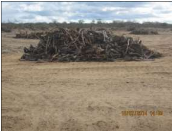
Foto 4.10 18. Segregação do material lenhoso na bacia hidráulica do reservatório Tucutu para posterior transporte e armazenamento adequado (jul/2014)
