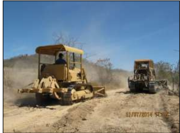
Foto 4.10 109. Supressão mecanizada e remoção de "top soil" na área da VPR Queimada Grande (jul/2014).
