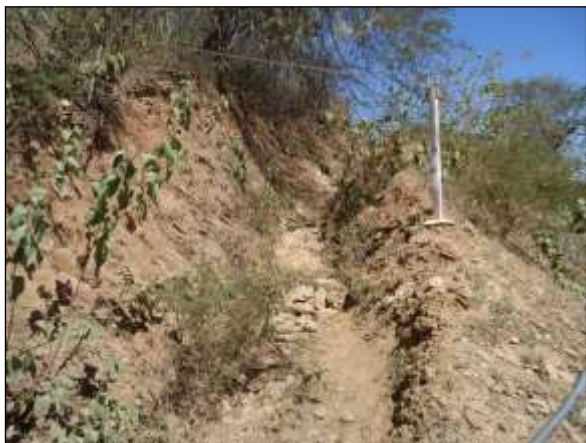
Foto 4.27 91. Canaleta para direcionamento de escoamento pluvial e prevenção de processos erosivos acima do espelho do túnel (jul/2014).
