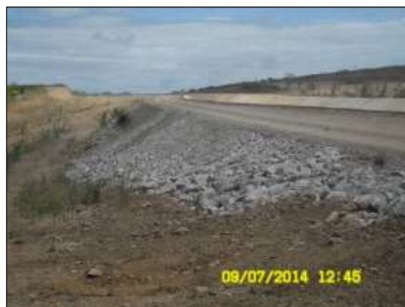
Foto 4.27 72. Enroncamento do talude de aterro no WBS 2205 como medida preventiva ao surgimento de processos erosivos (jul/2014).
