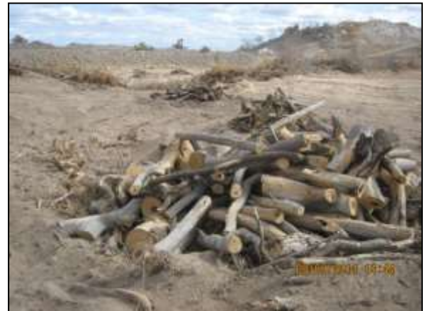
Foto 4.10 13. Segregação do material lenhoso na bacia hidráulica do reservatório Negreiros para posterior transporte e armazenamento adequado (set/2014).
