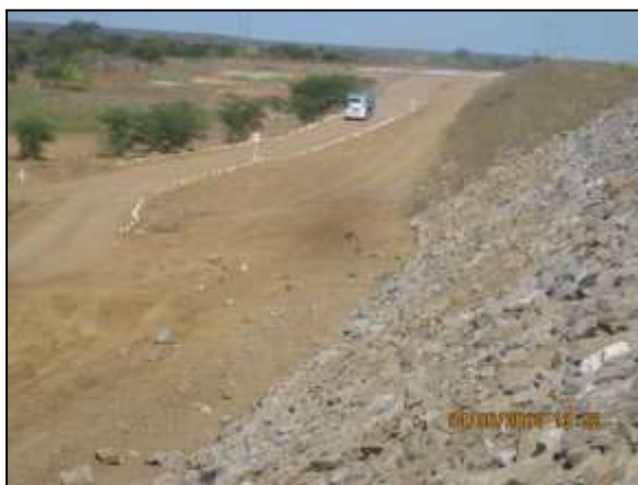
Foto 4.27 7. Enrocamento de talude de canal para dissipação das águas drenadas superficialmente (jun/2014).
