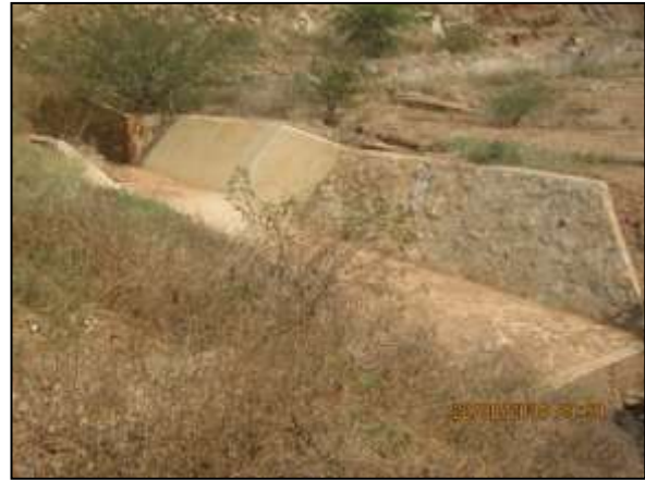
Foto 4.27 55. Sistema de drenagem implantada com dissipadores de energia (ago/2014).
