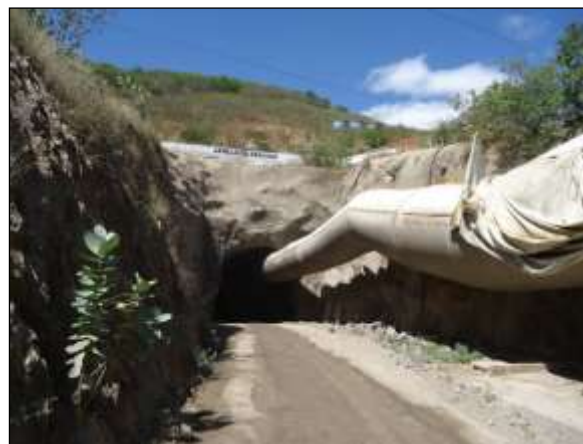
Foto 4.27 90. Concreto projetado na área do espelho do túnel como medida de prevenção e controle de processos erosivos (jun/2014).
