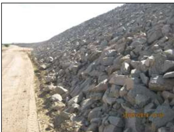
Foto 4.27 20. Enrocamento para dissipação das águas drenadas superficialmente e estabilização de talude (maio/2014).
