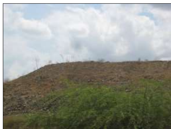
Foto 4.27 65. Talude externo do canal enrocado para prevenção de processos erosivo apresentando estabelecimento de vegetação (set/2014).
