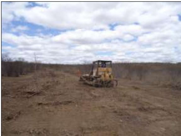
Foto 4.10 129. Supressão mecanizada em área da VPR Jurema, acompanhada por equipe treinada pela UNIVASF para o resgate e afugentamento da fauna (set/2014).
