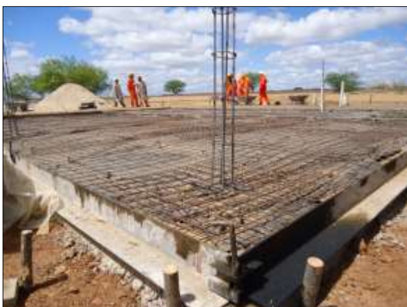
Foto 4.8.14. Acompanhamento das obras de construção do setor residencial da VPR Retiro, Penaforte - CE (ago/2014).
