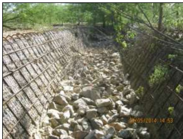
Foto 4.9.2. Ecocalha com dissipadores de energia, BF 01-CN (maio/2014).
