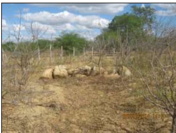
Foto 4.27 26. Filtro de rocha implantado como medida preventiva ao carreamento de sedimentos (ago/2014).
