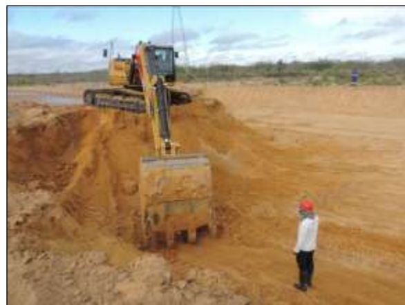
Foto 4.6 8. Acompanhamento de escavação do segmento de canal CL07, Meta 2L, Floresta - PE (jul/2014).
