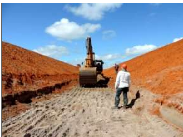
Foto 4.6 5. Acompanhamento de escavação do segmento de canal CN25 (WBS 1232), Meta 3N (maio/2014).
