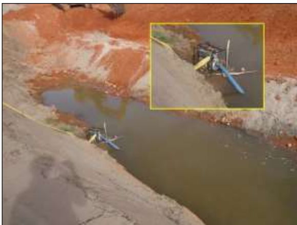
Foto 4.20 19. Esgotamento de água acumulada em área de implantação do reservatório Cana Brava para evitar possível proliferação de vetores e hospedeiros de doenças (set/2014).
