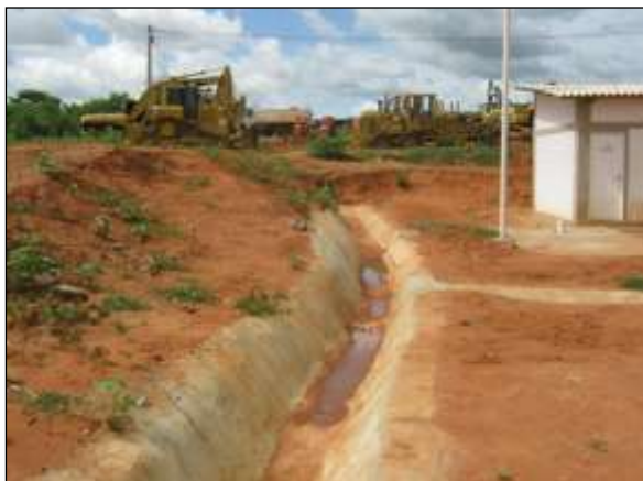
Foto 4.27 58. Canaletas de escoamento pluvial na base do talude para prevenção de erosão (abr/2014).
