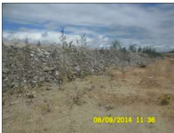
Foto 4.27 76. Enrocamento do talude de aterro no WBS 2212 como medida preventiva a ocorrência de processos erosivos (set/2014).
