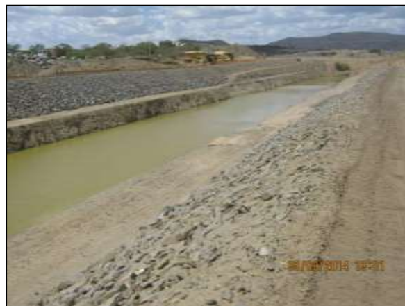
Foto 4.27 33. Enrocamento do talude de canal como medida preventiva à processos erosivos (set/2014).
