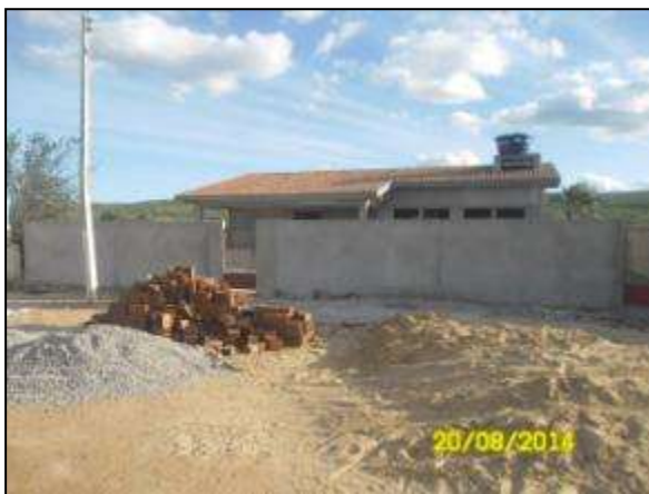
Foto 4.12 6. Posto de saúde com obras em andamento Etnia Kambiwá, localizado no município de Inajá – PE (ago/2014).
