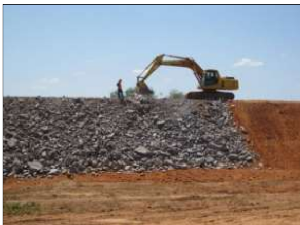
Foto 4.27 66. Enrocamento nos taludes externos do segmento de canal para prevenção e controle de processos erosivos (set/2014).
