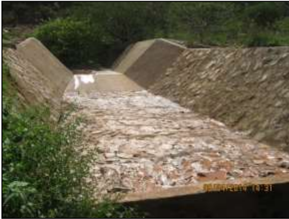
Foto 4.27 52. Sistema de drenagem com dissipadores de energia implantada no segmento de canal WBS 1219 (abr/2014).
