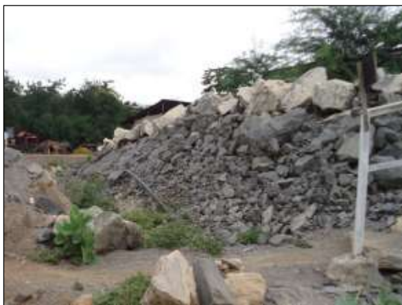
Foto 4.27 89. Talude do estacionamento enrocado como medida preventiva a processos erosivos (abr/2014).
