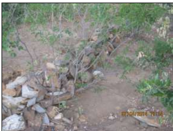
Foto 4.27 11. Filtro de rocha implantado como medida preventiva ao carreamento de sedimentos (abr/2014).
