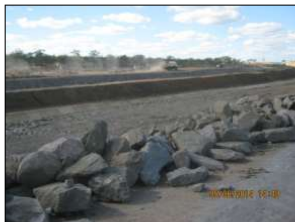
Foto 4.27 21. Disposição de material rochoso para aplicação em talude de canal como medida preventiva a ocorrência de processos erosivos (jun/2014).
