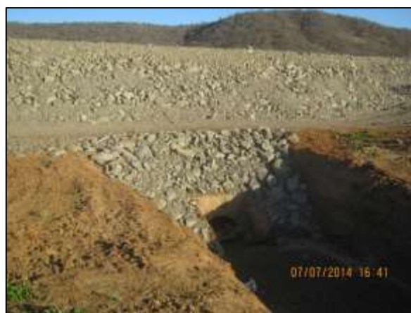
Foto 4.27 39. Enrocamento de talude implantado em cabeceira de sistema de drenagem como medida preventiva e de controle (jul/2014).
