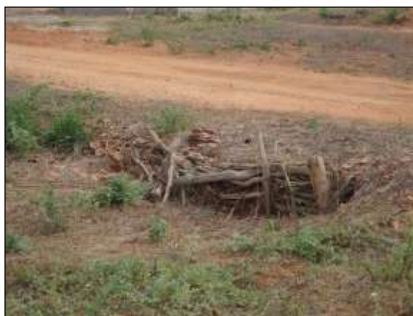
Foto 4.27 96. Cerca paliçada na lateral da via de acesso para controle de processo erosivo (set/2014).
