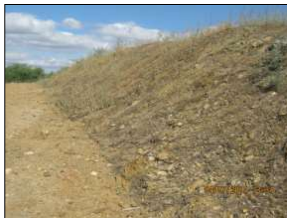
Foto 2.9.10. Talude revestido com biomanta para a prevenção de processos erosivos, apresentando desenvolvimento de espécies herbáceas que auxiliam na estabilização, Britador (jul/2014).
