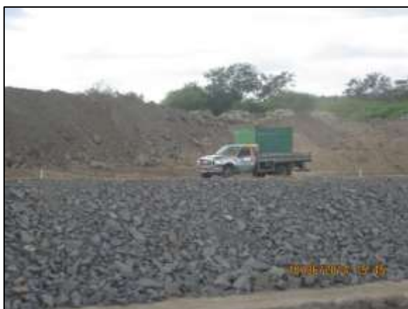
Foto 4.27 32. Medida de proteção contra processos erosivos com enrocamento do talude margeando estrada de serviço (jun/2014).
