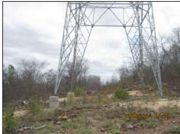
Foto 4.37.1. Verificação da estabilidade das superfícies adjacente às torres de transmissão próximas ao reservatório Serra do Livramento, Trecho I, Eixo Norte (ago/2014).
