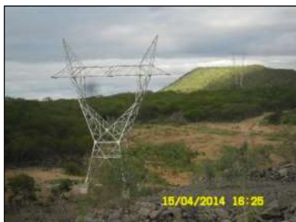
Foto 4.37.10. Verificação da estabilidade das superfícies adjacente às torres de transmissão próximas a EBV-4, Trecho V, Eixo Norte (abr/2014).
