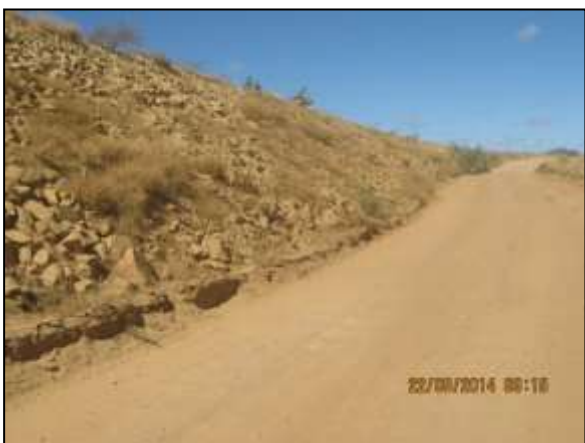
Foto 4.27 50. Talude de canal enrocado com surgimento espontâneo de espécies herbáceas que auxiliam na dissipação de escoamento de águas pluviais e na estabilização do talude (ago/2014)
