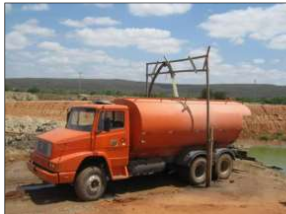
Foto 4.20 18. Esgotamento de água acumulada em área de implantação do segmento de canal - WBS 1233 para evitar possível proliferação de vetores e hospedeiros de doenças (set/2014).
