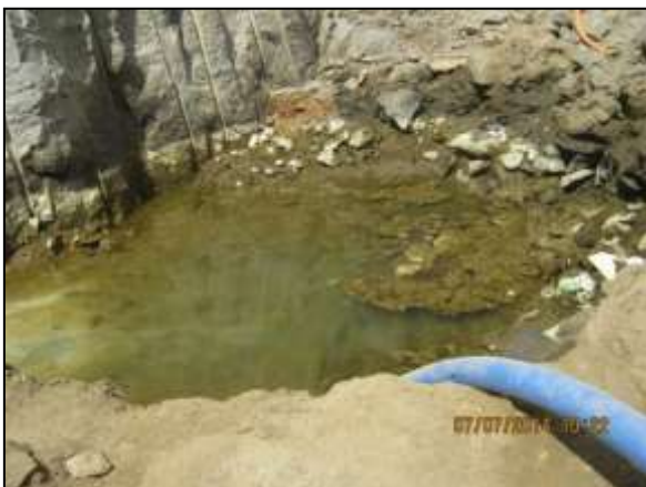
Foto 4.20 11. Acúmulo de água na área de implantação da estação de bombeamento EBI-02 sendo esgotado para evitar possível proliferação de vetores e hospedeiros de doenças (jul/2014).
