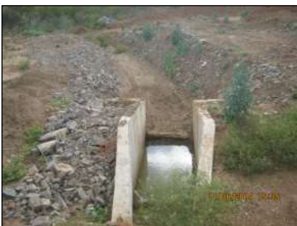
Foto 4.27 38. Estabilização de talude de canal e de sistema de drenagem por enrocamento (jun/2014).
