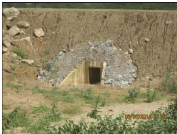
Foto 4.27 30. Início de enrocamento em talude de cabeceira de bueiro para estabilização topográfica (jun/2014).
