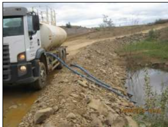
Foto 4.20 6. Esgotamento de acúmulo de água às margens da via de acesso para evitar possível proliferação de vetores e hospedeiros de doenças (maio/2014).
