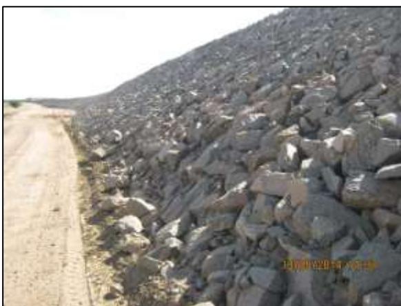
Foto 4.27 20. Enrocamento para dissipação das águas drenadas superficialmente e estabilização de talude (maio/2014).
