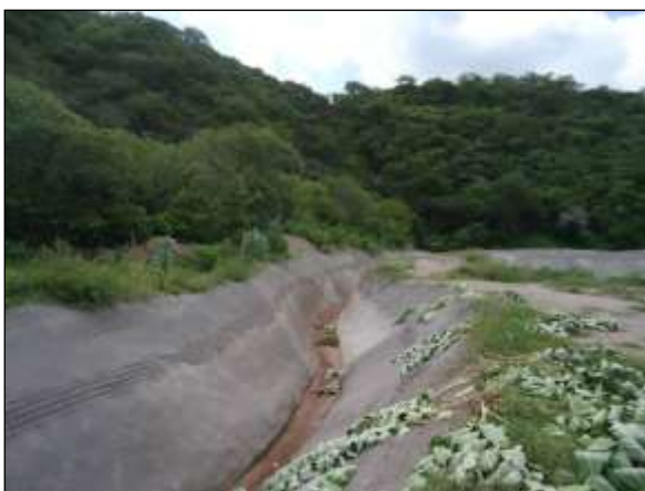
Foto 4.27 93. Canaleta de direcionamento do escoamento pluvial revestida de concreto projetado como medida preventiva (abr/2014).
