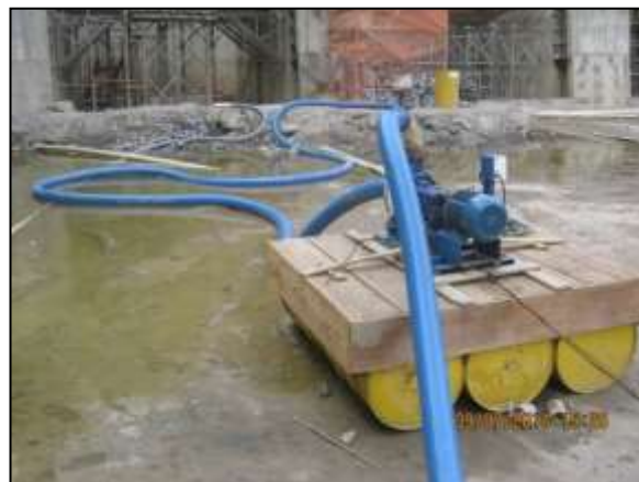
Foto 4.20 12. Esgotamento de água na área de implantação da estação de bombeamento EBI-03, para evitar possível proliferação de vetores e hospedeiros de doenças (jul/2014).
