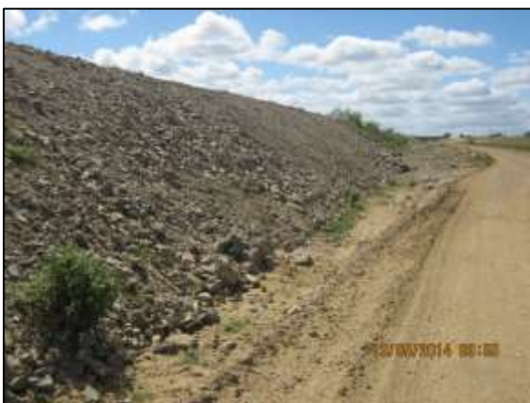
Foto 4.27 16. Talude estabilizado por enrocamento para dissipação de energia de águas drenadas superficialmente (maio/2014).
