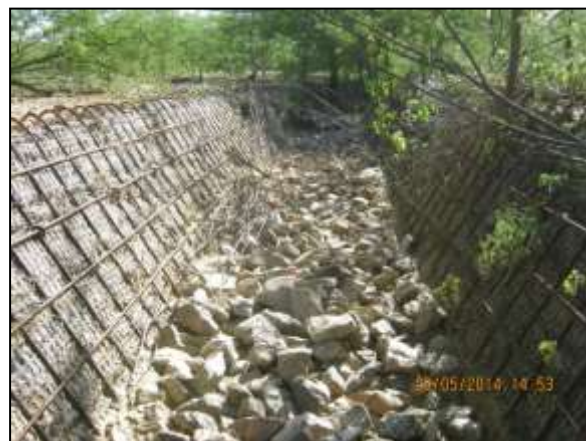
Foto 2.9.2. Ecolcha com dissipadores de energia, BF 01-CN (maio/2014).
