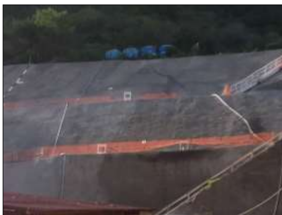
Foto 4.27.95. Concreto projetado no espelho do túnel para prevenção e controle de processo erosivo (ago/2014).
