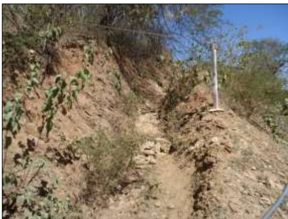
Foto 4.27 91. Canaleta para direcionamento de escoamento pluvial e prevenção de processos erosivos acima do espelho do túnel (jul/2014).
