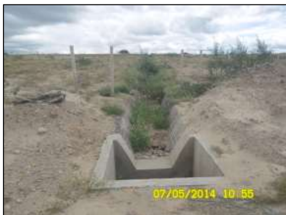
Foto 4.27 3. Caixa coletora na base da ecocalha, construída na saída da bacia de sedimentação da BF-04-CL como medida preventiva de processos erosivos (maio/2014).
