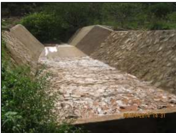
Foto 4.27 52. Sistema de drenagem com dissipadores de energia implantada no segmento de canal WBS 1219 (abr/2014).
