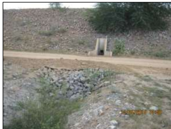
Foto 4.27 12. Enrocamento de talude de canal e cabeceira de drenagem para dissipação das águas drenadas superficialmente (maio/2014).
