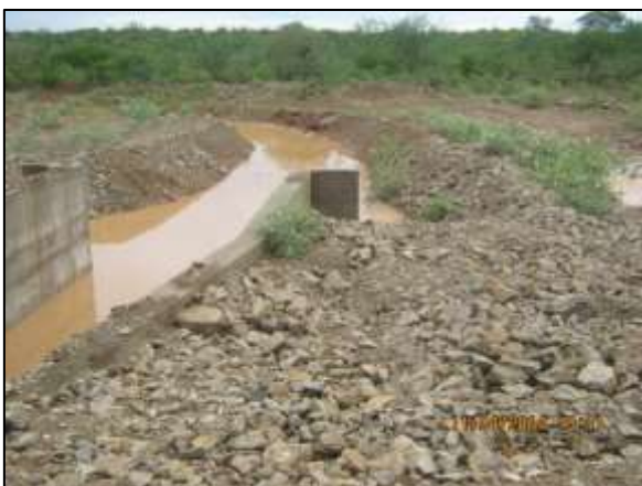
Foto 4.27 36. Medida de proteção contra processos erosivos com enrocamento do talude em saída sistema de drenagem (abr/2014).
