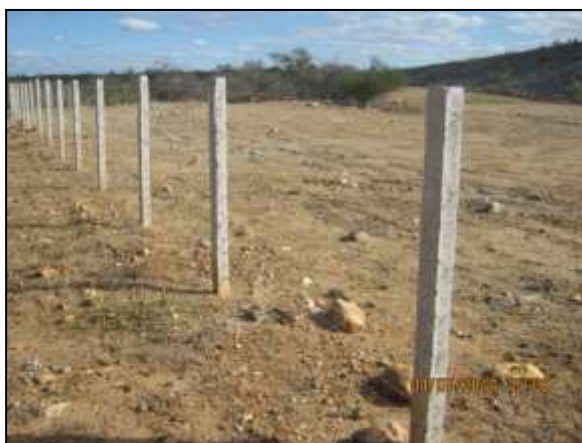
Foto 2.9.20. Cerca em bom estado de conservação, impedindo a entrada de animais domésticos na área de recuperação BF 04-BT (jul/2014).
