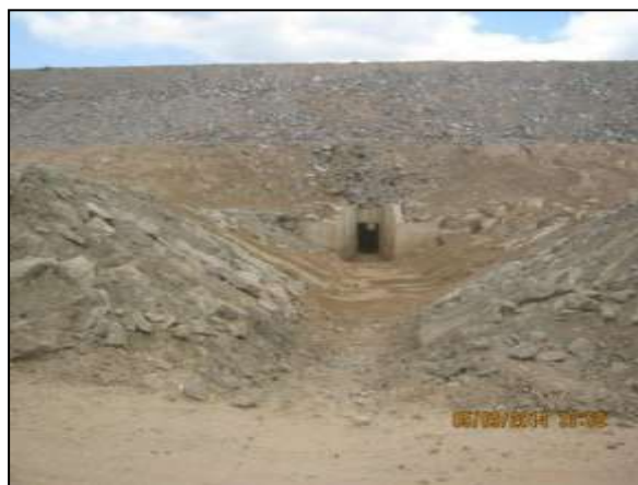
Foto 4.27 19. Talude de canal de adução e do sistema de drenagem adequadamente enrocado (set/2014).
