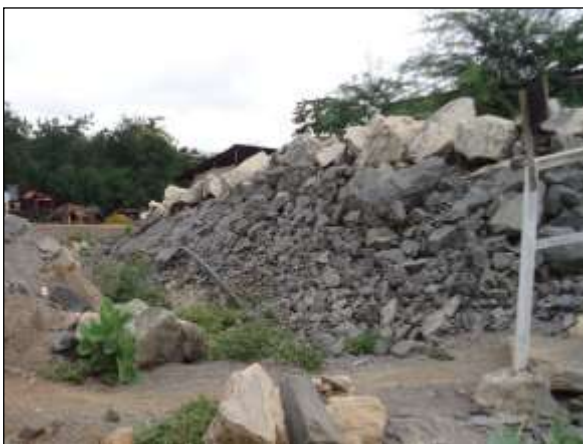
Foto 4.27 89. Talude do estacionamento enrocado como medida preventiva a processos erosivos (abr/2014).
