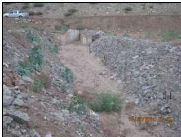
Foto 4.27 37. Enrocamento de talude de canal para dissipação das águas drenadas superficialmente (maio/2014).
