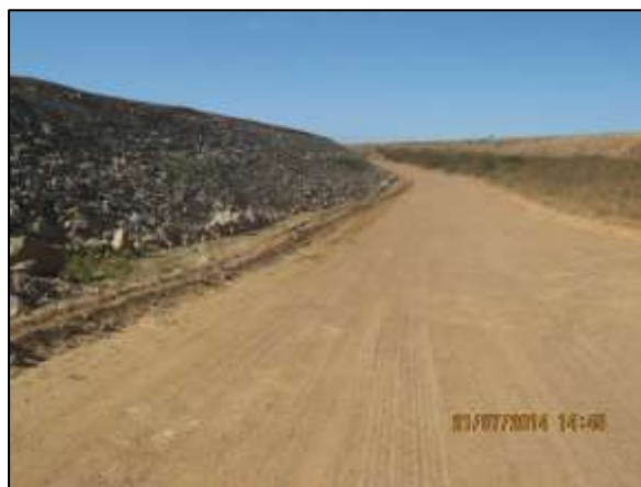
Foto 4.27 49. Medida de proteção contra processos erosivos com enrocamento do talude de canal margeando estrada de serviço (jul/2014).
