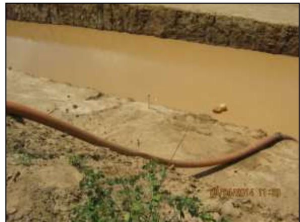
Foto 4.20 2. Esgotamento de água acumulada na escavação do canal para evitar possível proliferação de vetores e hospedeiros de doenças (abr/2014).
