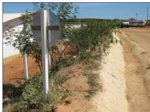
Foto 4.27 59. Canaleta de escoamento pluvial na crista do talude para prevenção de erosão (ago/2014).
