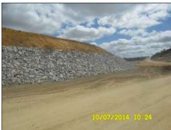
Foto 4.27 75. Enroncamento de talude no canal do WBS 2211 como medida preventiva ao surgimento de processos erosivos (jul/2014).
