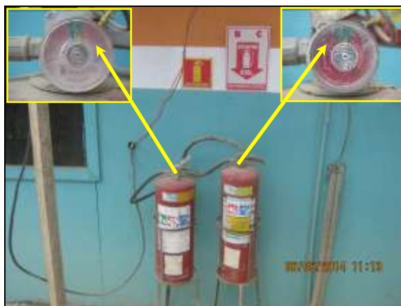
Foto 4.2.29. Extintores de incêndio em condições adequadas para uso na frente de serviço da central de concreto do WBS 1210 (jun/2014).
