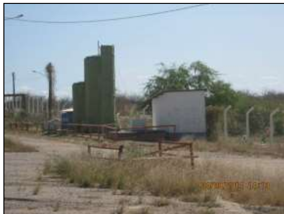
Foto 4.2.34. Sistema de tratamento de efluentes do canteiro de obras de Cabrobó - PE composto por reator UASB seguido de filtro anaeróbico (ago/2014).
