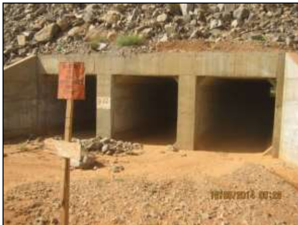
Foto 4.2.135. Bueiro simples celular de concreto - BSCC (bueiro 22) implantado no segmento de canal WBS 1219 (jun/2014).
