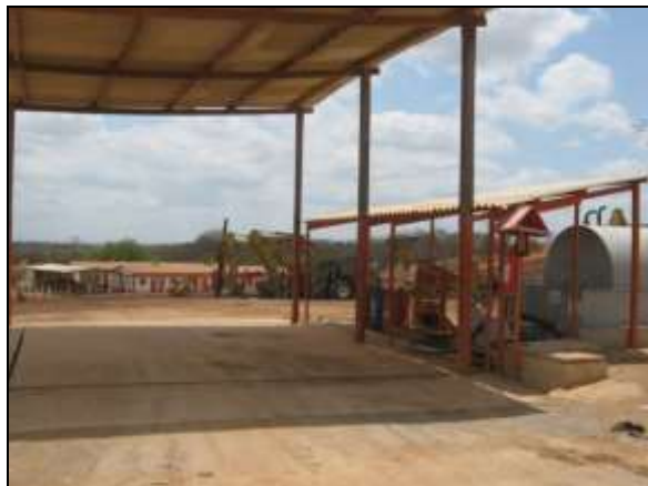
Foto 4.2.305. Posto de combustível implantado no canteiro central do antigo Lote 06, com área coberta, canaleta e sistema de tratamento de efluentes (set/2014).
