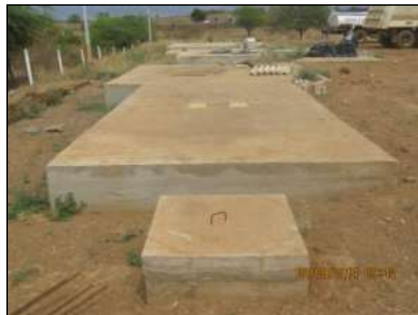
Foto 4.2.128. Sistema de tratamento de efluentes do canteiro de Penaforte – CE, composto por tanque séptico seguido de filtro anaeróbico (set/2014).
