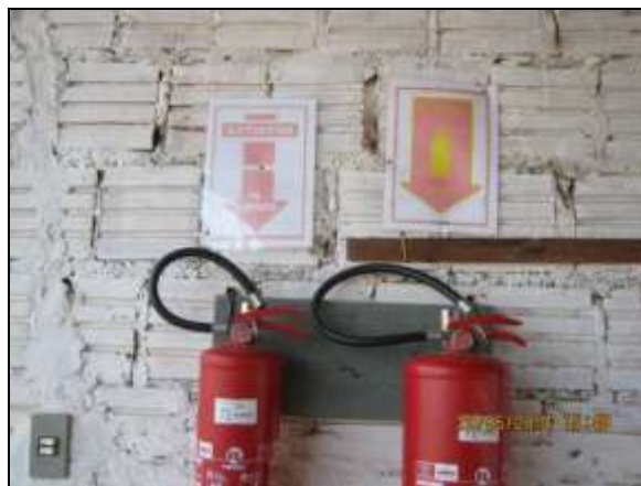
Foto 4.2.768. Extintores de incêndio na estrutura de apoio em condições adequadas para uso (jun/2014).
