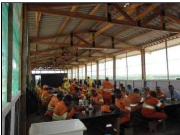
Foto 4.2.184. Estrutura de apoio para refeições na frente de serviço do vertedouro da barragem Cipó - WBS 1115 (jun/2014).
