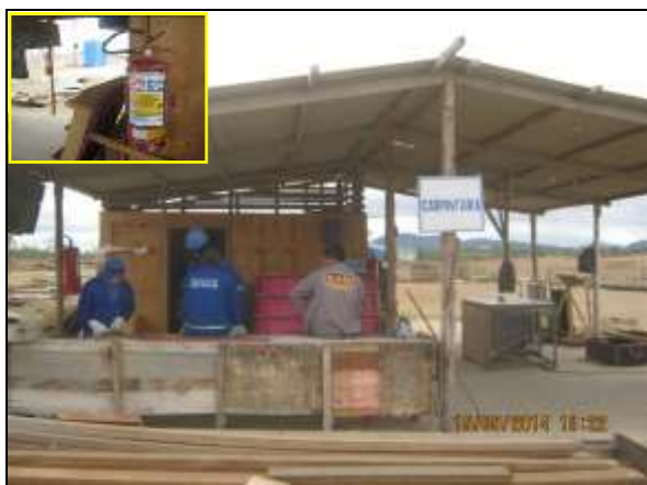
Foto 4.2.65. Carpintaria instalada na frente de serviço do vertedouro do reservatório Mangueira - WBS 1108 com equipamentos de proteção coletiva (maio/2014).
