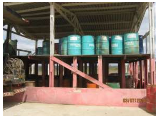
Foto 4.2.505. Baia para armazenamento de óleos e lubrificantes coberta, com piso impermeabilizado e mureta de contenção (jul/2014).
