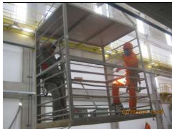
Foto 4.2.350. Colaboradores em gaiola de segurança para realização de atividades de acabamento na estrutura da EBI-01 (set/2014).
