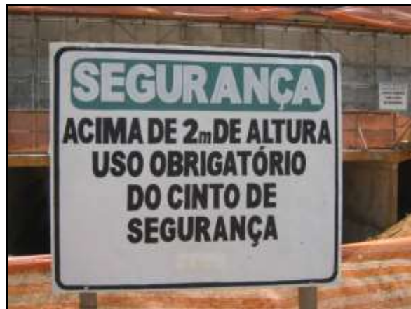
Foto 4.2.245. Placa de uso obrigatório de cinto de segurança para trabalho em altura na frente de serviço do bueiro Palha (set/2014).
