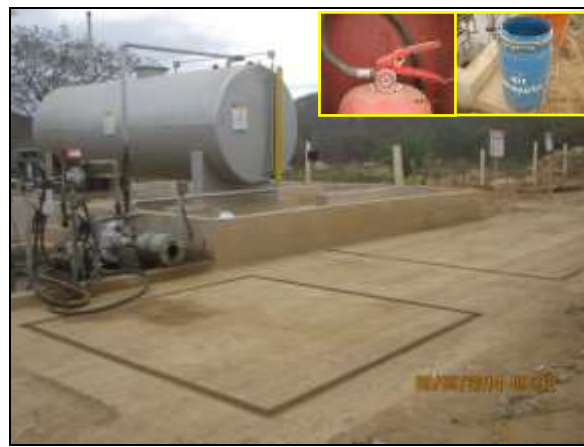
Foto 4.2.116. Posto de combustível do canteiro de Salgueiro - PE com bacia de contenção, piso impermeável e canaletas de drenagem interligadas ao SAO (set/2014).
