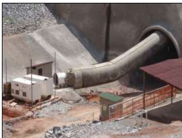
Foto 4.2.581. Duto de ventilação instalado no emboque do túnel Cuncas I (abr/2014).
