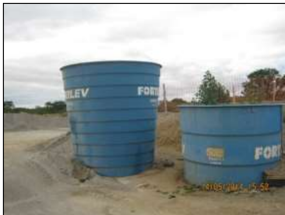
Foto 4.2.27. Reservatórios com água para utilização em atividades de concretagem na central de concreto do segmento de canal WBS 1210 (maio/2014).
