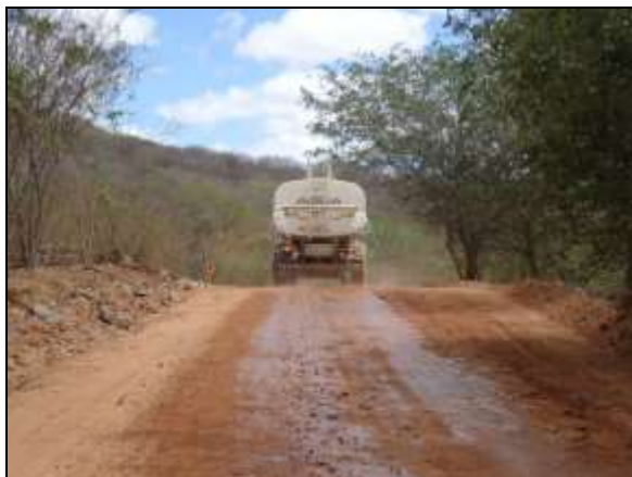
Foto 4.2.569. Umectação da via de acesso à frente de serviço do emboque do túnel Cuncas I - WBS 1410, em condições adequadas de trafegabilidade (jul/2014).
