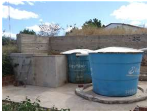
Foto 4.2.651. ETE que atende a estrutura de apoio do refeitório/alojamento da frente de serviço do emboque do túnel do Cuncas I (jun/2014).
