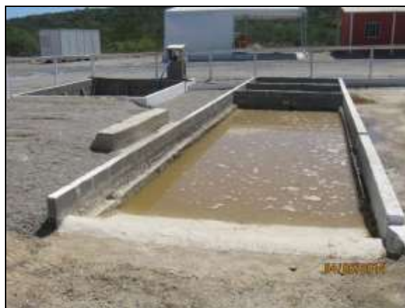
Foto 4.2.459. Sistema de tratamento da central de concreto instalada no WBS 2106 com funcionamento adequado (jun/2014).
