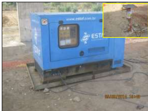
Foto 4.2.32. Gerador instalado sobre bandeja de contenção e extintor de incêndio na frente de serviço do aqueduto Mari (set/2014).
