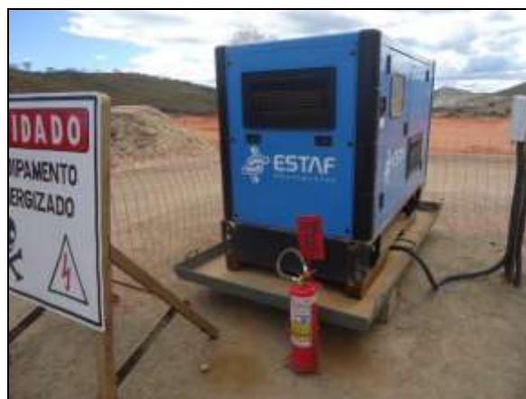
Foto 4.2.330. Gerador sinalizado, extintor, cerquite e bandeja de contenção de vazamentos na infraestrutura de apoio do reservatório Boa Vista - WBS 1119 (jul/2014).
