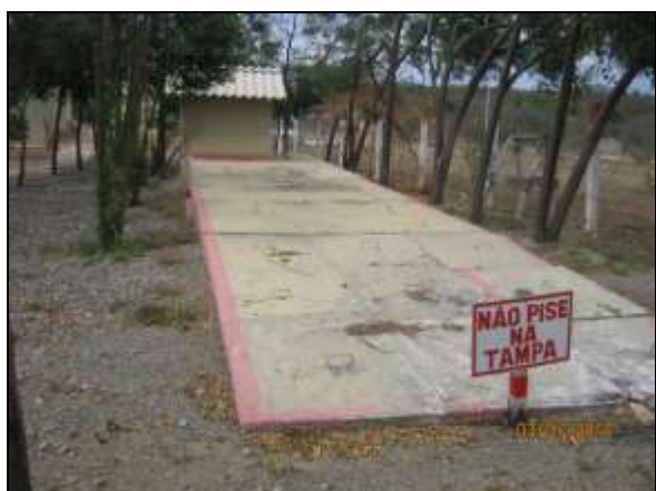
Foto 4.2.502. Sistema de esgotamento dos efluentes da cozinha em condições adequadas de funcionamento (jul/2014).
