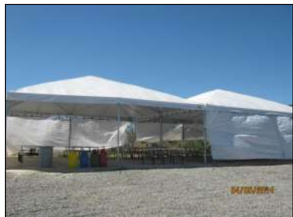
Foto 4.2.441. Tenda de apoio disponibilizada na frente de serviço com mesa, bancos e coletores de resíduos (jun/2014).
