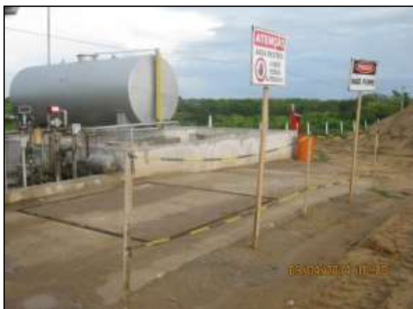
Foto 4.2.113. Posto de combustível com bacia de contenção, piso impermeável e canaletas de drenagem interligadas ao SAO no canteiro de obras de Penaforte - CE (abr/2014).
