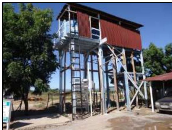
Foto 4.2.620. Armazenamento adequado de água no alojamento de Mauriti (jun/2014).
