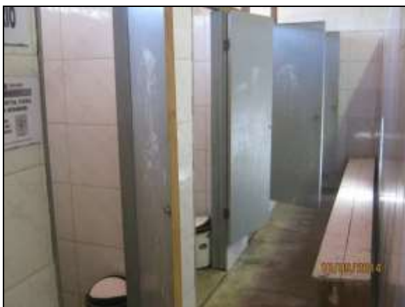
Foto 4.2.637. Sanitários para os colaboradores no vestiário do alojamento de Mauriti - CE (set/2014).
