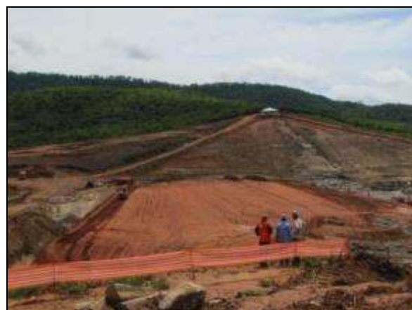
Foto 4.3.91. Construção do reservatório Boa Vista, localizado no município de São José de Piranhas –PB, Meta 3N (abr/2014).
