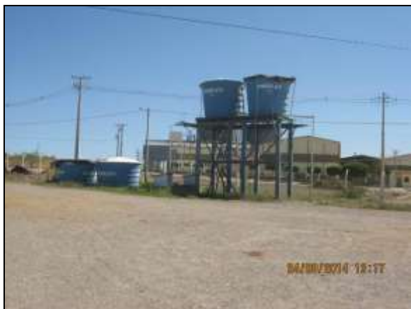
Foto 4.2.17. Reservatórios com armazenamento de água fornecida pela COMPESA para abastecimento do canteiro de obras (ago/2014).
