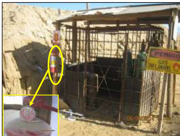
Foto 4.2.11. Extintor de incêndio disponível em baia com armazenamento de oxi-acetileno na frente de serviço do aqueduto Mari - WBS 1307 (ago/2014).
