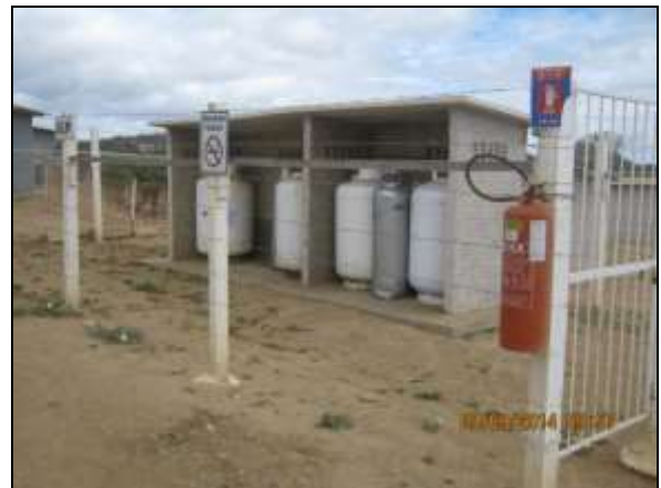
Foto 4.2.112. Armazenamento adequado de botijões de gás GLP da cozinha do canteiro de obras de Salgueiro – PE (set/2014).
