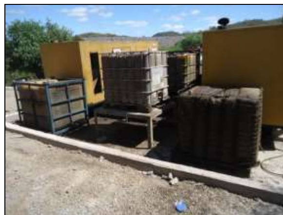
Foto 4.2.661. Bacia de contenção de grupo gerador disposto na frente de serviço da janela do túnel Cuncas I (jun/2014).
