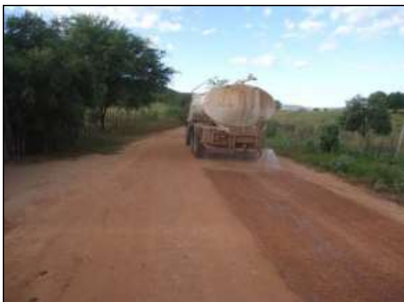
Foto 4.2.568. Umectação da via de acesso na frente de serviço do emboque do túnel Cuncas I - WBS 1410 (jun/2014).
