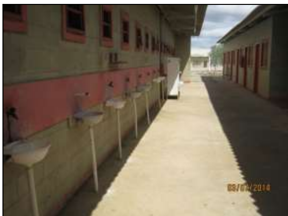
Foto 4.2.492. Lavatórios com manutenção adequada nos alojamentos (jul/2014).
