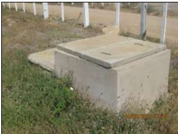
Foto 4.2.33. Caixa de passagem dos efluentes do canteiro para fossa séptica no canteiro de obras de Cabrobó - PE (jun/2014).
