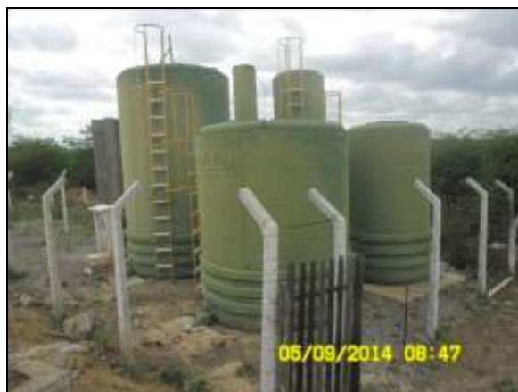
Foto 4.2.412. ETE do canteiro de obras com manutenção adequada (set/2014).
