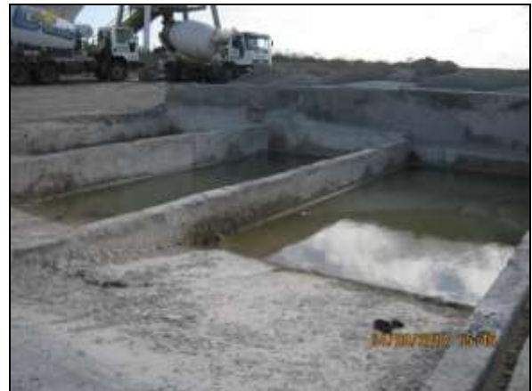
Foto 4.2.82. Tanques de decantação para disposição final e tratamento dos efluentes provenientes de atividades de concretagem e lavagem de caminhões-betoneira na central de concreto do WBS 1214 (ago/2014).
