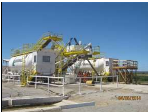
Foto 4.2.445. Central de concreto com funcionamento adequado instalada no WBS 2106 (jun/2014).
