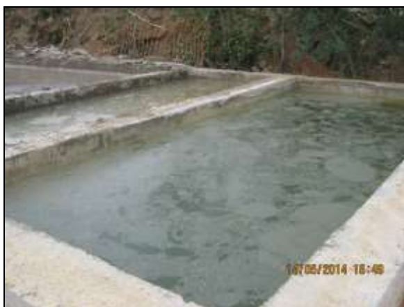
Foto 4.2.35. Tanque de decantação para lançamento de efluentes advindos da central de concreto do WBS 1210 e lavagem de caminhões-betoneiras (maio/2014).
