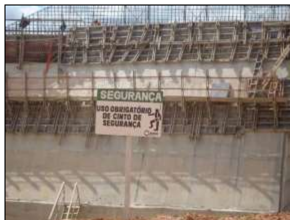
Foto 4.2.144. Placa de uso obrigatório de cinto de segurança para atividade em altura no vertedouro do reservatório Porcos – WBS 1113 (jul/2014).
