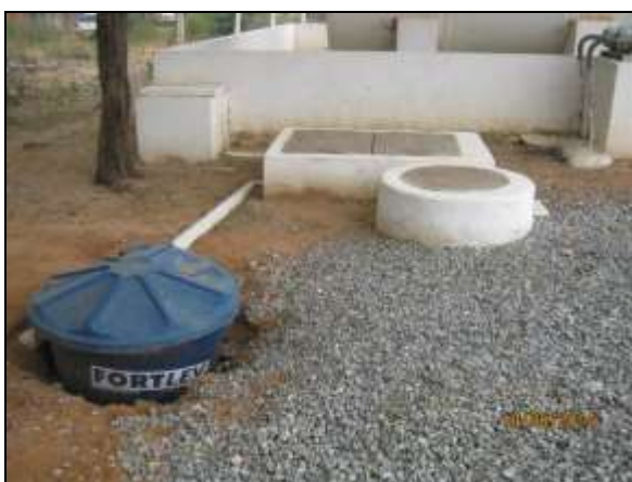
Foto 4.2.409. Separador de água e óleo do posto de abastecimento com manutenção adequada (jun/2014).
