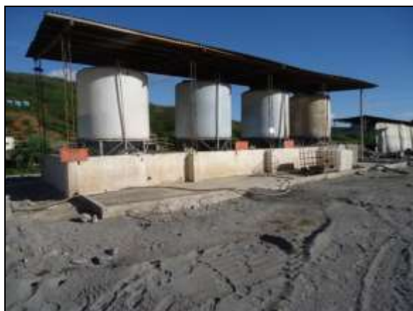
Foto 4.2.660. Bacia de contenção de aditivos implantada na frente de serviço da janela do túnel Cuncas I (abr/2014).
