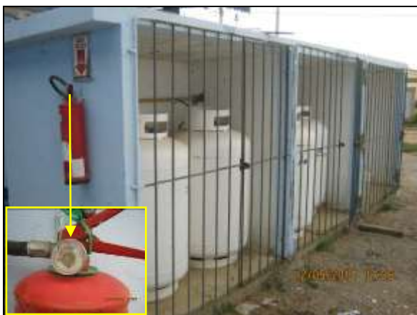
Foto 4.2.19. Extintor de incêndio disponível na baia de armazenamento dos botijões da cozinha industrial do canteiro de obras em Cabrobó - PE (maio/2014).
