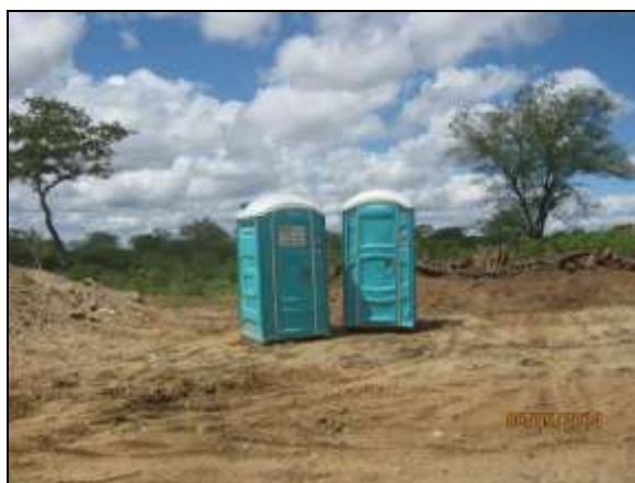
Foto 4.2.545. Banheiros químicos disponíveis na frente de serviço do emboque do túnel Monteiro (maio/2014).
