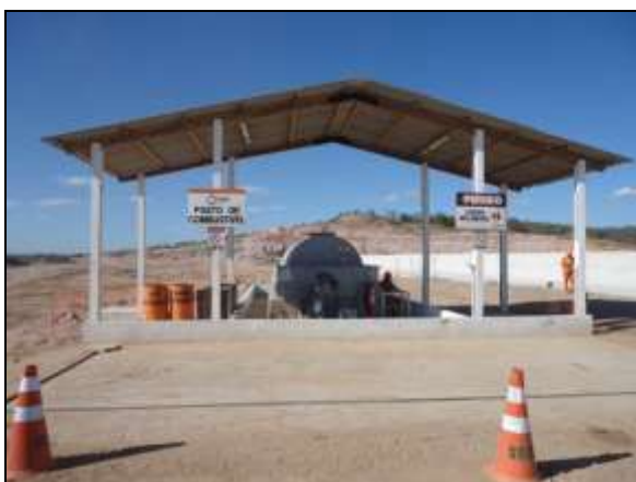
Foto 4.2.196. Posto de abastecimento instalado na frente de serviço do reservatório Cipó - WBS 1115 (jul/2014).
