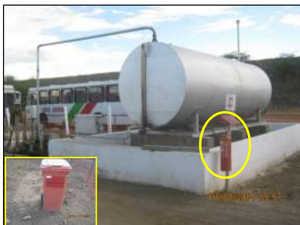
Foto 4.2.343. Extintor de incêndio disponível nas imediações do posto de combustível do canteiro de apoio da EBI-01 (abr/2014).
