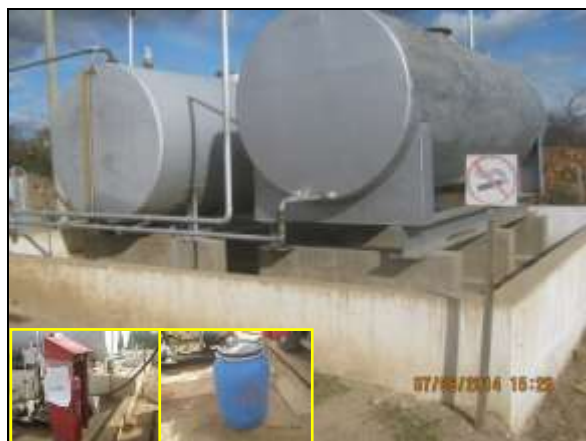
Foto 4.2.371. Disponibilidade de extintor de incêndio e kit mitigação nas adjacências do posto de combustível do canteiro de obras (ago/2014).
