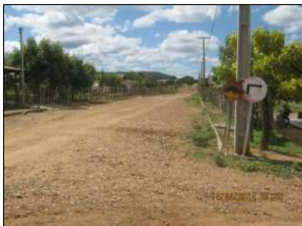
Foto 4.2.682. Via interna da VPR em adequado estado de conservação e com dimensionamento adequado (abr/2014).
