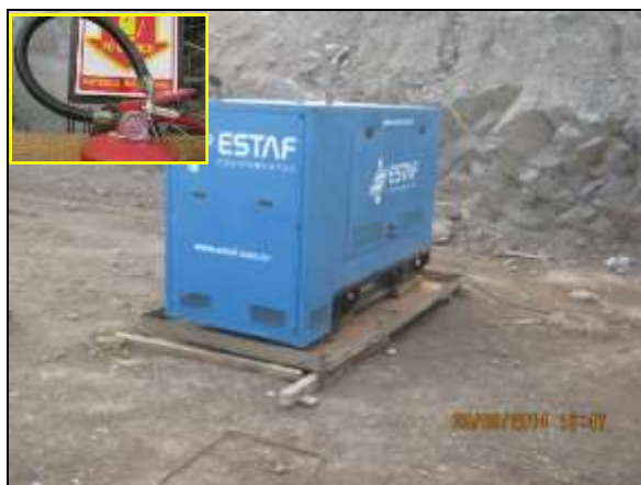
Foto 4.2.78. Gerador sobre bandeja de contenção e extintor de incêndio nas adjacências da frente de serviço da estrutura de controle do reservatório Serra do Livramento – WBS 1107 (set/2014).
