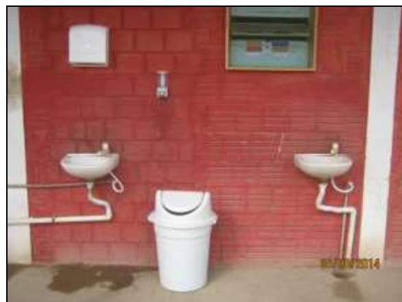
Foto 4.2.433. Lavatórios com estruturas adequadas disponíveis na entrada do refeitório (ago/2014).
