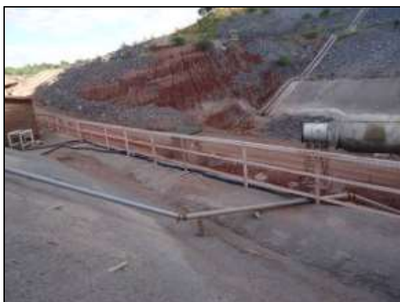
Foto 4.2.599. Instalação de guarda-corpo na frente de serviço do emboque do túnel Cuncas I - WBS 1410 (jun/2014).
