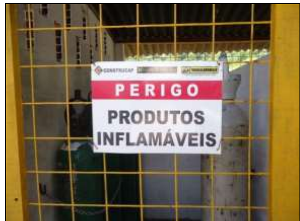
Foto 4.2.571.Central de armazenamento de acetileno e oxigênio devidamente sinalizada na frente de serviço do emboque do túnel Cuncas I - WBS 1410 (maio/2014).
