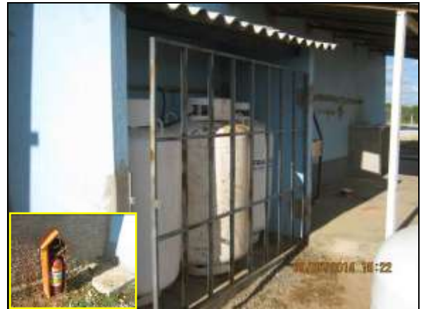
Foto 4.2.61. Botijões de gás GLP da cozinha do canteiro de obras armazenados de forma adequada e extintor de incêndio disponível na área (jun/2014). Foto 4.2.62.
