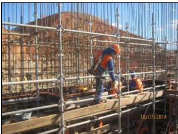
Foto 4.2.258. Colaboradores realizando atividade em altura utilizando cinto talabarte na frente de serviço do aqueduto Catingueira (jul/2014).
