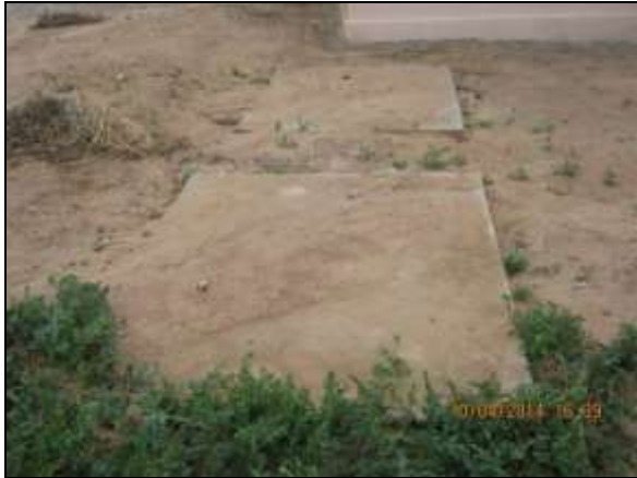
Foto 4.2.741. Sistema de tratamento de efluentes da estrutura de apoio composto por fossa séptica e sumidouro (abr/2014).
