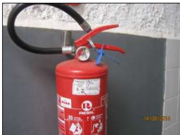
Foto 4.2.392. Equipamento contra incêndio disponibilizado na cozinha do canteiro de obras (ago/2014).
