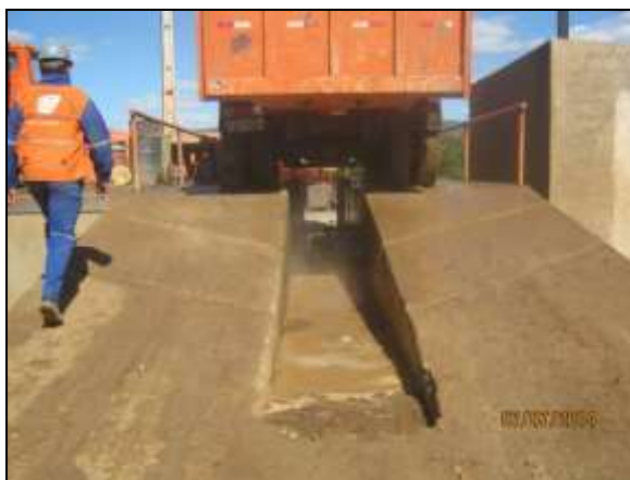
Foto 4.2.310. Lava-jato com pista impermeabilizada e canaletas ligadas ao SAO no canteiro central do antigo Lote 06 (set/2014).
