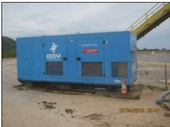
Foto 4.2.75. Gerador da central de concreto do WBS 1214 disposto sobre bandeja de contenção e com extintor de incêndio (abr/2014).
