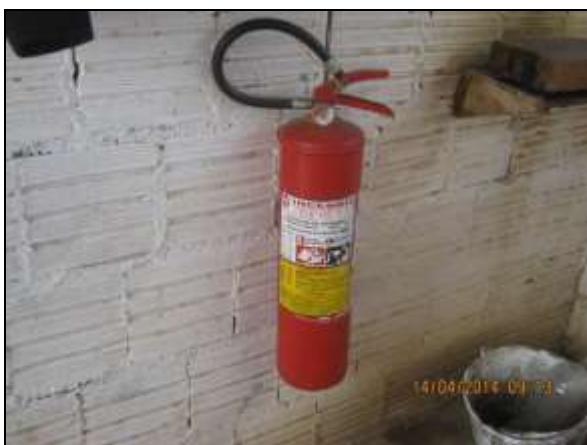
Foto 4.2.689. Extintor de incêndio disponível na estrutura de apoio da VPR (abr/2014).
