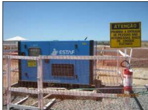
Foto 4.2.425. Extintor de incêndio em condições de uso disponibilizado em gerador nas frentes de serviços (ago/2014).
