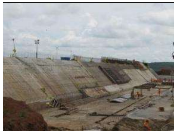
Foto 4.3.87. Construção do Vertedouro do reservatório Jati, localizado no município de Jati – CE, Meta 2N (mai/2014).
