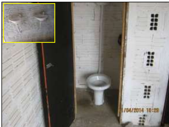
Foto 4.2.675. Gabinete sanitário em condições adequadas de limpeza e disponibilidade de lavatórios na estrutura de apoio (abr/2014).
