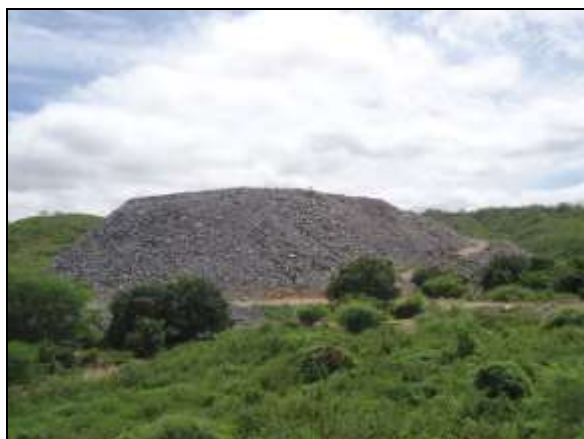
Foto 4.2.663. Bota-fora de material de 3ª categoria na frente de serviço da janela do túnel Cuncas I - WBS 1410 (jul/2014).
