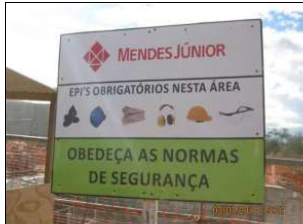
Foto 4.2.94. Placa de sinalização quanto ao uso obrigatório dos EPI na frente de serviço da estrutura de controle do reservatório Tucutú – WBS 1105 (jul/2014).
