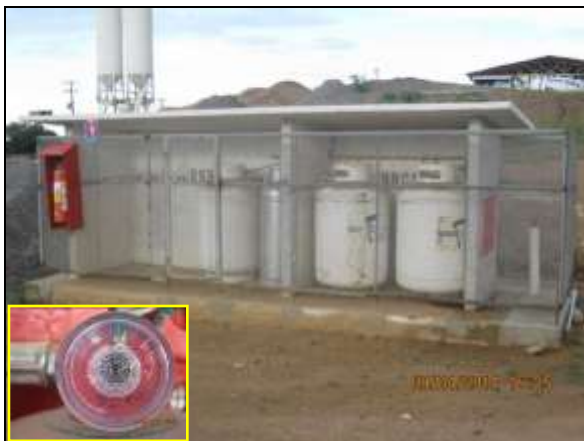
Foto 4.2.101. Extintor de incêndio disponibilizado na baia com armazenamento dos botijões de gás da cozinha do canteiro de obras de Penaforte - CE (abr/2014).
