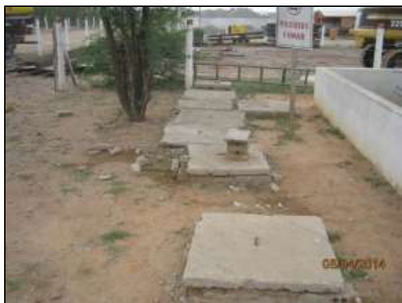
Foto 4.2.454. Sistema de tratamento do posto de abastecimento do canteiro de obras com manutenção adequada (abr/2014).
