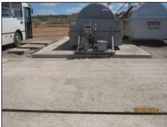
Foto 4.2.443. Posto de abastecimento da EBV-03 com estruturas adequadas (ago/2014).
