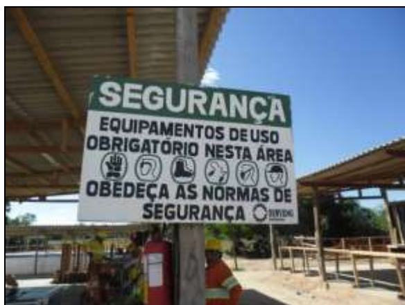
Foto 4.2.143. Placa de uso obrigatório de EPI implantada na carpintaria da estrutura de apoio da frente de serviço do vertedouro Porcos – WBS 1113 (jun/2014).
