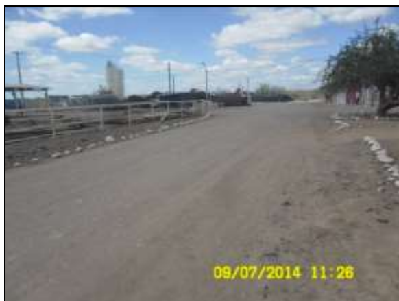
Foto 4.2.415. Via de circulação do canteiro de obras em bom estado de conservação (jul/2014).
