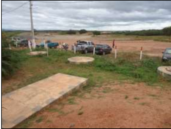
Foto 4.2.324. Fossa/sumidouro implantados para atender as instalações do alojamento do canteiro do antigo Lote 06 (jun/2014).
