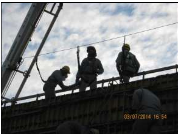
Foto 4.2.10. Colaboradores da frente de serviço do aqueduto Saco da Serra - WBS 1306 em atividade de altura utilizando EPI e cintos de segurança (jul/2014).
