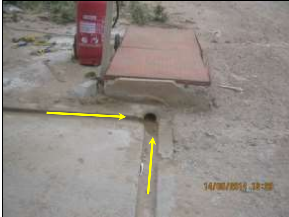
Foto 4.2.79. Canaletas para direcionamento dos efluentes ao SÁO do posto de combustível na frente de serviço do WBS 1214 (maio/2014).
