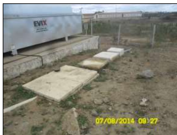
Foto 4.2.551. Separador de Água e Óleo do posto de abastecimento em condições adequadas de manutenção (ago/2014).
