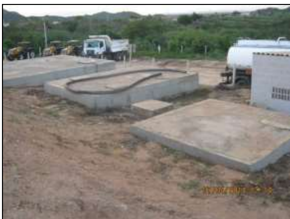
Foto 4.2.125.Sistema de tratamento de efluentes do canteiro de obras de Salgueiro - PE seguido de filtro anaeróbico (abr/2014).
