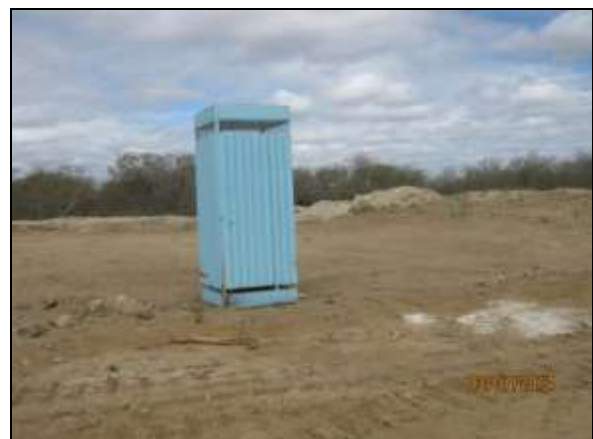
Foto 4.2.499. Banheiro químico disponibilizado nas frentes de serviços (jul/2014).
