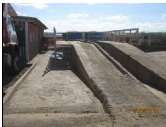
Foto 4.2.437. Lava-jato com piso impermeabilizado e sistema de contenção (jun/2014).
