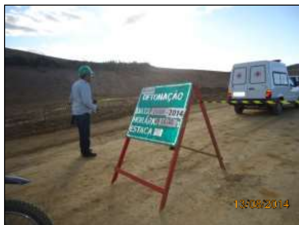
Foto 4.2.134. Técnico de Segurança do Trabalho e ambulância em frente ao bloqueio da via de acesso à pedreira próxima à área do reservatório Milagres – WBS 1110 (ago/2014).
