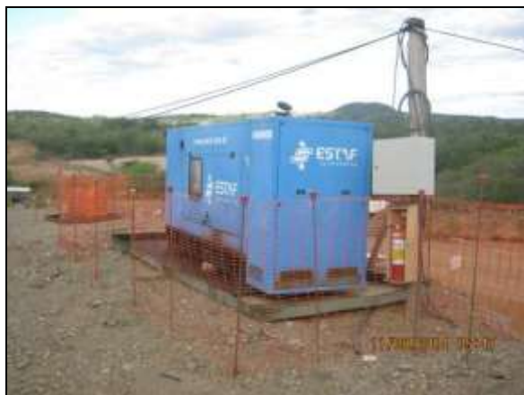
Foto 4.2.76. Gerador sobre bandeja de contenção na frente de serviço do aqueduto Salgueiro – WBS 1309 (jun/2014).
