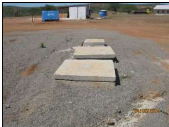
Foto 4.2.455. Sistema de tratamento de efluentes disponibilizado no posto de abastecimento da EBV-03 (jun/2014).
