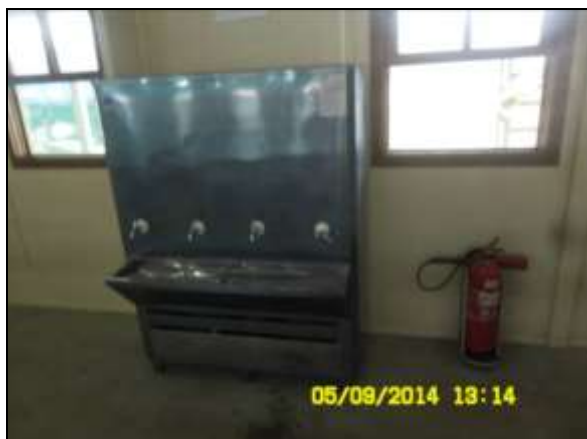
Foto 4.2.434. Bebedouro instalado no refeitório do canteiro de obras da EBV-03 (set/2014)
