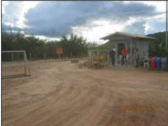
Foto 4.2.339. Guarita com vigilância permanente para controle do acesso de pessoas e veículos ao canteiro de obras (maio/2014).
