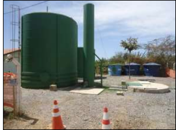
Foto 4.2.325. ETE que atende as instalações do canteiro central do antigo Lote 07 (ago/2014).
