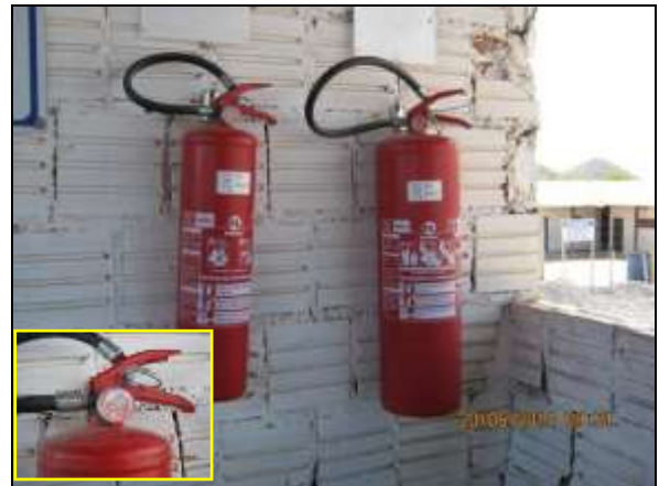
Foto 4.2.721. Extintores de incêndio em condições adequadas de uso disponibilizados na estrutura de apoio (jun/2014).
