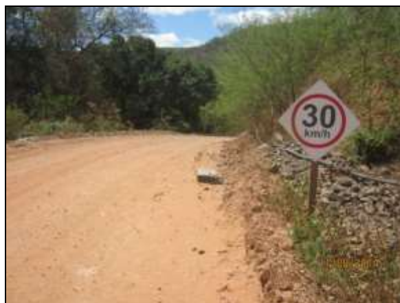
Foto 4.2.574. Placa de limite de velocidade em via de acesso ao emboque do túnel Cuncas I (ago/2014).
