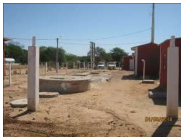
Foto 4.2.449. Sistema de tratamento de esgoto do canteiro de obras com manutenção adequada (ago/2014).
