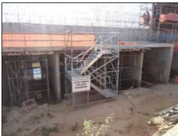
Foto 4.2.259. Escada atendendo aos padrões de segurança, disponível aos colaboradores da frente de serviço do bueiro Palha (ago/14).
