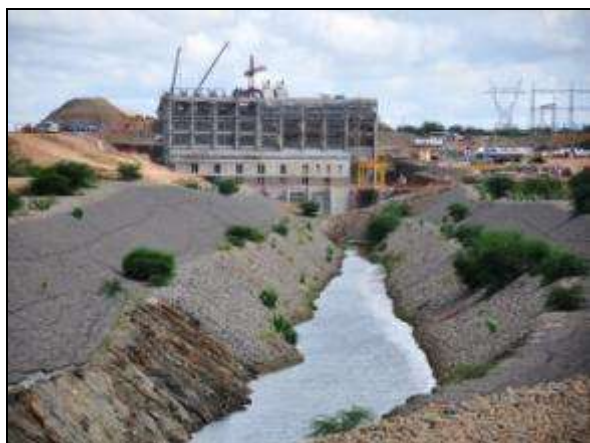
Foto 4.3.80. Estação de bombeamento EBI-1, localizada no município de Cabrobó - PE, Lote 8 (abr/2014).
