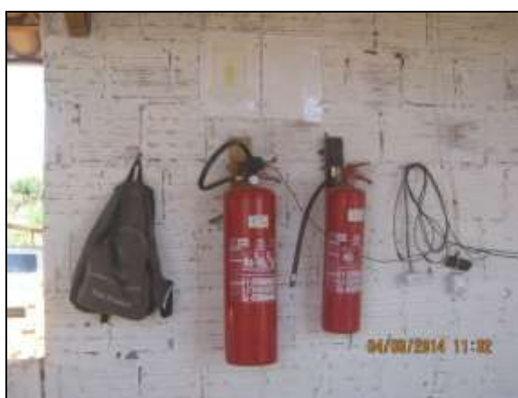
Foto 4.2.671. Extintores de incêndio disponíveis na estrutura de apoio (jun/2014).
