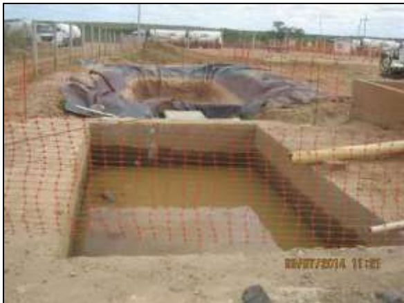
Foto 4.2.81. Tratamento dos efluentes provenientes da oficina mecânica, lava-jato e posto de abastecimento do canteiro de obras (jul/2014).
