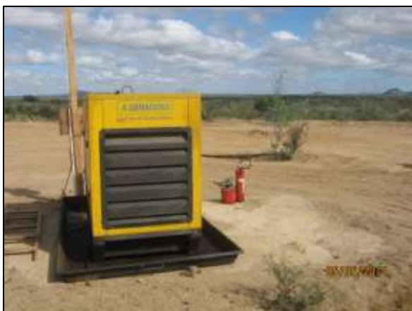
Foto 4.2.458. Bandeja coletora e extintor de incêndio disponibilizados em grupo gerador na frente de serviço (jun/2014).
