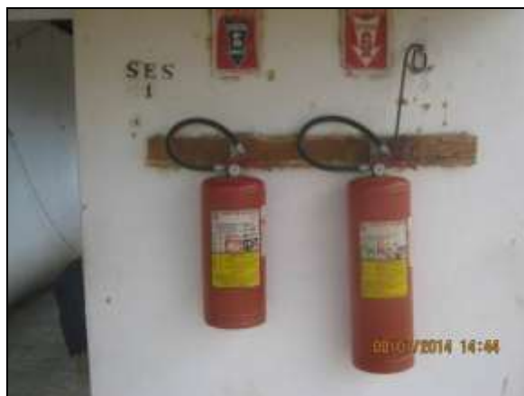
Foto 4.2.751. Extintores de incêndio disponíveis na estrutura de apoio (jul/2014).
