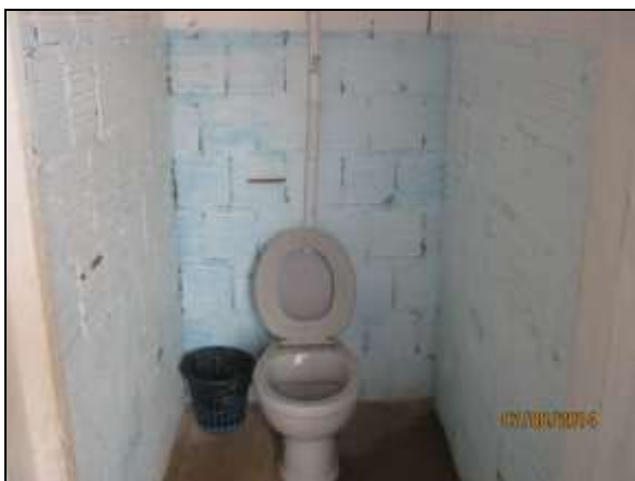
Foto 4.2.813. Instalações sanitárias na estrutura de apoio em condições adequadas de limpeza (ago/2014).
