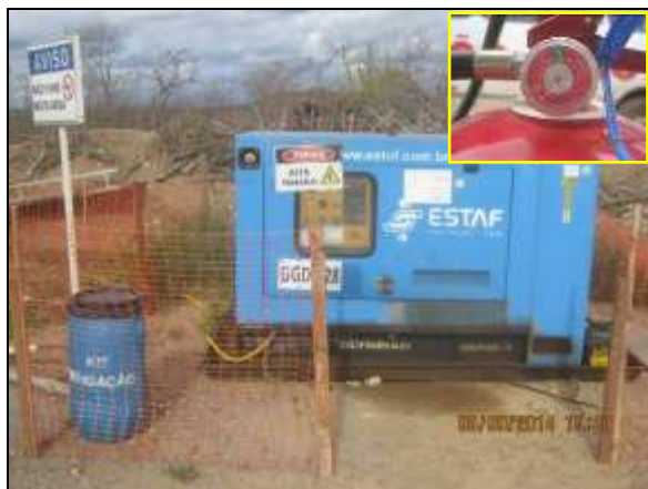
Foto 4.2.124.Gerador na estrutura de apoio do reservatório Milagres - WBS 1110 disposto em bandeja de contenção com kit mitigação e extintor de incêndio disponíveis nas proximidades (set/2014).
