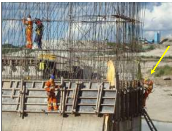
Foto 4.2.158. Colaboradores em atividade de altura utilizando devidamente os EPI no vertedouro do reservatório Porcos – WBS 1113 (mai/14).
