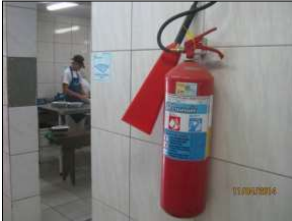
Foto 4.2.524. Extintor de incêndio em condições de uso fixado na cozinha (abr/2014).
