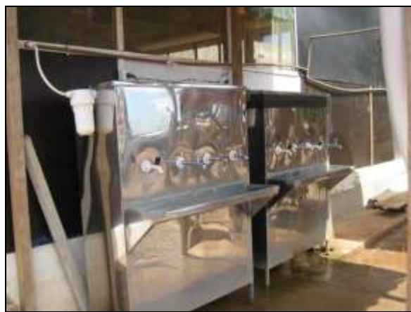
Foto 4.2.193. Bebedouros disponíveis aos colaboradores na estrutura de apoio da frente de serviço do reservatório Canabrava - WBS 1114 (ago/2014).
