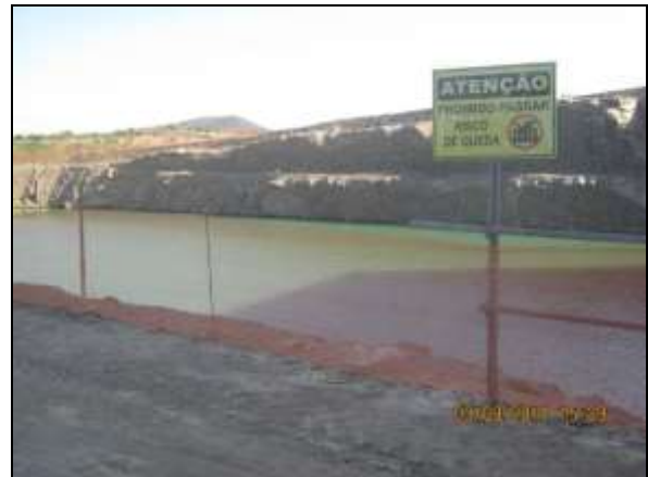
Foto 4.2.342. Tela e placa de sinalização quanto ao risco de queda em segmento de corte próximo à frente de serviço da EBI-01 (set/2014).
