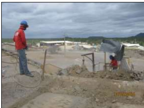
Foto 4.2.483. Colaborador em atividade com uso adequado de EPI no canteiro de obras (maio/2014).
