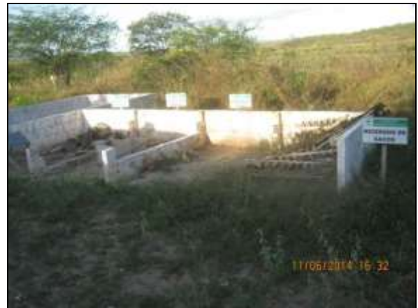
Foto 4.2.759. Baias para armazenamento temporário de resíduos (jun/2014).
