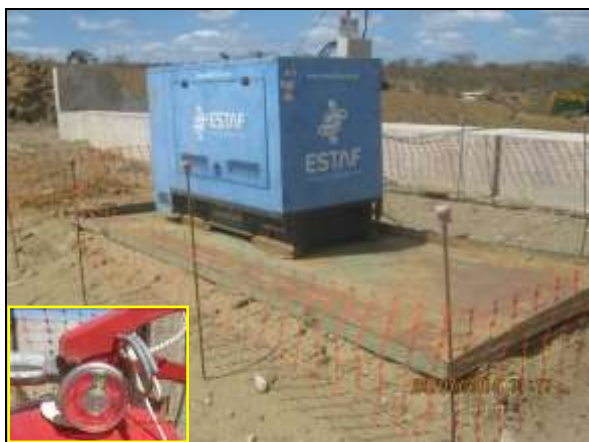
Foto 4.2.77. Gerador disposto em bandeja de contenção e extintor de incêndio disponível na frente de serviço do vertedouro do reservatório Mangueira – WBS 1108 (jul/2014).
