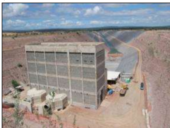
Foto 4.3.97. Estação de Bombeamento EBV-1, localizado no município de Floresta - PE, Meta 1L (set/2014).
