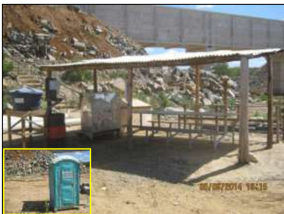
Foto 4.2.23. Estrutura de apoio da frente de serviço do aqueduto Logradouro – WBS 1305 com mesas, assentos, bebedouro, lavatório, coletor de resíduos e banheiro químico (jun/2014).
