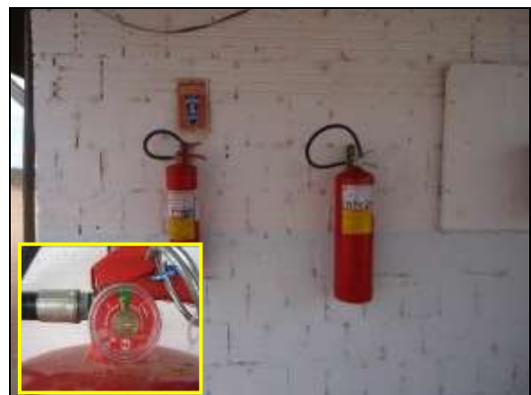
Foto 4.2.805. Extintores de incêndio disponíveis na estrutura de apoio (set/2014).
