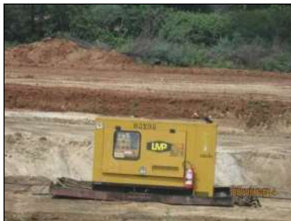
Foto 4.2.560. Gerador utilizado no reservatório Moxotó disposto sobre bandeja coletora (maio/2014).
