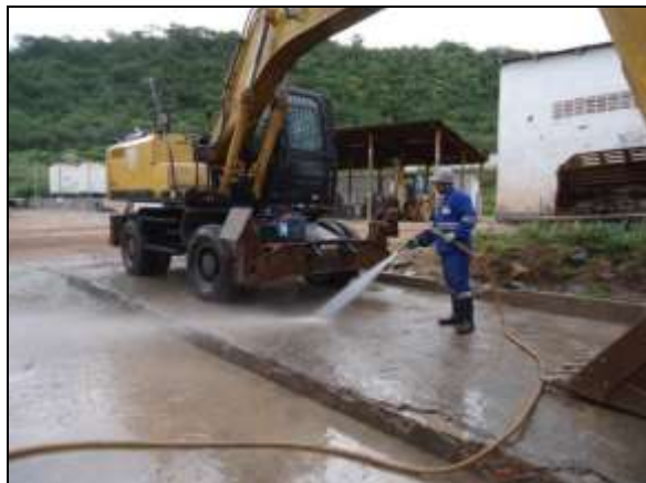
Foto 4.2.658. Lava-jato instalado na frente de serviço do emboque do túnel Cuncas I (maio/2014).
