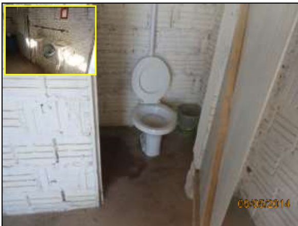
Foto 4.2.722. Gabinete sanitário e lavatórios disponíveis na estrutura de apoio da VPR (maio/2014).
