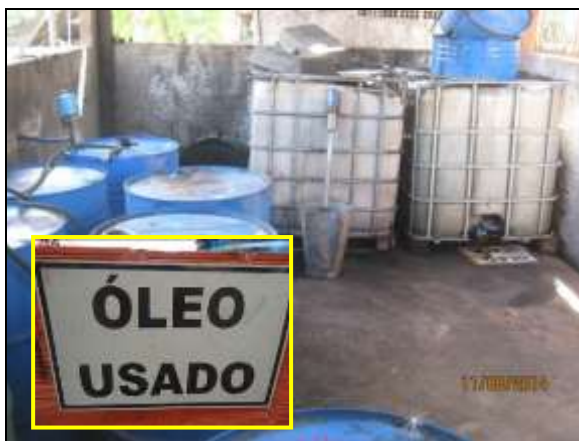
Foto 4.2.657. Baia para armazenamento de óleo lubrificante com canaletas ligadas ao SAO na frente de serviço da janela do túnel Cuncas I (ago/2014).
