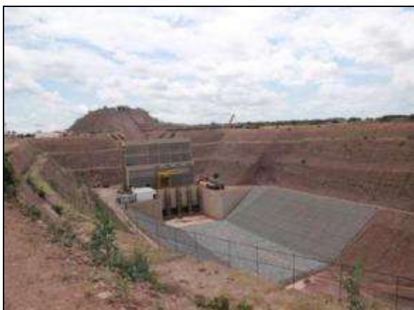
Foto 4.3.92. Estação de bombeamento EBV-1, localizada no município de Floresta - PE, Meta 1L (abr/2014).
