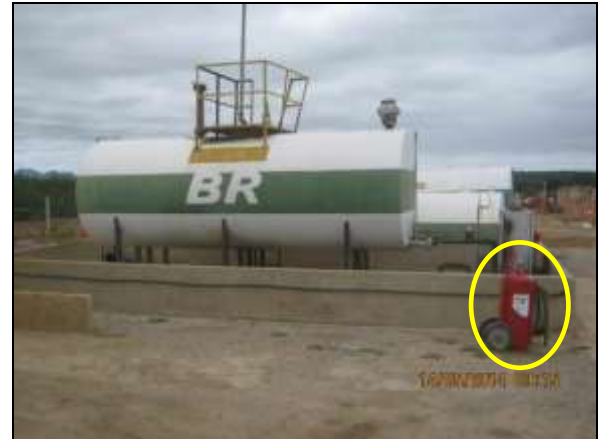
Foto 4.2.52. Disponibilidade de extintor de incêndio nas adjacências do posto de combustível no canteiro de obras em Umãs, Salgueiro – PE (maio/2014).
