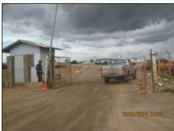
Foto 4.2.41. Guarita com vigilância para controle do acesso de pessoas e veículos ao canteiro de obras no
