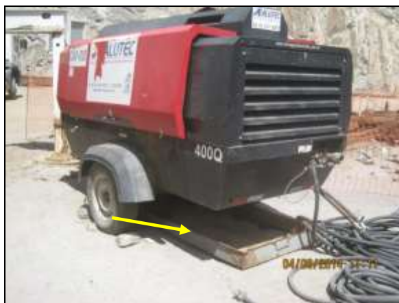
Foto 4.2.374. Disponibilidade de bandeja de contenção sob compressor instalado na frente de serviço da EBI-03 (ago/2014).
