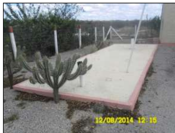
Foto 4.2.503. Tanque séptico em condições adequadas de manutenção (ago/2014).
