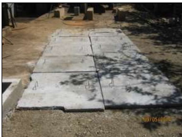
Foto 4.2.508. Separador de água e óleo do lava-jato, oficina mecânica e baía de resíduos perigosos com manutenção adequada (maio/2014).
