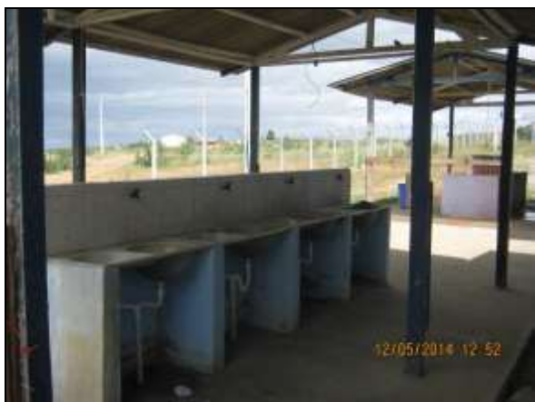
Foto 4.2.15. Área de serviço em estado adequado de conservação disponibilizada aos colaboradores alojados no canteiro de obras (maio/2014).
