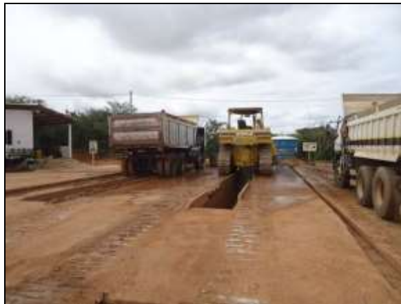
Foto 4.2.200. Lave-jato com pista impermeabilizada e canaletas ligadas ao SAO no canteiro de obras central (jul/2014).
