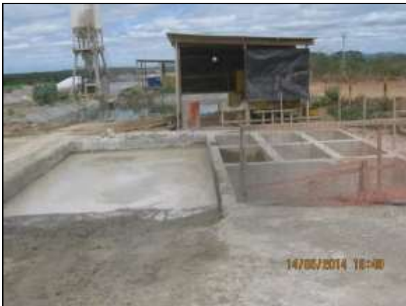
Foto 4.2.381. Tanque de decantação da central de concreto da EBI-02 em condições adequadas de funcionamento (maio/2014).
