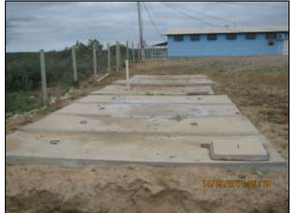
Foto 4.2.80. Sistema de tratamento de efluentes do canteiro de obras de Umãs constituído por fossa séptica seguida de sumidouro (maio/2014).
