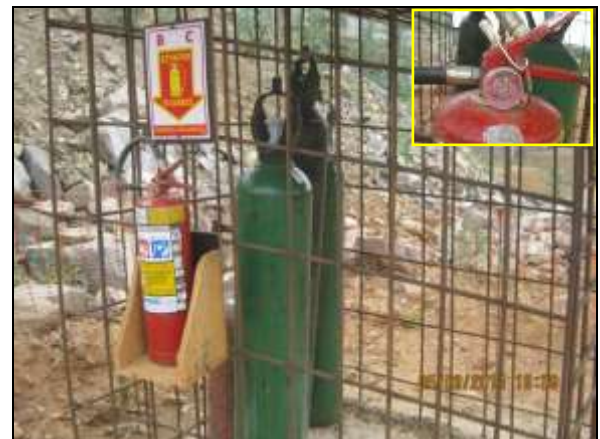
Foto 4.2.54. Extintor de incêndio próximo à baia de armazenamento de oxi-acetileno na frente de serviço do aqueduto Salgueiro – WBS 1309 (set/2014).
