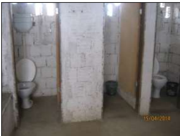
Foto 4.2.829. Condições adequadas de limpeza dos lavatórios e sanitários do banheiro da estrutura de apoio (abr/2013).
