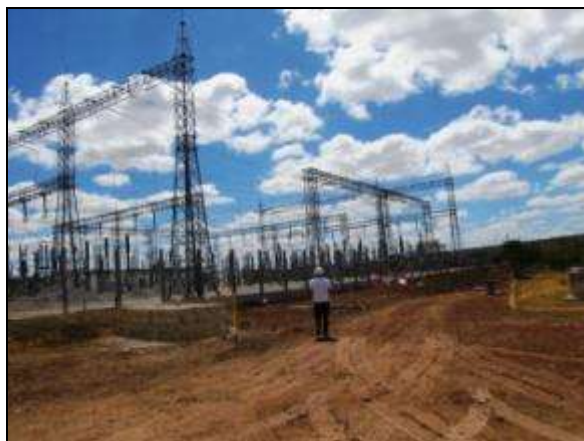
Foto 4.3.95. Subestação Elétrica, EBV-01, Meta 1L/2L (jul/2014).
