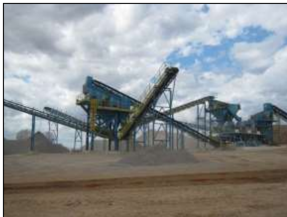
Foto 4.2.208. Britador em funcionamento na área do reservatório Canabrava – WBS 1114 (ago/2014).
