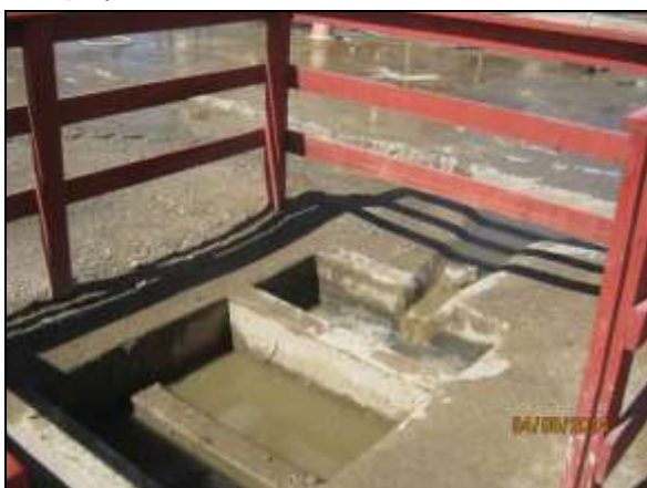
Foto 4.2.460. Sistema de tratamento da central de concreto do canteiro de obras com funcionamento adequado (ago/2014).
