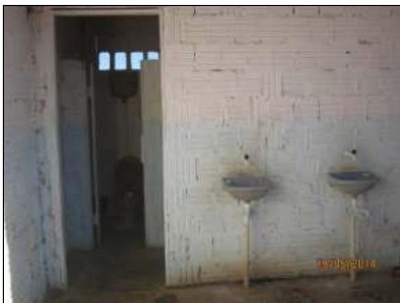
Foto 4.2.792. Lavatórios disponíveis na estrutura de apoio do setor residencial 01 (maio/2014).
