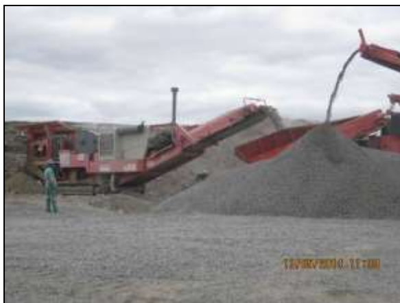
Foto 4.2.383. Britador em operação com beneficiamento de material de 3ª categoria (bota-espere) na área de formação do reservatório Negreiros – WBS 1109 (maio/2014).
