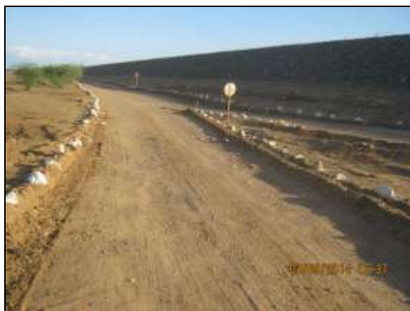
Foto 4.2.338. Estrada de acesso ao canteiro de apoio e frentes de serviço da EBI-01 em condições favoráveis de manutenção e conservação (set/2014).
