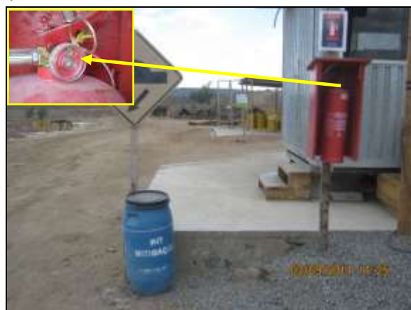
Foto 4.2.346. Extintor de incêndio em condições de uso disponível na área de serviço da central de concreto da EBI-02 (set/2014).
