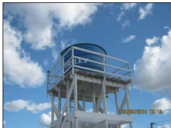
Foto 4.2.356. Reservatório com água fornecida pela COMPESA para abastecimento do canteiro de obras (jun/2014).
