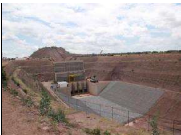
Foto 4.3.96. Estação de Bombeamento EBV-1, localizado no município de Floresta - PE, Meta 1L (abr/2014).
