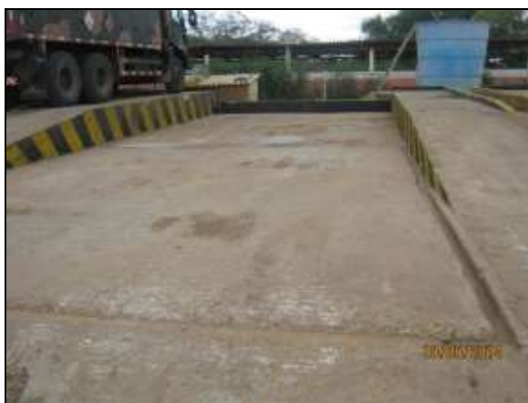
Foto 4.2.401. Lava-jato com pista impermeabilizada e canaleta ligada ao SAO (jun/2014).
