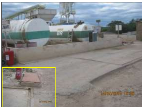
Foto 4.2.66. Posto de combustível da central de concreto do segmento WBS 1210 com bacia de contenção, piso impermeável e canaletas interligadas ao sistema SAO (maio/2014).
