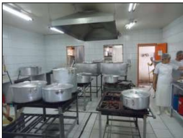
Foto 4.2.297. Cozinha do canteiro de obras central em condições adequadas de funcionamento (antigo Lote 07) (ago/2014).
