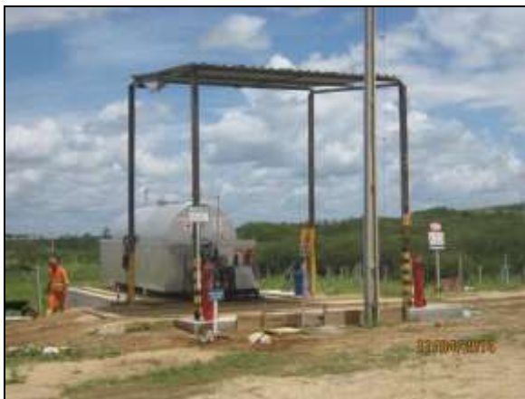
Foto 4.2.540. Posto coberto, com piso impermeabilizado, bacia de contenção e canaletas ligadas ao SAO (abr/2014).
