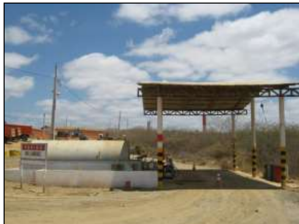
Foto 4.2.306. Posto de abastecimento implantado no canteiro central do antigo Lote 07, com área coberta, canaleta e sistema de tratamento de efluentes (set/2014).
