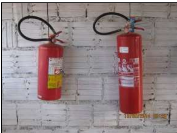
Foto 4.2.702. Extintores de incêndios em condições adequadas para uso na estrutura de apoio (maio/2014).
