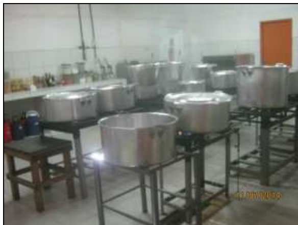
Foto 4.2.295. Cozinha do canteiro de obras central em condições adequadas de funcionamento (antigo Lote 06) (jul/2014).
