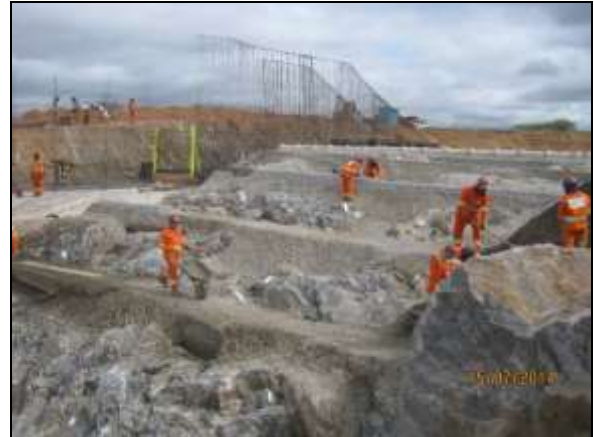
Foto 4.2.525. Uso adequado dos EPI por colaboradores durante atividade no vertedouro do reservatório Moxotó (jul/2014).
