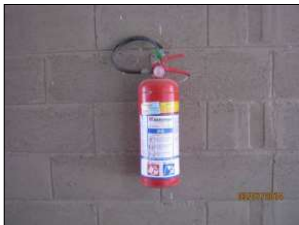
Foto 4.2.484. Extintor em condições de uso disponibilizado no canteiro de obras (jul/2014).
