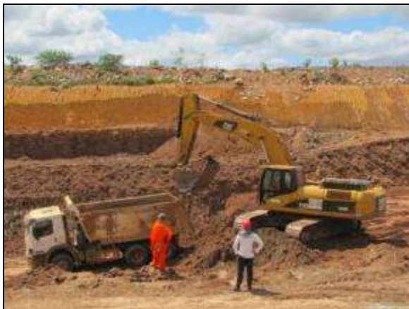
Foto 4.3.104. Técnico do INAPAS acompanha atividade de terraplenagem no reservatório Milagres (Meta 1N), no município de Verdejante - PE (maio/2014).
