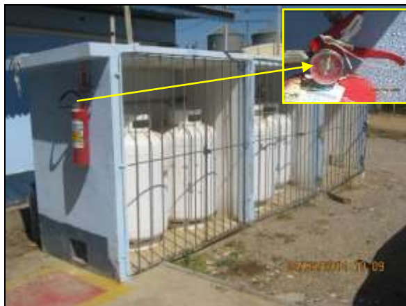
Foto 4.2.9. Extintor disponível na baia de armazenamento dos botijões de gás da cozinha do canteiro de obras de Cabrobó - PE (jun/2014).
