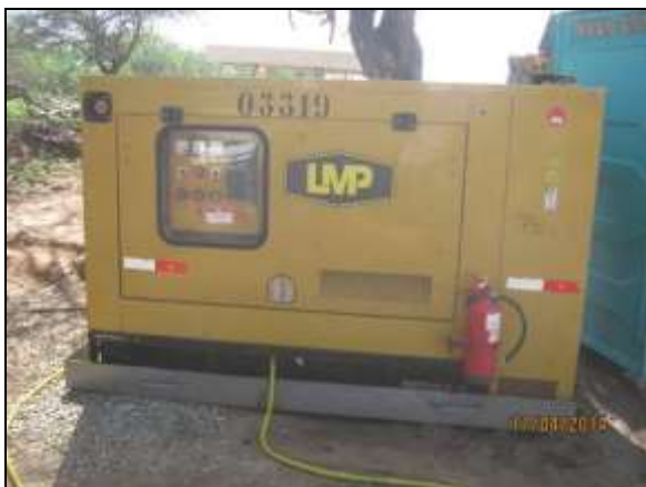
Foto 4.2.559. Bandeja de contenção de grupo gerador nas frentes de serviços do reservatório Moxotó (abr/2014).
