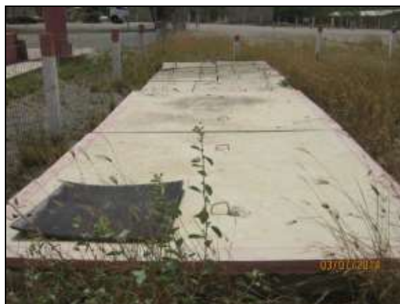
Foto 4.2.509. São e tanque de decantação do posto de abastecimento com manutenção adequada (jul/2014).
