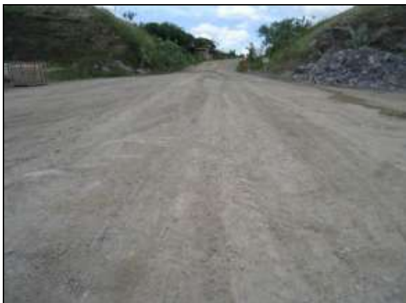
Foto 4.2.566. Via de acesso túnel Cuncas I - WBS 1410 na frente de serviço do desemboque em boas condições de trafegabilidade (abr/2014).
