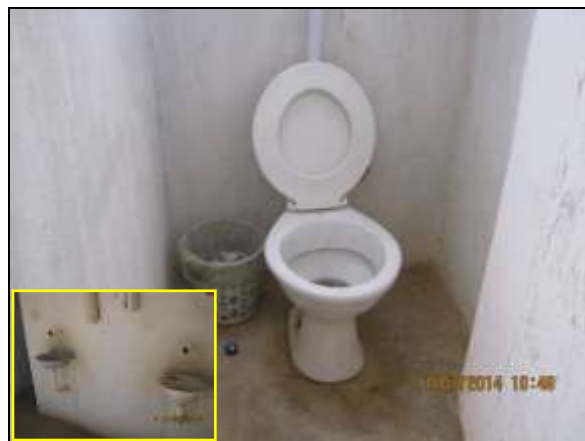
Foto 4.2.740. Gabinete sanitário e lavatórios em condições adequadas de limpeza na estrutura de apoio (jul/2014).
