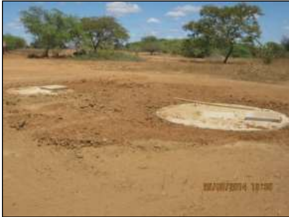
Foto 4.2.848. Sistema de tratamento de efluentes recém instalada nas proximidades da estrutura de apoio (ago/2014).
