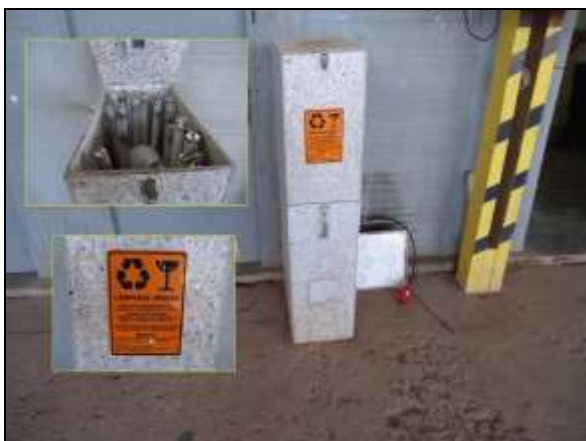
Foto 4.2.652. Coletores para descarte de lâmpadas, pilhas e baterias na estrutura de apoio do emboque do túnel Cuncas I (abr/2014).
