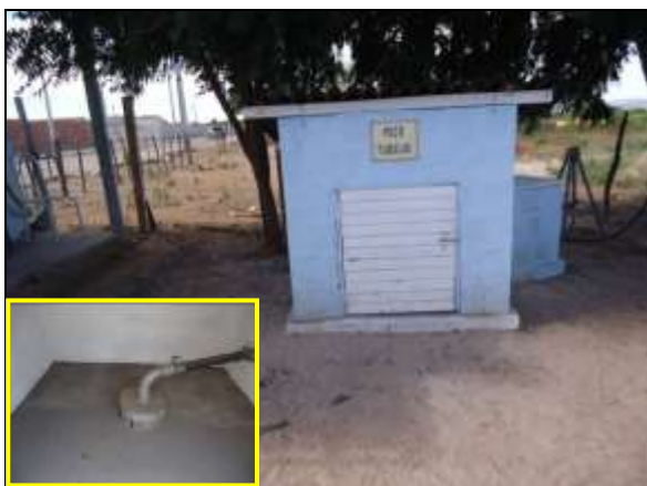
Foto 4.2.639. Estrutura do poço tubular profundo que abastece o alojamento/refeitório em Mauriti - CE devidamente protegida conforme NBR 12244 (jun/2014).
