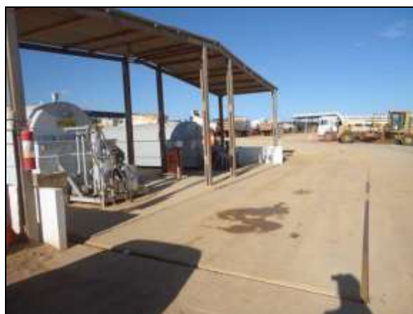
Foto 4.2.197. Posto de abastecimento instalado na frente de serviço do reservatório Porcos (jul/2014).
