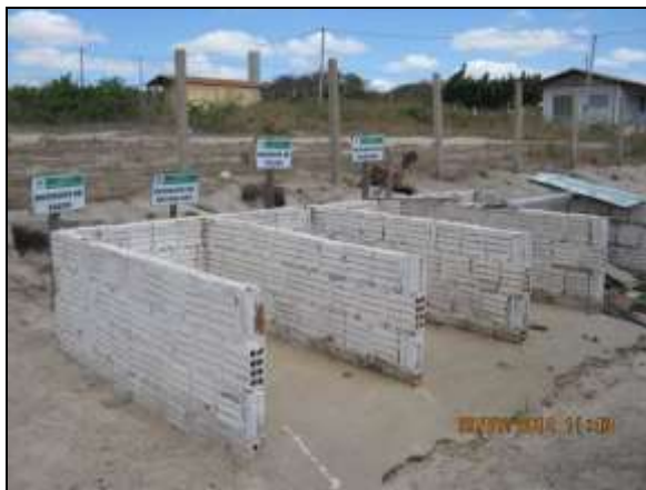
Foto 4.2.726. Baias seletivas para armazenamento temporário dos resíduos (jul/2014).
