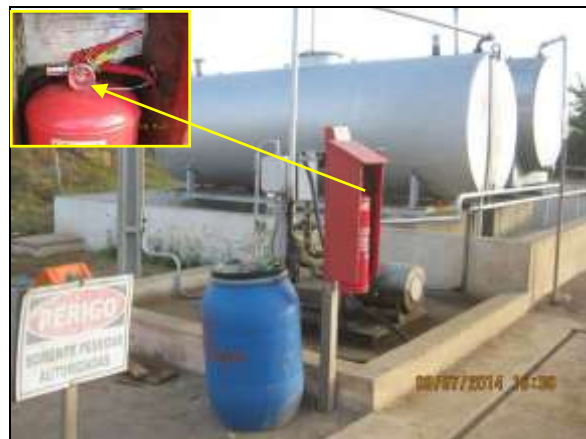
Foto 4.2.348. Extintor de incêndio próximo ao posto de combustível do canteiro de obras (jul/2014).
