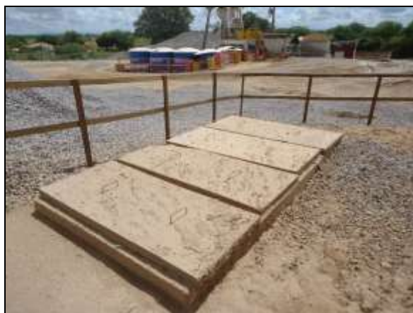
Foto 4.2.126.Caixas do sistema SAO do lava-jato e rampa de lubrificação do canteiro de obras de Penaforte - CE (maio/2014).
