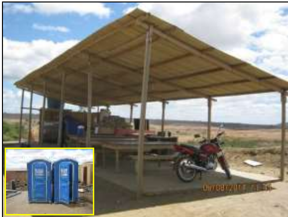
Foto 4.2.71. Estrutura de apoio disponibilizada aos colaboradores da frente de serviço do vertedouro do reservatório Mangueira - WBS 1108 (ago/2014).
