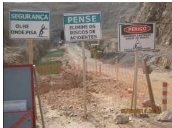
Foto 4.2.96. Placas de sinalização quanto à atenção aos riscos de acidentes na área de serviço do Túnel Milagres/Jati – WBS 1403 (set/2014).
