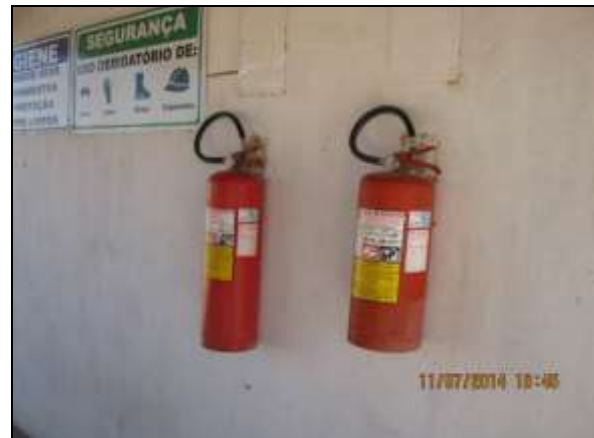
Foto 4.2.736. Extintores de incêndio disponibilizados na estrutura de apoio (jul/2014).
