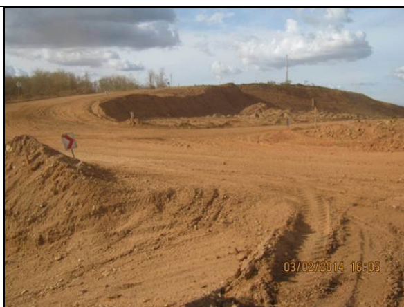
Foto 17. Estrada vicinal em funcionamento por acesso provisório, aguardando o início das atividades construtivas da ponte WBS 1518 (EN-I-100).
