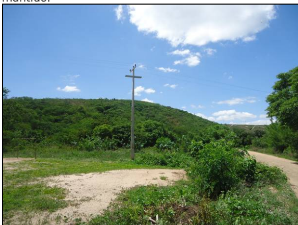
Foto 25. Rede elétrica (EN-II-006-RPO) aguardando relocação, interior do reservatório Porcos.
