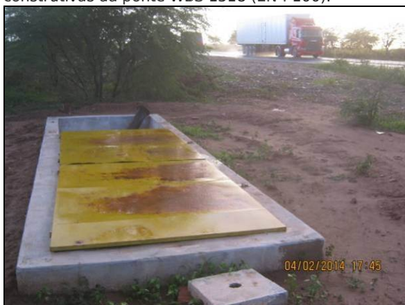
Foto 19. Adutora D=100mm (EN-I-131) interceptando eixo do canal, aguardando solução.
