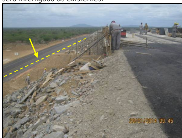
Foto 6. Ponte WBS 1505 em fase final de construção e destaque do desvio provisório para continuidade do tráfego na rodovia federal BR-428 (EN-I-005).
