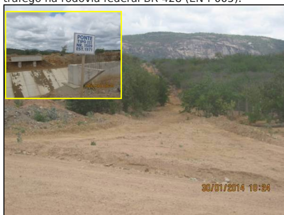
Foto 8. Estrada vicinal (EN-I-032) em funcionamento. Detalhe das atividades construtivas iniciais da ponte WBS 1509.
