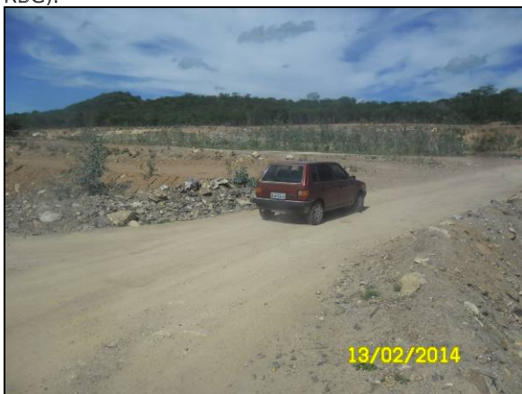
Foto 45. Acesso provisório sobre o canal para continuidade do fluxo da estrada vicinal (EL-V-085).
