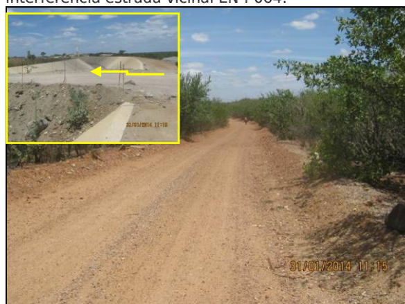
Foto 12. Estrada vicinal (EN-I-057) em funcionamento com desvio provisório. Aguardando implantação da passarela WBS 1561.
