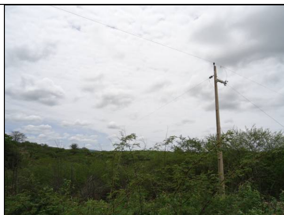
Foto 28. Rede elétrica (EN-II-107-RCC) aguardando relocação, interior da área do reservatório Boa Vista.
