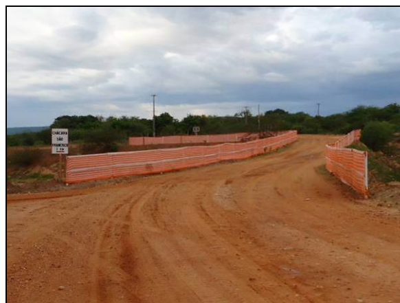
Foto 32. Acesso provisório construído sobre o canal para manutenção do tráfego de pessoas e veículos na estrada vicinal (EN-II-044).
