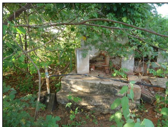
Foto 30. Adutora diâmetro de 200 mm (EN-II-083) em uso. Aguardando relocação.
