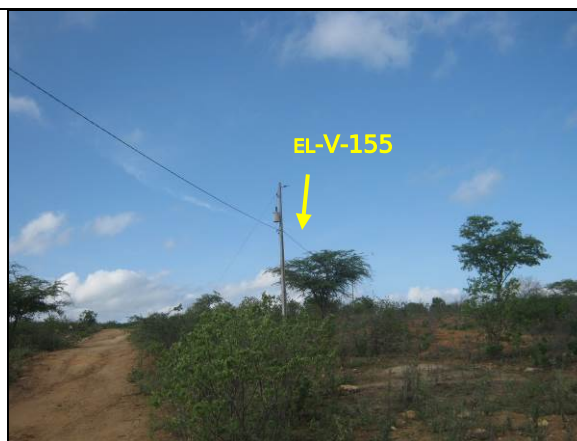
Foto 48. Rede elétrica (EL-V-155-RBA) localizada no interior do reservatório Barreiro.
