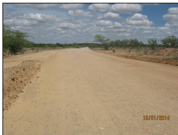
Foto 34. Via de acesso do reservatório Areias permitindo a continuidade do tráfego de pessoas e veículos na estrada vicinal (EL-V-010-RAR).
