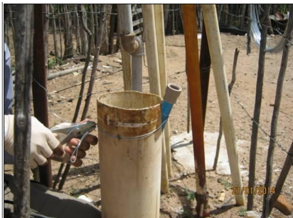
Foto 21. Instalação de tudo guia em poço desativado sem previsão de reativação.
