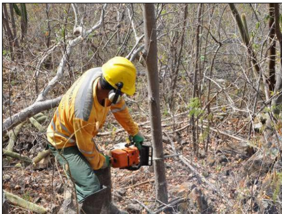
Foto 4.23.195. Supressão manual com uso de motosserra da área do emboque do Túnel Cuncas I no lote 14 (Julho/2012).
