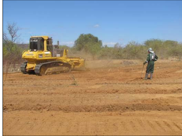
Foto 4.23.198. Acompanhamento da atividade de supressão mecânica do Reservatório Terra Nova no lote 2 (Agosto/2012).
