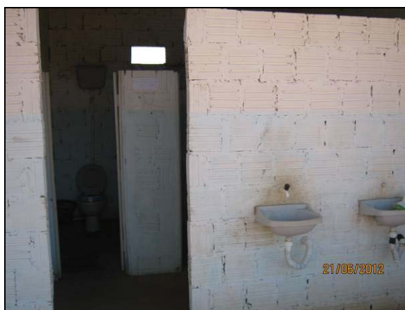
Foto 4.21.325. Banheiro disponível aos colaboradores da obra (jun/2012).
