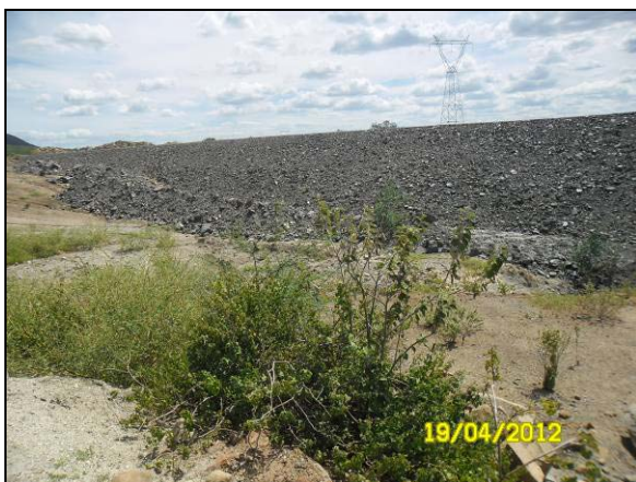
Foto 4.27.53. Enrocamento de talude em canal para dissipação das águas drenadas superficialmente (abr/2012).
