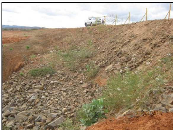
Foto 4.27.59. Enrocamento de talude como medida preventiva a ocorrência de processos erosivos nas adjacências do bueiro 24 (jul/2012).
