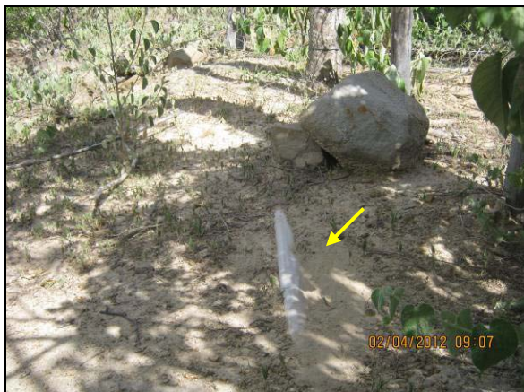
Foto 4.34.8. Adutora de 50 mm (EN-I-076-RMA) no reservatório Mangueira em funcionamento (abr/2012).
