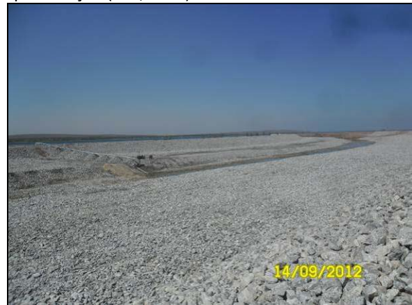
Foto 4.27.10. Enrocamento para dissipação de energia de águas drenadas superficialmente nos taludes do canal de aproximação (set/12).
