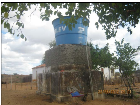
Foto 4.15.1. Reservatório para distribuição de água por gravidade, atendendo apenas 20% das famílias na comunidade Monte Alegre, Salgueiro – PE (jun/2012).
