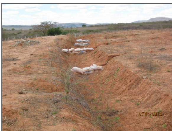
Foto 4.27.122. Canal de escoamento pluvial com dissipadores de energia na jazida 04 (jul/2012).
