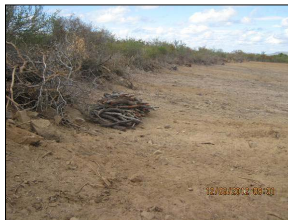
Foto 4.10.3. Acondicionamento do expurgo resultante da supressão mecanizada no limite da área suprimida no WBS 1216 (jun/2012).
