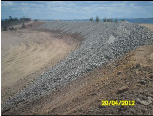
Foto 4.27.7. Enrocamento como método preventivo de erosão nos taludes do canal de aproximação (abr/2012).
