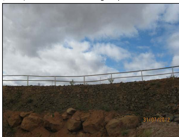
Foto 4.27.61. Enrocamento de talude como método preventivo de erosão nas adjacências do bueiro 22 (jul/2012).
