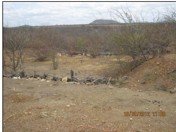
Foto 4.27.21. Cerca paliçada contígua a filtro de rocha como medida de contenção ao carreamento de solo (set/2012).
