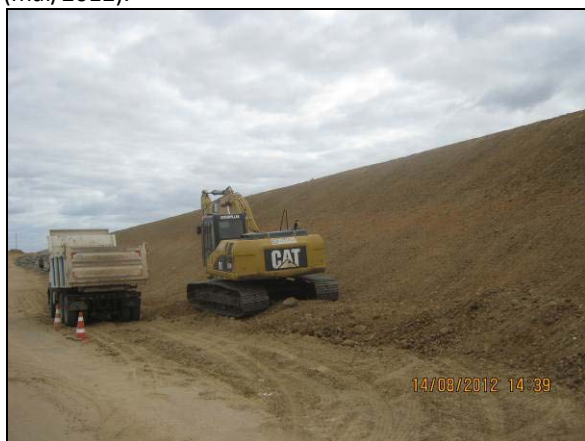
Foto 4.27.37. Extração de camada de excesso de material em talude para posterior disposição de material granular (ago/2012).
