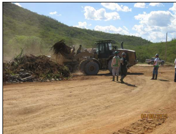
Foto 4.10.91. Retirada de expurgo na área do desemboque do túnel Cuncas II (jun/2012).
