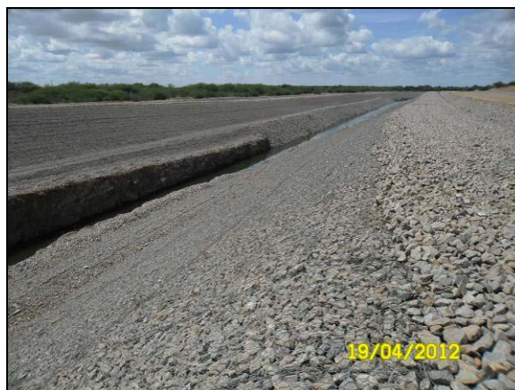
Foto 4.27.2. Conclusão da Instalação de colchão Reno ao longo do canal de aproximação (abr/2012).
