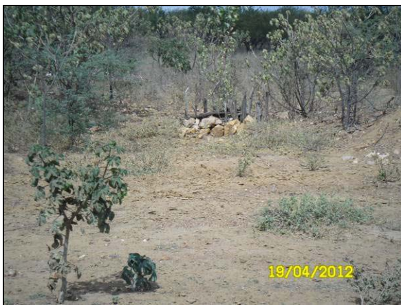
Foto 4.27.16. Medidas de contenção de processos erosivos - cerca paliçada e filtro de rocha implantados (abr/2012).
