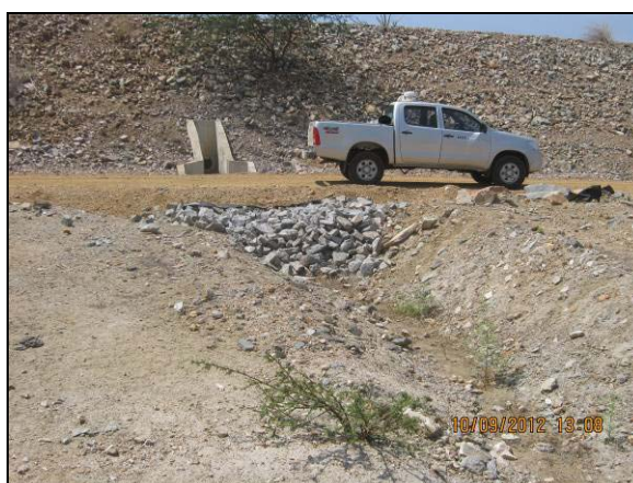
Foto 4.27.28. Filtro de rocha sob via de serviço para escoamento de águas pluviais (set/2012).
