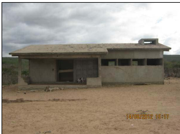
Foto 4.12.1. Posto de saúde com obras paralisadas desde dezembro/2009, aldeia Pereiro, etnia Kambiwá (ago/2012).
