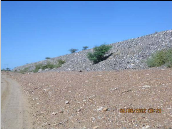
Foto 4.27.18. Cobertura de talude com material granular para dissipação de águas drenadas superficialmente (jun/2012).
