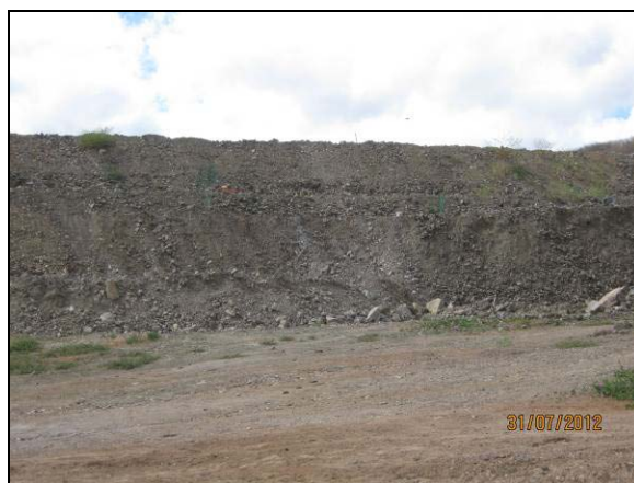
Foto 4.27.62. Enrocamento no talude do canal como medida preventiva a implantação de processos erosivos (jul/2012).
