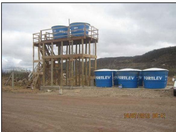
Foto 4.21.121. Reservatórios de água no CCL8 (jul/2012).
