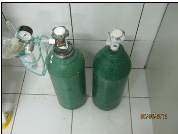
Foto 4.21.160. Cilindros de oxigênio para eventuais emergências no canteiro de obras (mai/2012).
