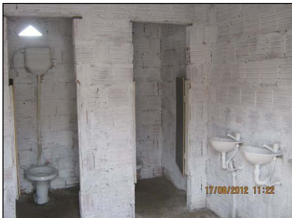
Foto 4.21.291. Banheiros disponíveis aos colaboradores de obras da VPR (ago/2012).
