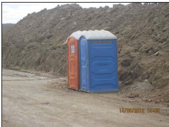
Foto 4.21.50. Banheiro químico disponibilizado aos colaboradores das frentes de obras (ago/2012).
