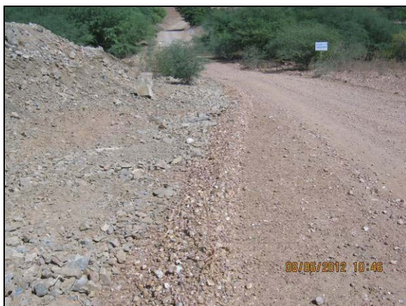
Foto 4.27.57. Reconformação e disposição de material granular adjacente à via de serviço (jun/2012).
