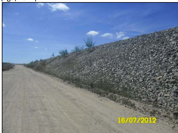
Foto 4.27.85. Talude enrocado, medida preventiva a instalação de processos erosivos e carreamento de solo (jul/2012).
