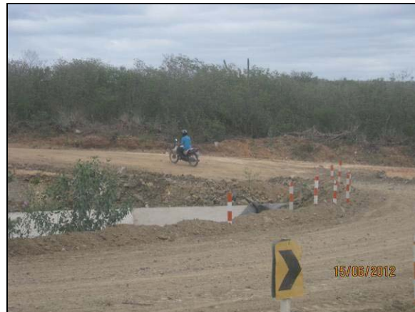
Foto 4.34.21. Desvio provisório sobre o canal adutor para garantir a continuidade do tráfego pela estrada vicinal, EL-V-182-RCA (jun/2012).
