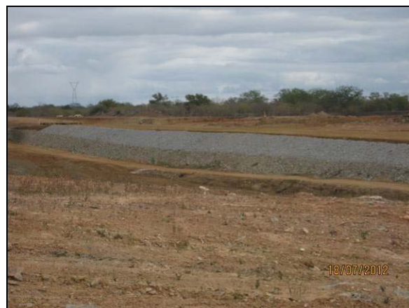
Foto 4.27.76. Implantação de enrocamento como método preventivo a processos erosivos, reservatório Cacimba Nova (jul/2012).
