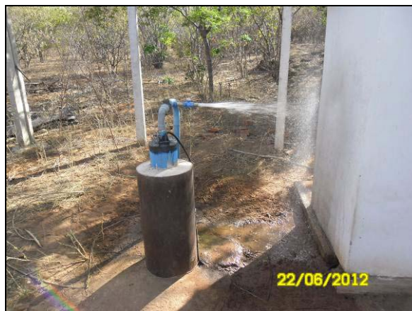
Foto 4.17.8. Poço tubular que abastece o reservatório de água, na comunidade quilombola Queimadas, Mirandiba – PE (jun/2012).
