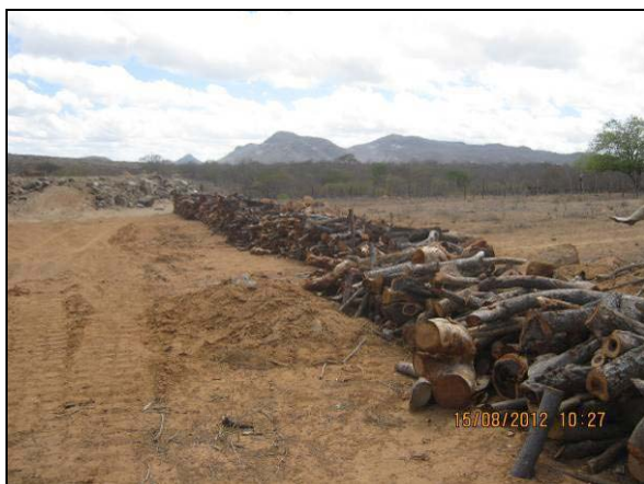
Foto 4.10.6. Acondicionamento de material lenhoso oriundo da supressão nos limites da área suprimida no WBS 1216 (ago/2012).
