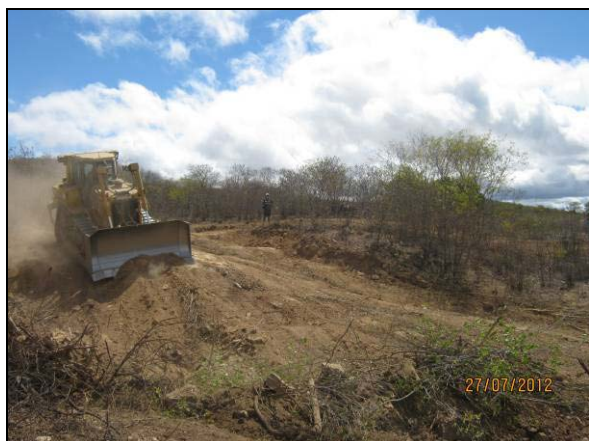
Foto 4.10.70. Remoção da camada de solo orgânico para armazenamento em área do WBS 2226 (jul/2012).
