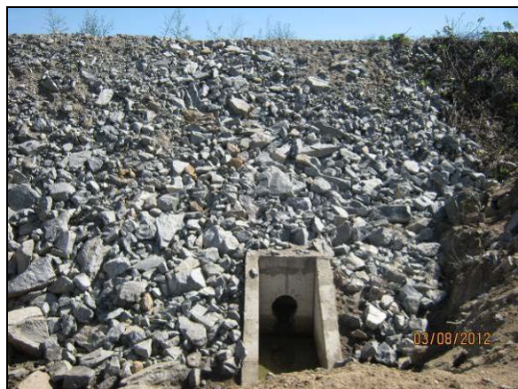
Foto 4.27.79. Enrocamento como medida preventiva a processos erosivos nos taludes marginais às saídas dos drenos e bueiros (ago/2012).
