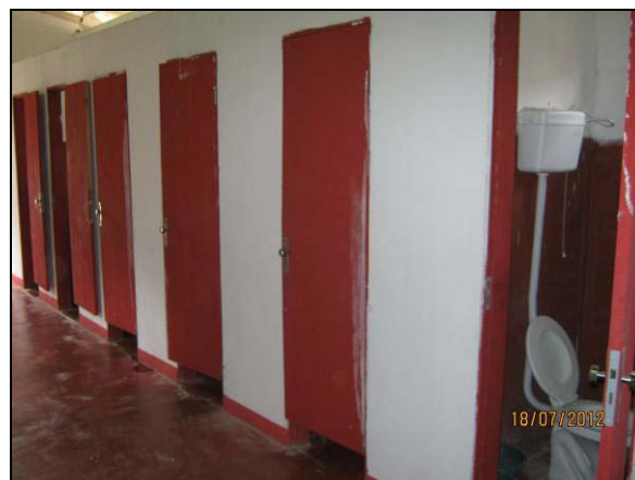
Foto 4.21.134. Banheiro disponível aos colaboradores nos alojamentos (jul/2012).
