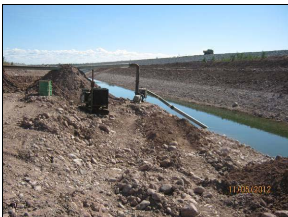
Foto 2.20.1. Esgotamento de água acumulada no eixo do canal do 3º BEC para evitar possível proliferação de vetores e hospedeiros de doenças (maio/2012).
