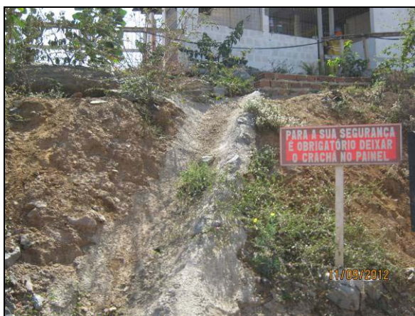
Foto 4.27.102. Canaleta para direcionamento de água pluvial como prevenção de processo erosivo no talude (set/2012).
