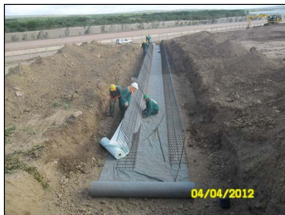
Foto 4.27.12. Construção de ecocalhas para drenagem de águas pluviais na área BF 04 CL no 3º BEC (abr/2012).
