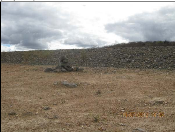
Foto 4.27.31. Talude enrocado com material granular compactado, influenciando na dissipação de águas pluviais (jul/2012).
