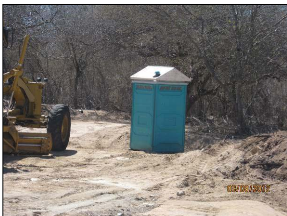
Foto 4.21.179. Banheiro químico disponibilizado na frente de serviço (ago/2012).
