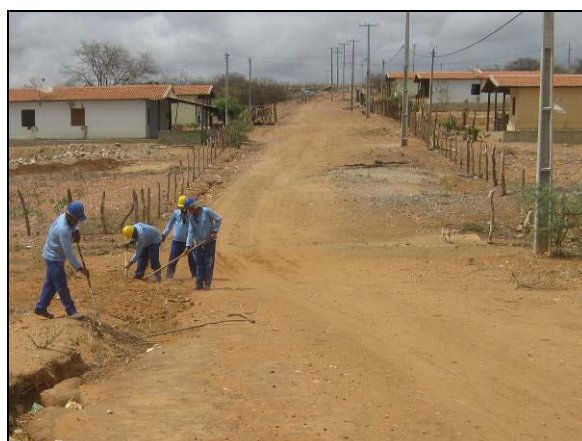
Foto 4.27.120. Lançamento de material em área de instabilidade no interior da VPR (set/2012).
