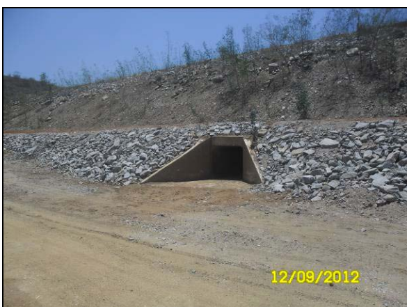
Foto 4.27.96. Medida de contenção de processos erosivos com enrocamento do talude em cabeceira de sistema de drenagem (set/2012).
