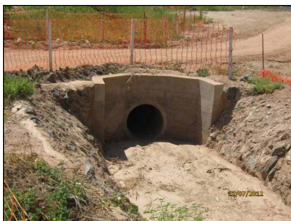
Foto 4.27.112. Enrocamento de sistema de drenagem sob via de acesso no emboque do túnel Cuncas I (jul/2012).
