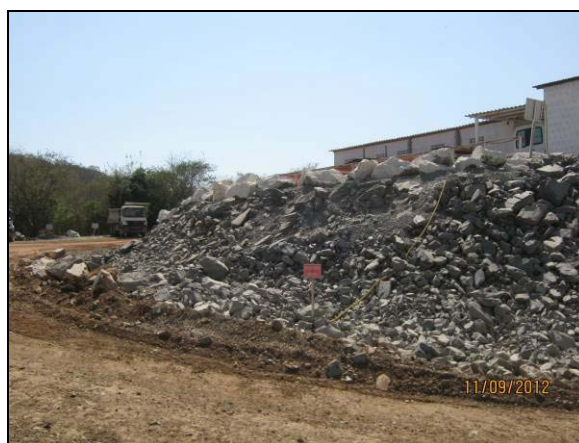
Foto 4.27.104. Enrocamento como método preventivo de erosão no talude do canteiro auxiliar da janela do túnel (set/2012).
