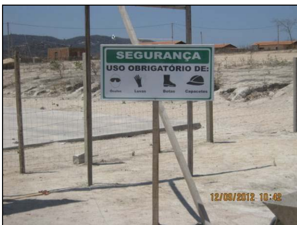
Foto 4.21.295. Divulgação do código de conduta do trabalhador nas frentes de obras (set/2012).
