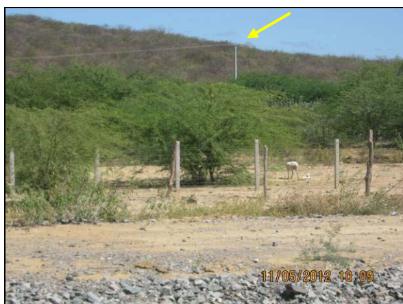
Foto 4.34.1. Rede elétrica da CELPE (EN-I-001) deslocada da faixa de domínio do canal de aproximação (maio/2012).
