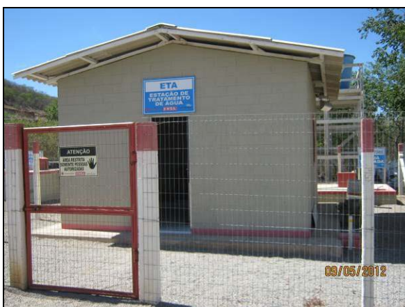
Foto 4.21.148. ETA instalada no canteiro de obras para garantia de água potável aos colaboradores (mai/2012).
