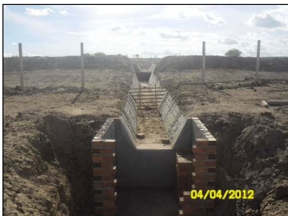
Foto 4.27.11. Construção de dissipadores de energia nas ecocalhas das bacias de captação de águas pluviais na área BF 04 CL no 3º BEC (abr/2012).
