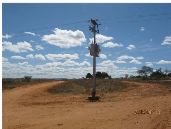
Foto 4.34.13. Rede elétrica (EN-II-068) aguardando solução no WBS 1232 (jun/2012).
