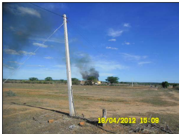
Foto 4.34.12. Rede elétrica COELCE (EN-I-146) no WBS 1224 (abr/2012).
