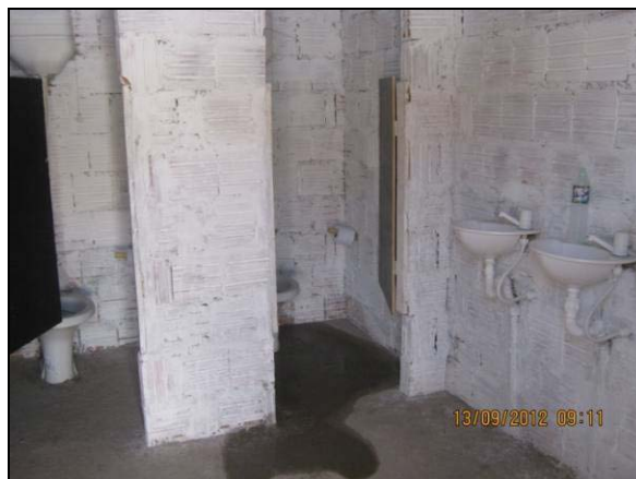
Foto 4.21.292. Banheiros disponíveis aos colaboradores de obras da VPR (set/2012)
