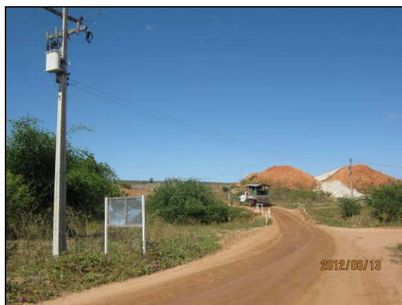
Foto 4.34.14. Rede elétrica (EN-II-058) aguardando solução no aqueduto Catingueira (jun/2012).
