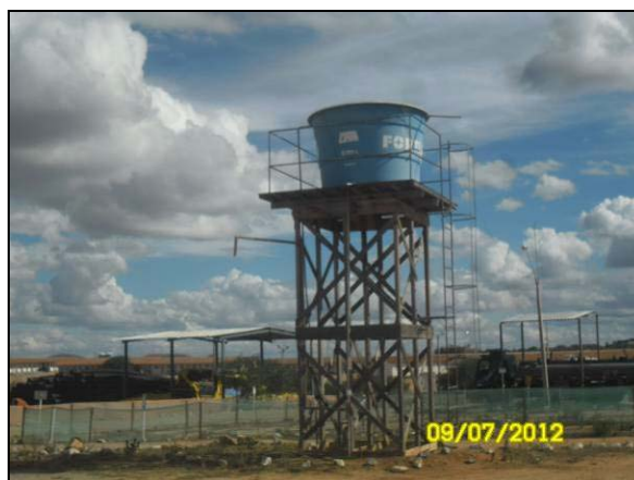
Foto 4.21.219. Armazenamento adequado da água para consumo dos colaboradores no canteiro de obras (jul/2012).
