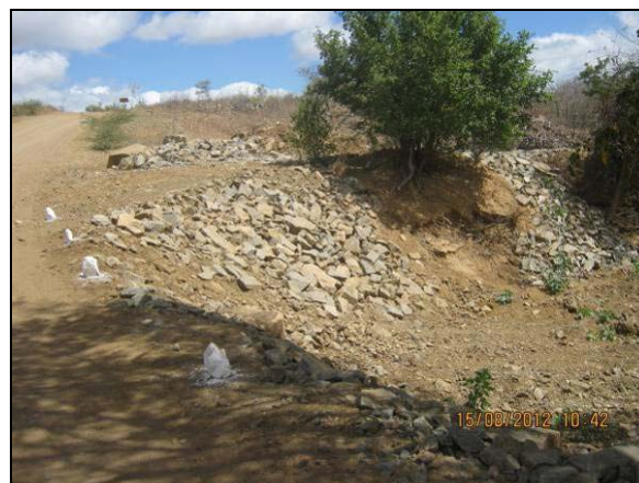
Foto 4.27.58. Material rochoso compactado em talude nas adjacências da via de acesso (ago/2012).
