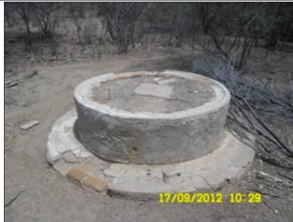
Foto 7 - Vista do poço Amazonas 04.
