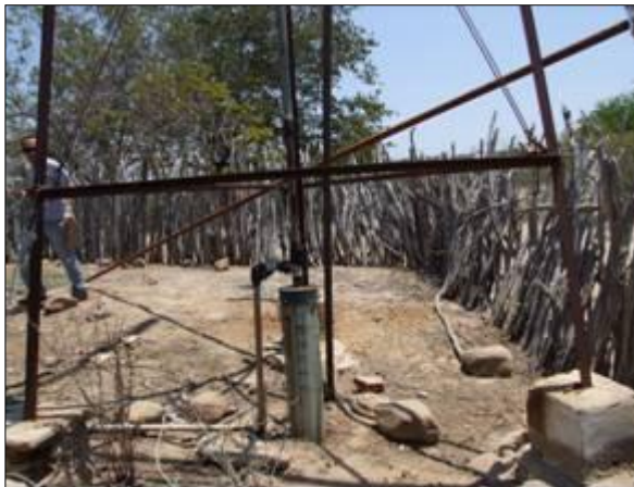
Foto 77 - Vista das instalações do poço sendo oxidadas pela ocorrência de sal na água.
