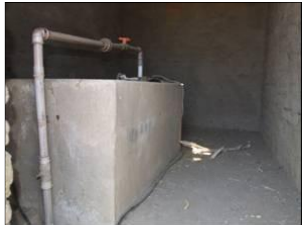
Foto 149 - Detalhe do interior da casa de bombas.
