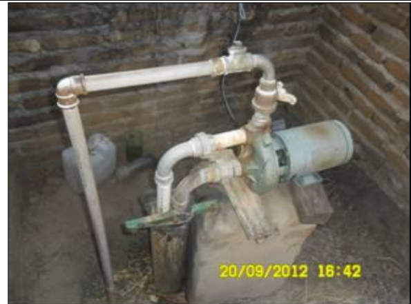
Foto 40 - Vista de detalhes do poço e o conjunto Moto Bamba.
