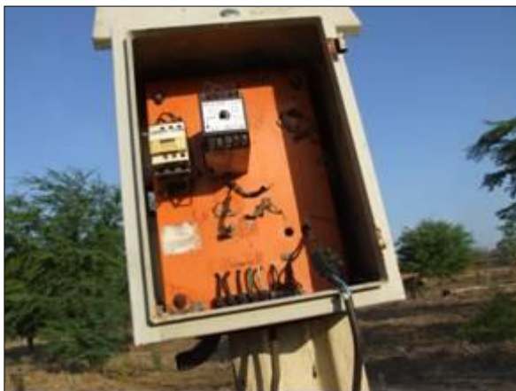
Foto 125 - Vista do quadro de comando, para a montante da planície de inundação do Rio intermitente Moxotó.
