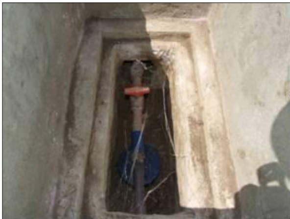
Foto 154 - Vista do detalhe do dispositivo de bombeamento a ar comprimido.
