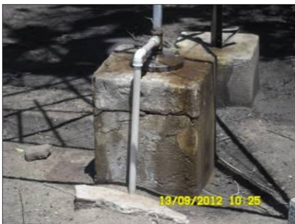
Foto 163 - Vista do poço na planície de inundação do talvegue intermitente, que drena o Açude Poções.
