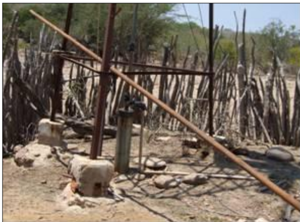
Foto 79 - Vista do poço sendo oxidado pela existência do sal.
