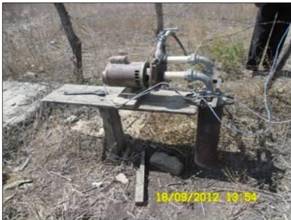
Foto 33 - Vista de detalhes do poço e o conjunto Moto Bamba.
