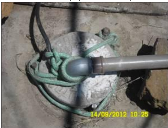
Foto 108 - Detalhe do poço localizado no ponto 39.
