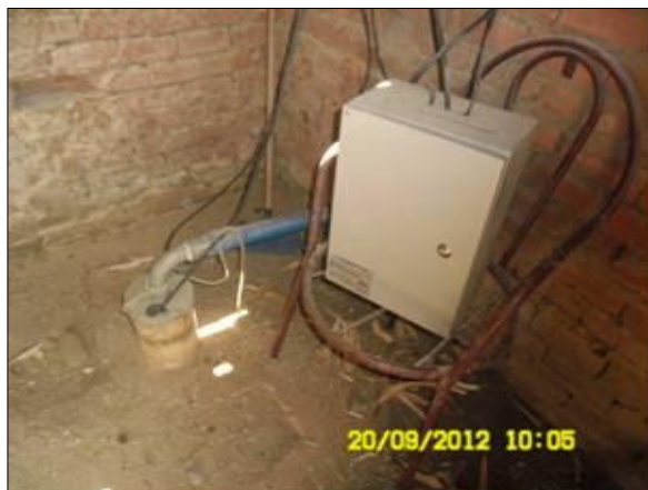
Foto 44 - Vista de detalhes do Poço e Quadro de Comando.
