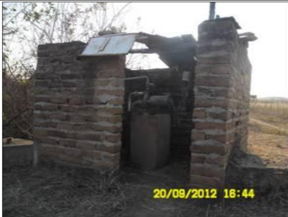
Foto 39 - Vista de detalhes do abrigo do poço e o conjunto Moto Bamba.
