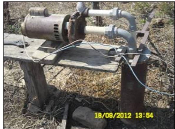
Foto 34 - Detalhe do poço e o conjunto moto bomba.
