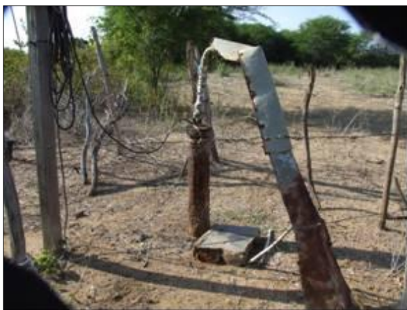
Foto 129 - Vista do poço para a ME, em avançado estado de oxidação devido a alta concentração de sal existente em sua água.
