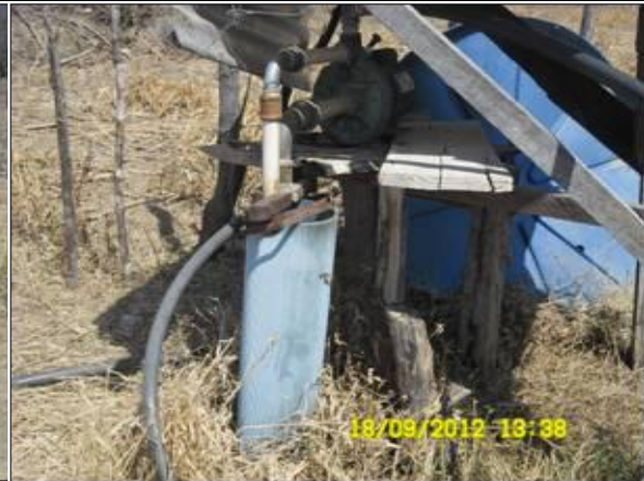
Foto 36 - Detalhe do poço e o conjunto Moto Bamba.
