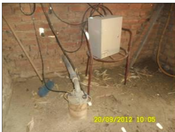
Foto 46 - Vista de detalhes do Poço e Quadro de Comando.
