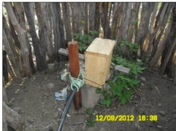
Foto 112 - Vista do poço instalado e em funcionamento
