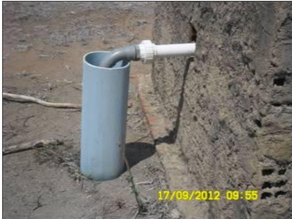
Foto 4 - Detalhe do poço tubular profundo localizado no Ponto 03.
