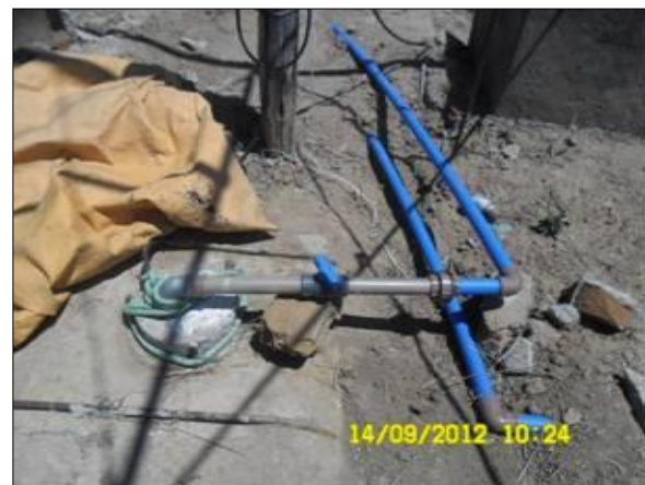
Foto 107 - Detalhe do poço localizado no ponto 39.
