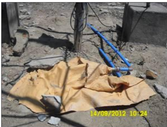
Foto 106 - Detalhe do poço localizado no ponto 39.
