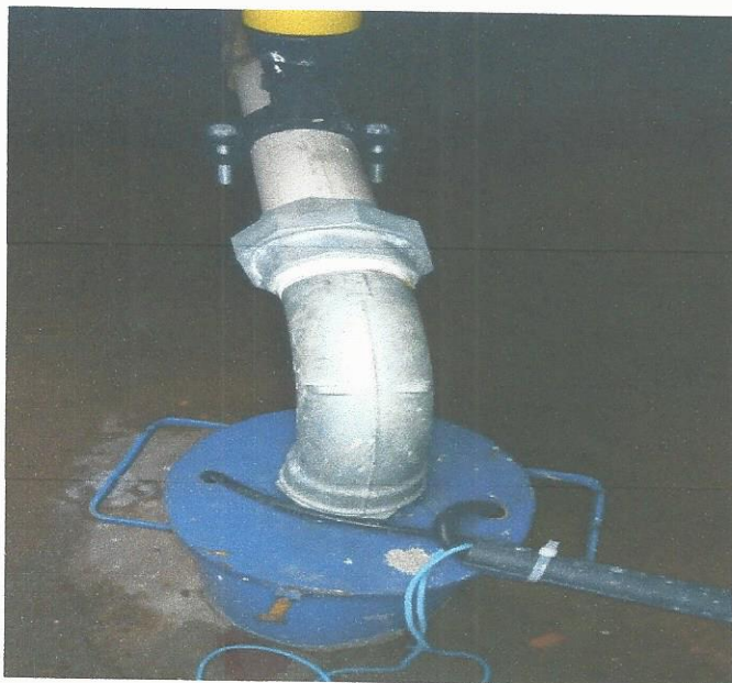
Tampa da boca do Poço Tubular Profundo
