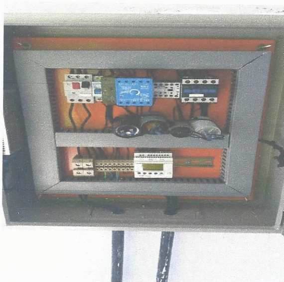
Quadro de Comando da eletrobomba
