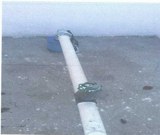
Poço Tubular Profundo instalado em abrigo
