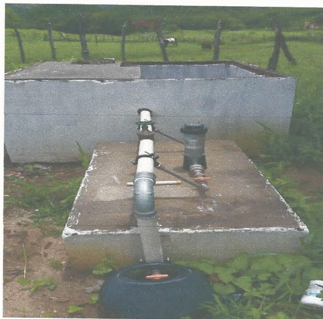
Dosador de Cloro na linha adutora – saída do poço
