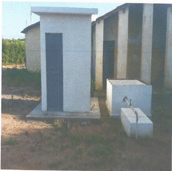
Abrigo do Quadro de Comando
