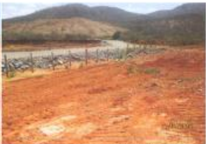
Recuperação e conformização dos talude após finalizar a extração de argila com indícios de brotas de vegetação nativa em estágio inicial;
