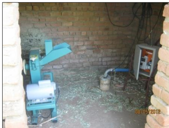
Foto 10.215. Instalações do poço profundo. Arruídos. Cajazeiras – PB (maio/2012).
