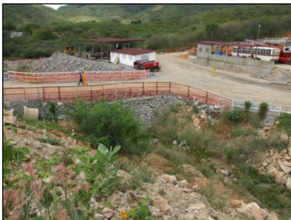
Foto 10.156. Lateral esquerda do desemboque do Túnel Cuncas II, vista do Córrego Caiçara Parcialmente obstruído. P50, (maio/2012).
