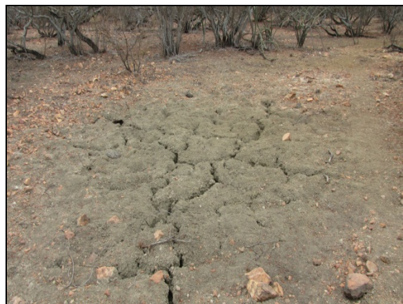
Foto 10.61. Fendas formadas no solo de lagoa natural intermitente, Cabrobó - PE (out/2011).
