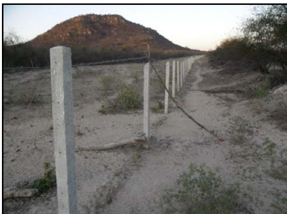
Foto 8.13. Cerca avariada próximo ao reservatório Tucutu, Cabrobó - PE (UTMSAD69 24S 447031/9065021) (out/2011).
