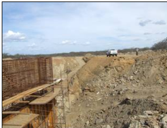
Foto 10.4. Vista para montante do canal de condução do descarregador de fundo (out/2011).
