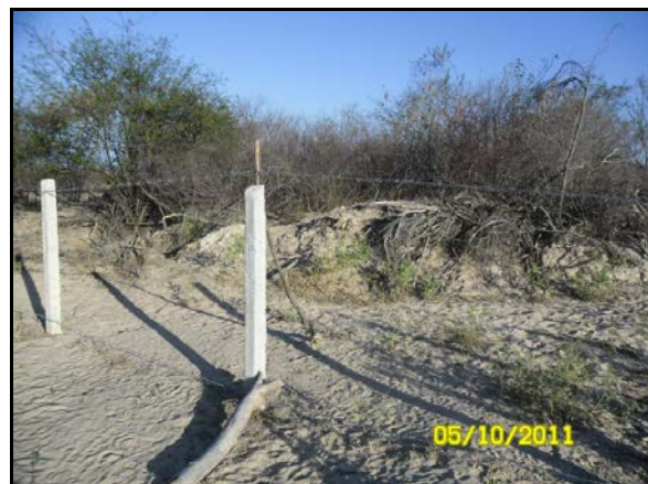
Foto 8.14. Cerca avariada próximo ao reservatório Tucutu, Cabrobó - PE (UTMSAD69 24S 447031/ 9065021) (out/2011).
