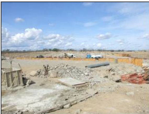
Foto 10.7. Vista do vertedouro sendo construído na ombreira esquerda da barragem Tucutu (out/2011).
