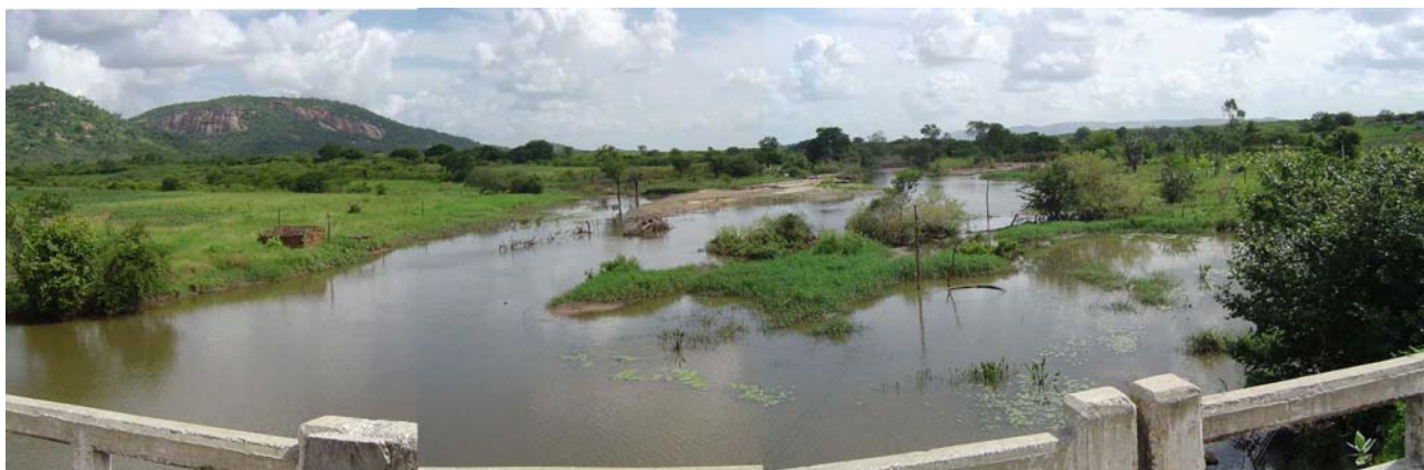
FOTO 6.2.6-8 - PONTE DA RODOVIA PB-405 SOBRE O RIACHO VACA MORTA – VISTA PARA JUSANTE
