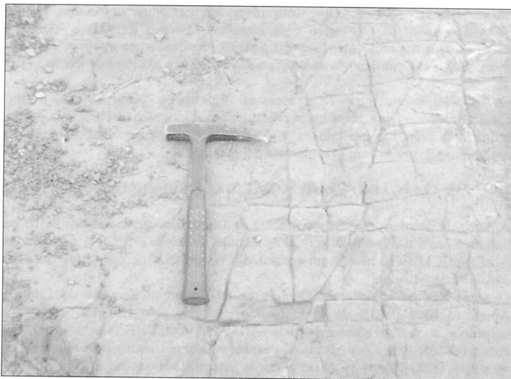
FOTO 3-5 - Argilito da Unidade II do Grupo Beneficente alterado e fraturado.
