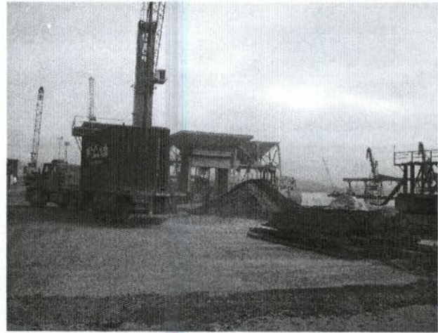
Figura 8: Levantamento de particulados devido à passagem de caminhões na área de ampliação do berço 301
