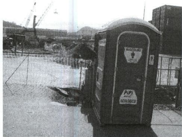
Figura 10: Banheiro químico utilizado pelos trabalhadores na ampliação do berço
