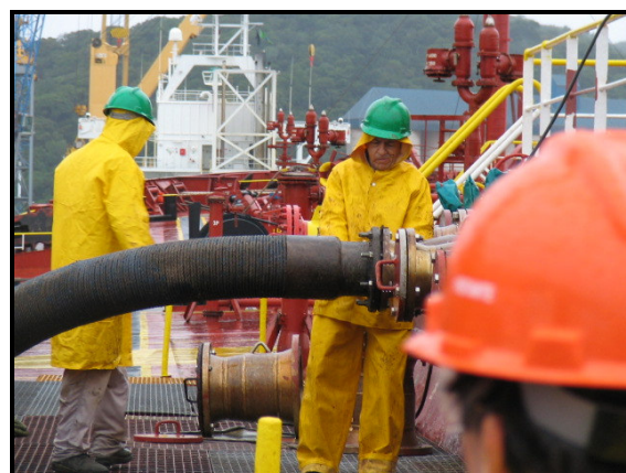
Figura 9.40: Acoplamento do mangote para o carregamento de óleo de soja nos tanques do navio
