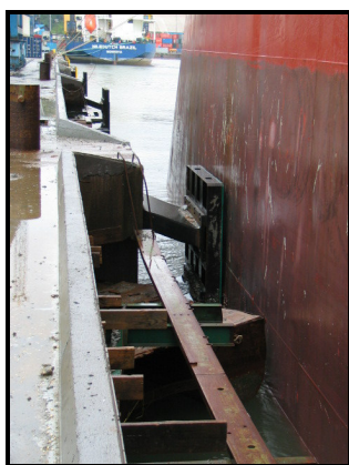
Figura 9.27: Exemplo de defesa em utilização, instalada em berço de atracação
