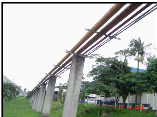
Figura 9.36: Dutos de transporte de óleo
