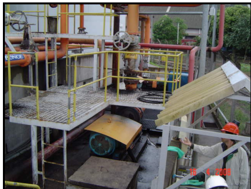
Figura 9.34: Estação de Bombeamento
