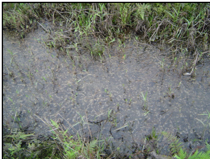
Figura 6.53: Vista parcial do acúmulo de água na vala de drenagem devido à baixa declividade (23/10/08).
