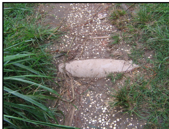
Figura 5.105: Tubulação de esgoto desenterrada, confeccionada em concreto, observada na Comunidade Bela Vista.
