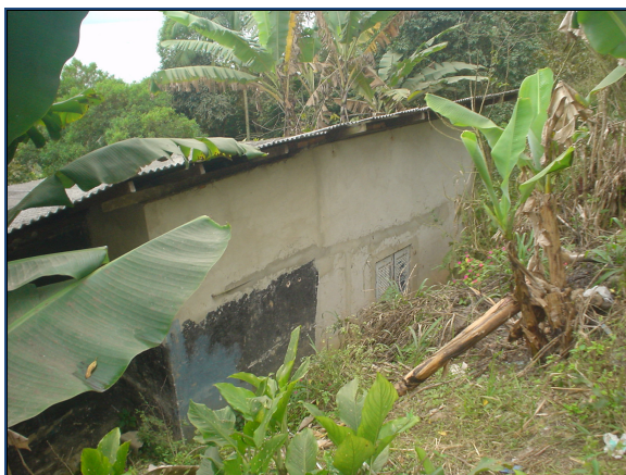
Figura 5.6: Área A. Edificação entre transectos A e B, em corte no barranco. (Alves, 2007)
