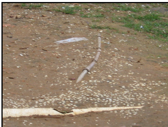
Figura 5.104: Tubulações de esgoto desenterradas, confeccionadas em manilha cerâmica e PVC (danificada) observadas na Comunidade Bela Vista.
