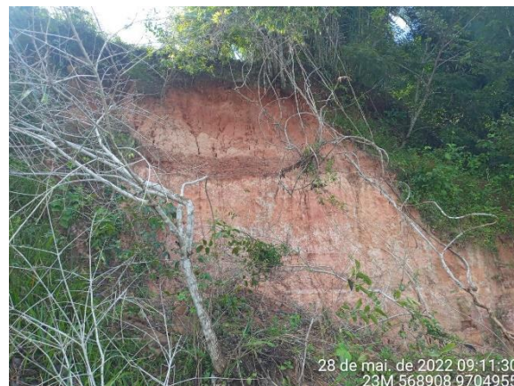
Foto 23 - Processos erosivos com deslocamento de massa visualizado em campo.
