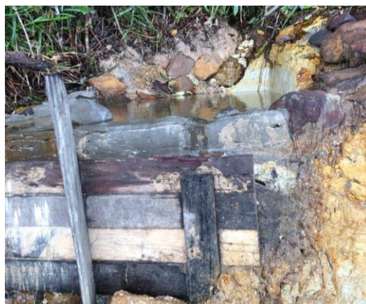
Foto 25 – Afloramento de água na AID do empreendimento.
