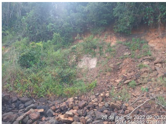
Foto 22 – Processos erosivos com deslocamento de massa visualizado em campo.
