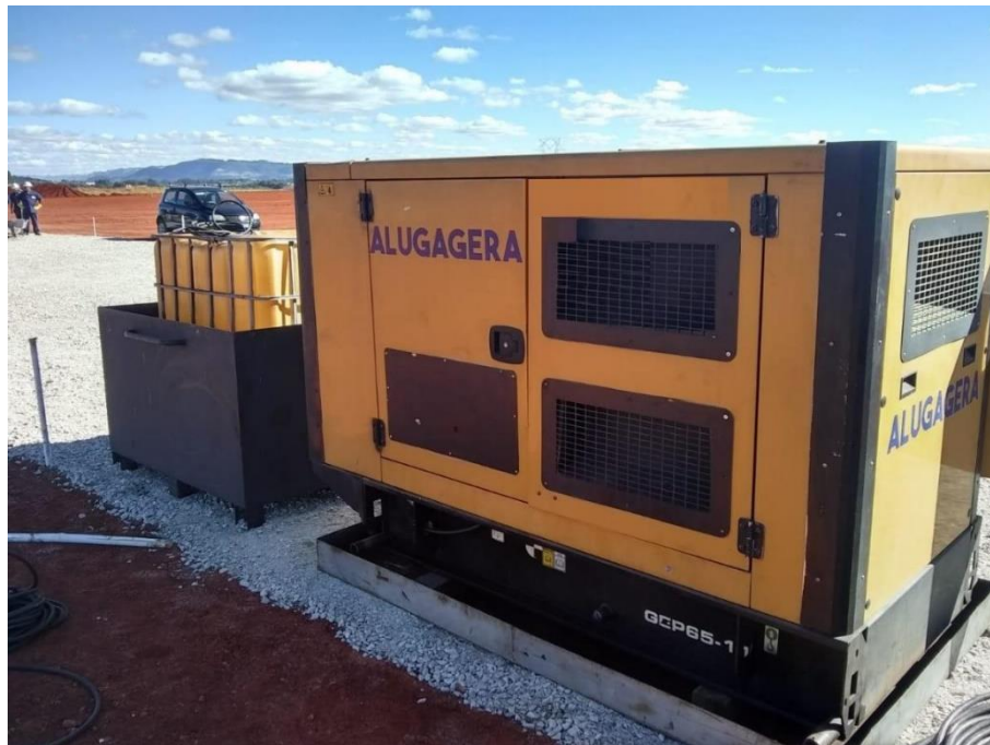
Figura 40 - Gerador de energia a diesel. Fonte: AlugaGera.
