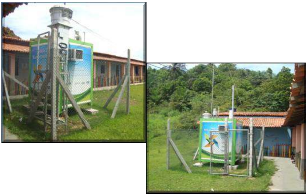
Figura 58: Estação de monitoramento localizada em Bananeira (Ilha de Maré)
