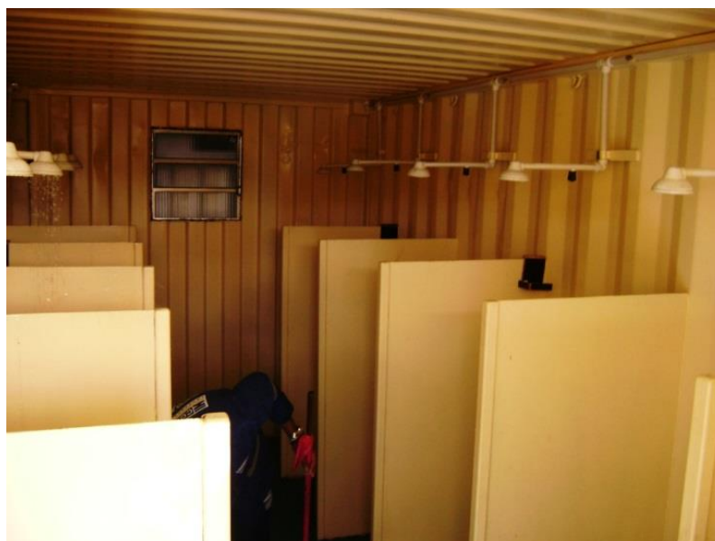
Interior dos Contêineres Sanitários / Vestiário
