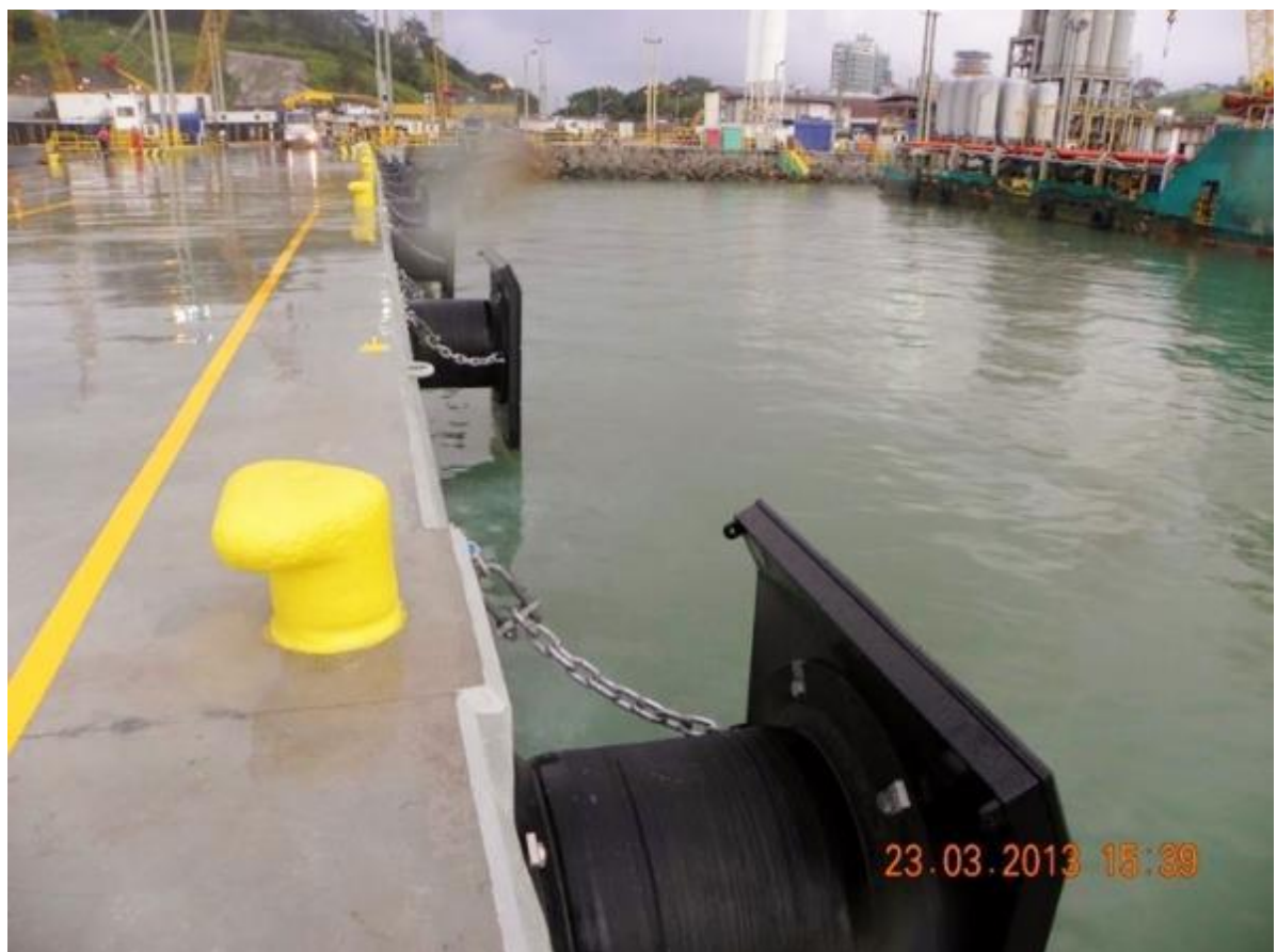
Exemplo de Píer com Defensas de Atracação Instaladas
