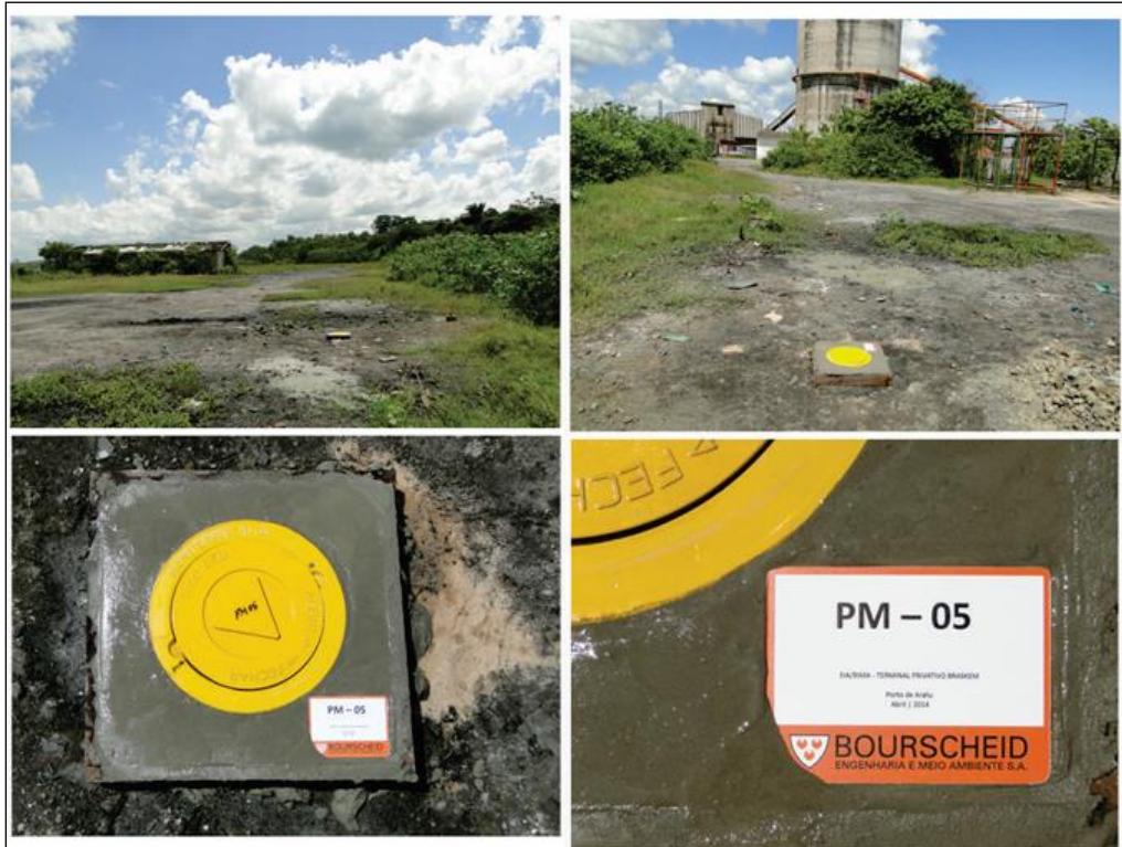
Figura 8.1-57. Vista para o entorno do poço PM-05 instalado próximo ao TGS e selo sanitário devidamente instalado (Fonte: Bourscheid, 2014).
