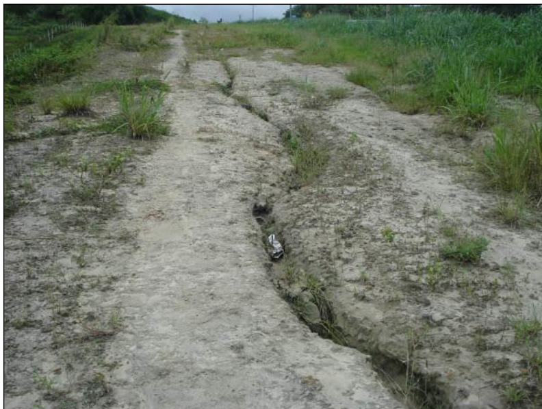
Figura 8.1-46. Sulcos erosivos junto a margem de rodovia (Fonte: Bourscheid, 2014).
