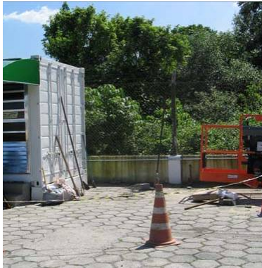
Foto 01 - Local de instalação do PM-01
