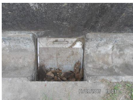
Figura 9: Grelha para retenção de materiais na saída de lançamento de efluentes.
