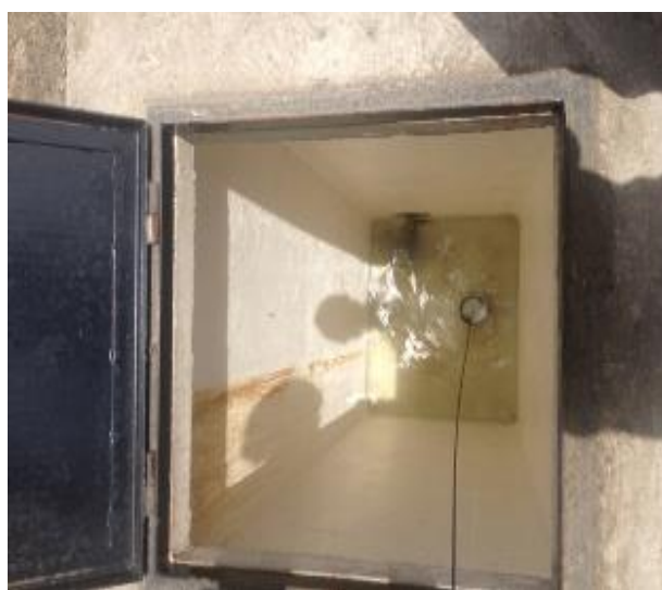
Figura 12: Aspecto da água no momento da coleta no Ponto 2
