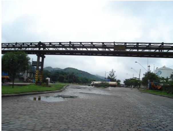
Foto 9.5-38 Rotatória da Alemoa: cruzamentos de dutos com o sistema viário
