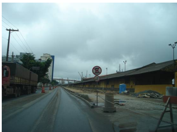
Foto 9.5-27 Trecho da Avenida Xavier da Silveira que se encontra em obras (Avenida Perimetral)
