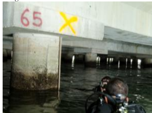
Figura 2.8.2.3.5-10 – Pouca altura entre o cais e o nível da água.
