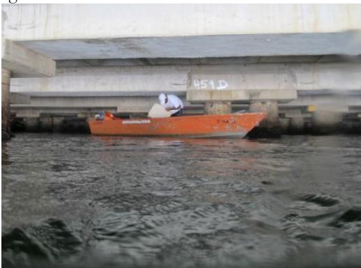
Figura 2.8.2.3.5-9 – Pouca altura entre o cais e o nível da água.
