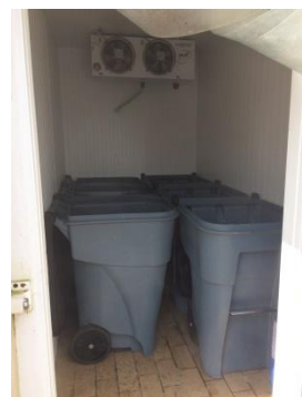
Figura 2.5.5.5-4 – Visão interna da Câmara Fria localizada na área não alfandegada anexa ao restaurante.
