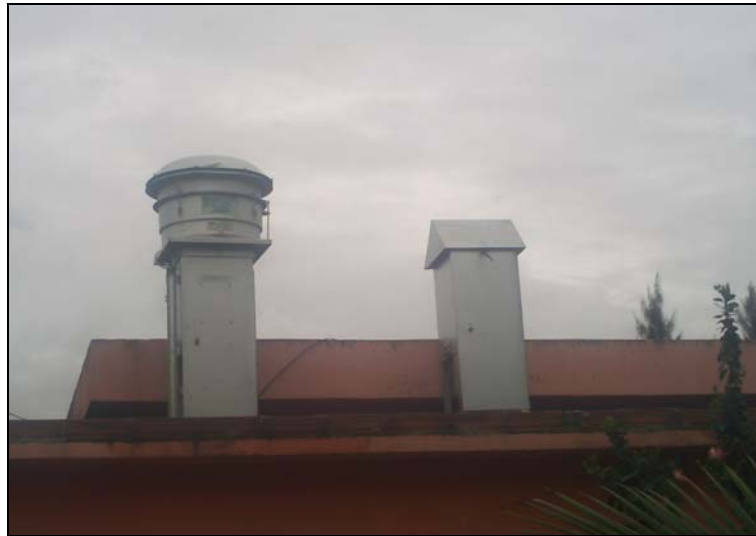
Figura 5.1.2.1-7: Estação Praia das Neves. Visualizar os amostradores AGV-PM 10 e AGV-PTS instalados.
