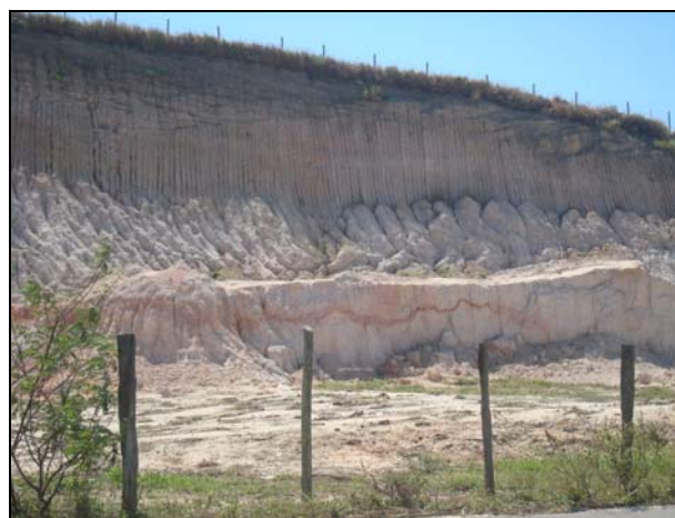
Figura 5.1.4-21: Processos erosivos de cunho linear (pequenos sulcos) instalados em vertente de Tabuleiro Costeiro reafeiçoada (corte), provavelmente para fins de caixa de empréstimo.
