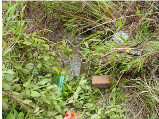
Figura 5.1.61: Vista da parte externa do poço de monitoramento PM-5.
