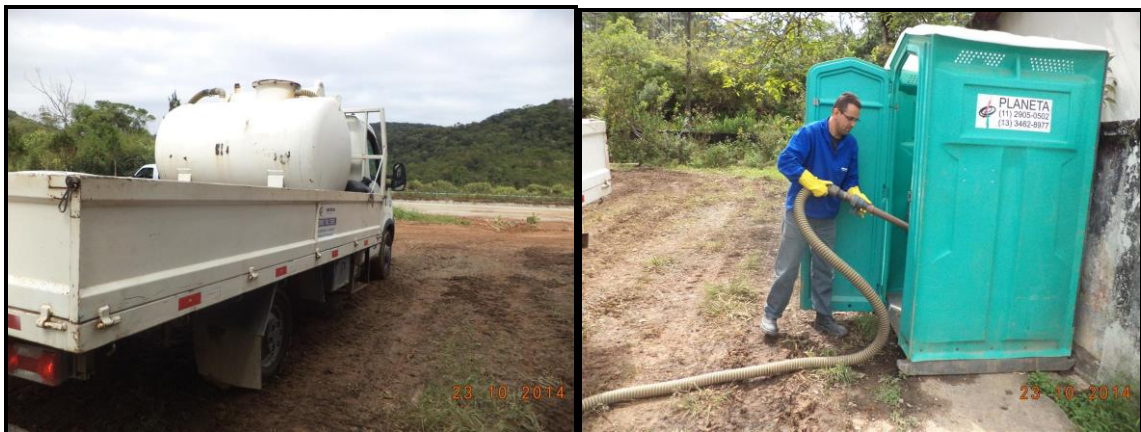
Figura 8 - Exemplo de procedimento de limpeza de banheiros químicos utilizados em canteiros de obra e coleta do efluente por caminhão-vácuo.
