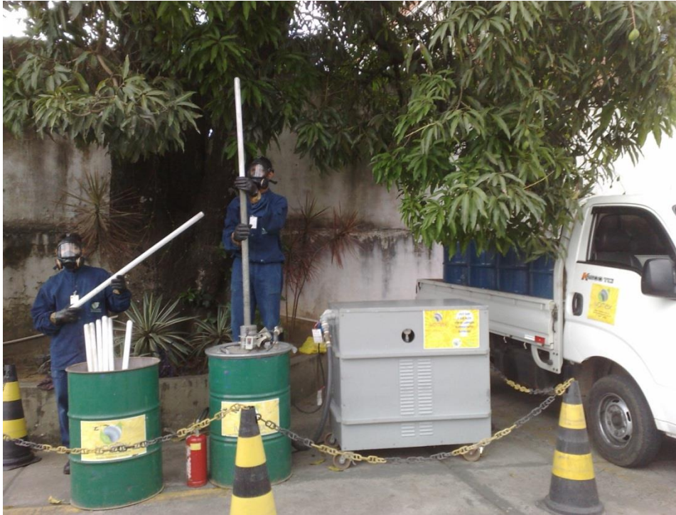
Fotografia 29: Foto registrada durante o processo de descontaminação in loco de lâmpadas usadas em uma das empresas contratantes dos serviços da IVOMAX.
