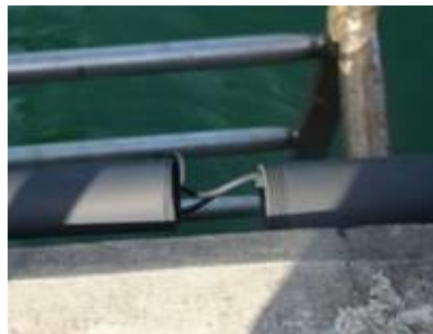
Figura 9.11.1-1 - Abertura em eletroduto no píer.
