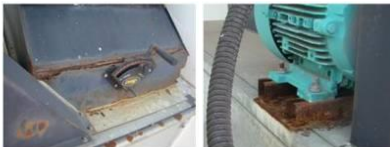
Figura 9.11.1-5 – Adiantado processo de corrosão no dumper do exaustor.
