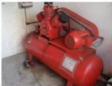
Figura 9.11.2-1 – Compressor de ar com reservatório acoplado.
