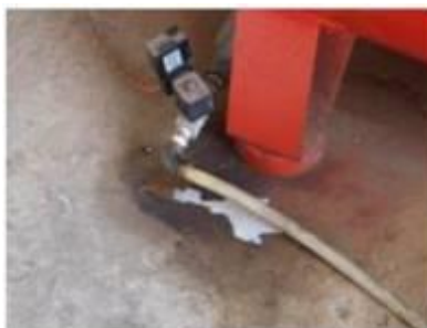
Figura 9.11.1-4 – Vazamento no dreno automático do reservatório de ar comprimido do compressor.
