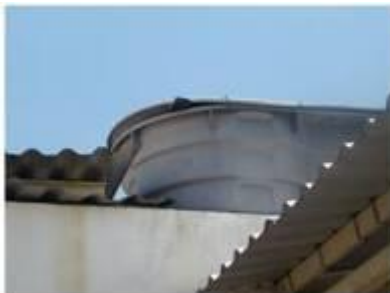
Figura 8.7.3-2 – Caixa d'água com tampa calçada.
