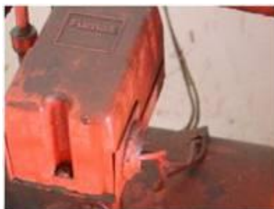
Figura 9.11.1-2 – Situação da fiação elétrica no compressor de ar do PDI.
