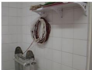
Figura 9.11.1-3 – Fiação improvisada na cozinha.
