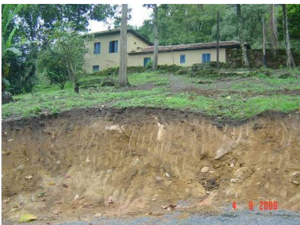
Figura 4.1.4.1.2 - 9: Corte de encosta próxima às instalações do sítio implantado no sopé do Morro das Neves na porção central da ADA. Exposição de blocos de rocha distribuídos aleatoriamente em meio à matriz areno-silto-argilosa marrom-clara.
