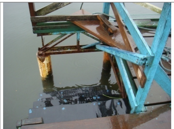
Figura 7.3.3.9 - 28: Detalhe da estrutura bastante enferrujada
