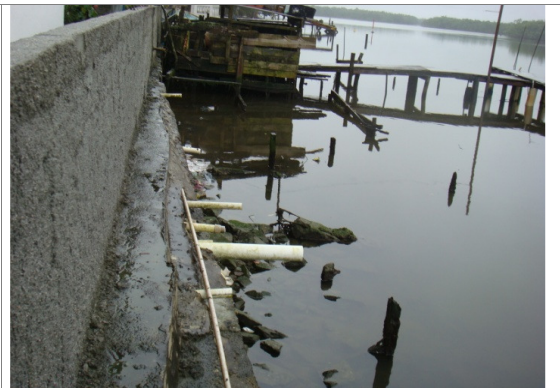
Figura 7.3.3.9 - 13: Situação dos encanamentos de esgotos, lançados diretamente nas águas do estuário.
