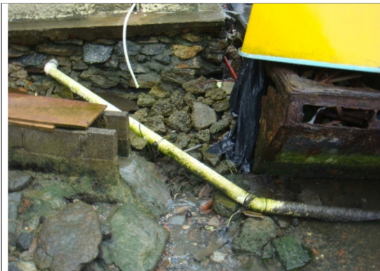
Figura 7.3.3.9 - 12: Situação do encanamento de esgotos.
