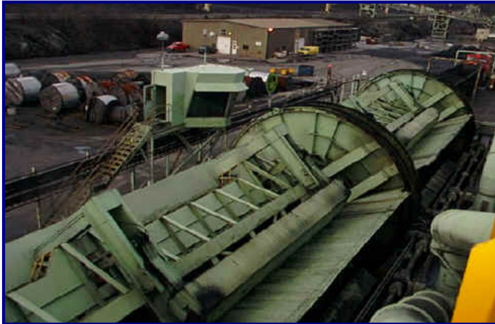
Foto 4.4 - 7- "Car Dumper" (equipamento que inverte vagão ferroviário para descarga de graneis sólidos em moega)
