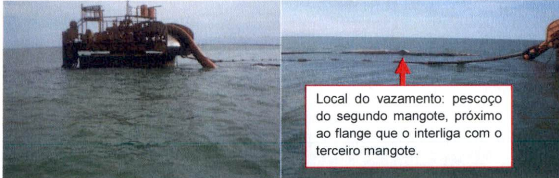
Figura 1 - PONTO DO VAZAMENTO (05/10/2009)
