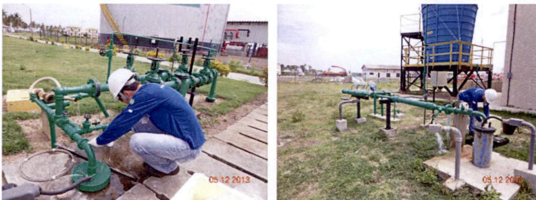
Figura 4-1: Coleta de água subterrânea nos poços Artesiano, à esquerda, e Tubular Profundo, à direita.
