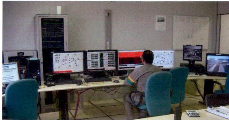
Figura 08 – Estação de Supervisão e Controle (ESC)
