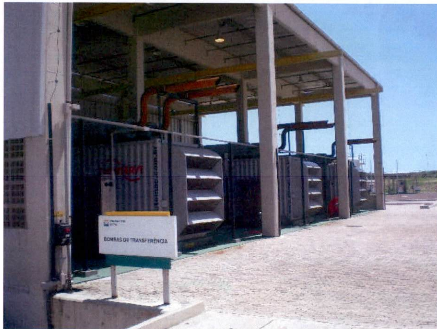
Figura 06 – Bombas de Transferência principais
