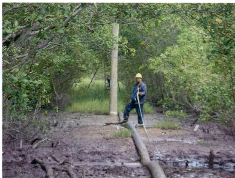
Fig. 03 – Locando os pontos de sondagem vendo-se o tripé ao fundo e à frente, um dos postes da rede de transmissão existente.
