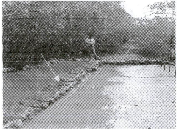
Foto 02: Estrutura de contenção do fluido vazado.
