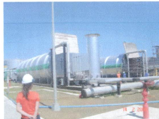
Unidade de geração de vapor.
