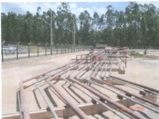
Tubovias para interligação de poços de petróleo ao ponto de coleta FAL 40.
