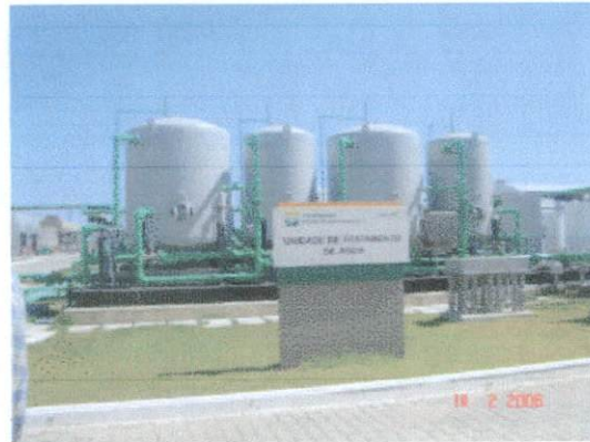
Unidade de tratamento de água.
