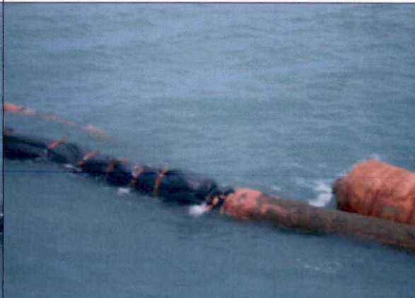
Foto - 38 - Vista da manutenção para conter o vazamento.
