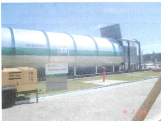
Unidade de geração de vapor.
