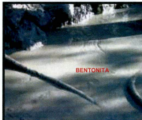
FOTO 4 : DETALHE DO FLUIDO DE PERFURAÇÃO VAZADO
