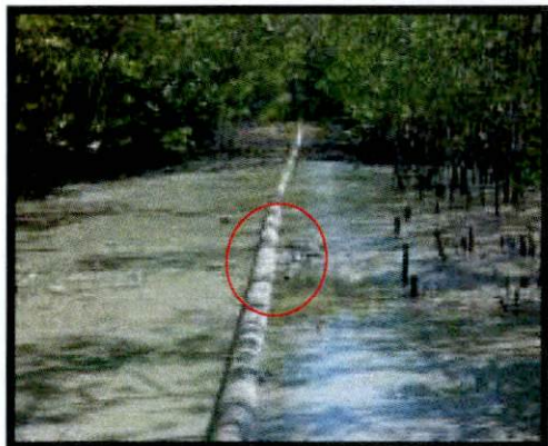
FOTO 1 : VISTA DA ÁREA CENTRAL DO VAZAMENTO
