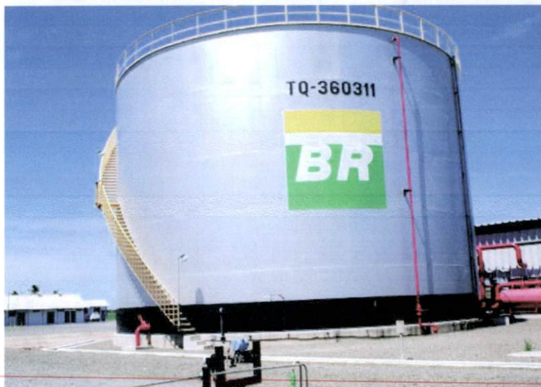
Tanque de água para combate a incêndio
