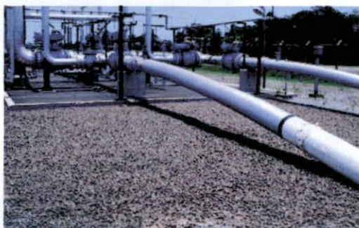
Scraper de entrada de petróleo
