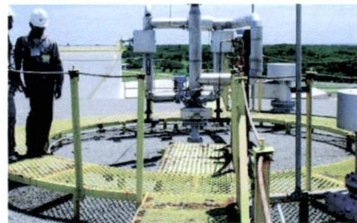
Sistema de remoção de H 2 S
