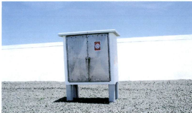
Armário com mangueira de combate a incêndio
