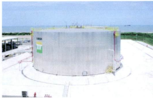
Tanque de petróleo pesado
