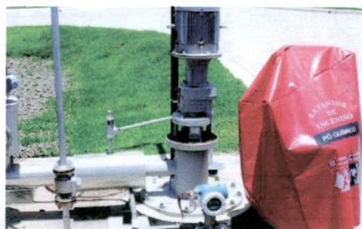
Bombeamento de água oleosa do scraper
