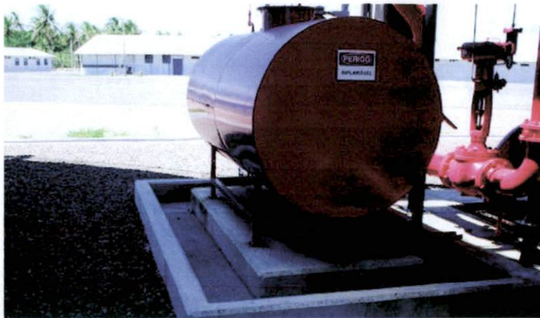
Tanque de diesel da bomba de combate a incêndio
