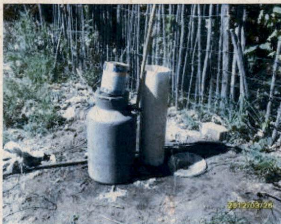
Ilustração 9. Captação de água de poço
